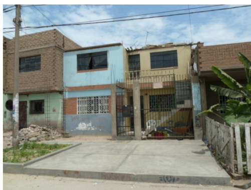
Figura 80. Lotes con presencia de humedad en su cimentación debido a las áreas verdes.
