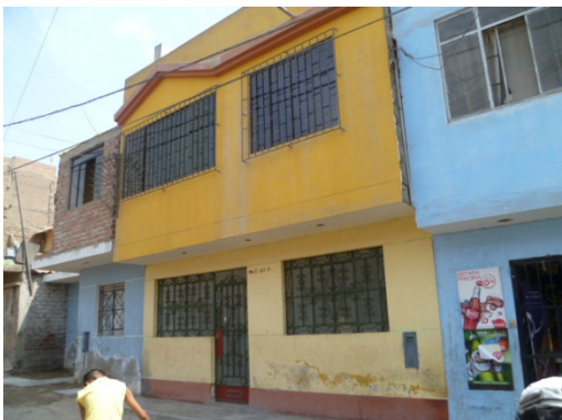
Figura 92. Vista de vivienda con presencia de humedad en la base-sector 30.
