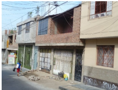
Figura 108. Vivienda informal de 2 niveles de mampostería confinada, carente de viga collar, con techo de calamina y muros de ladrillo pandereta.
