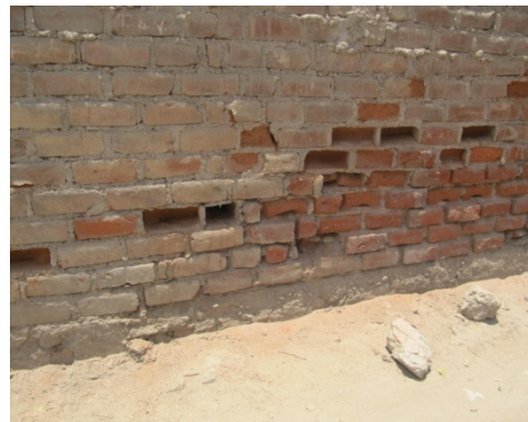
Figura 29. Humedad en las viviendas sector 06.
