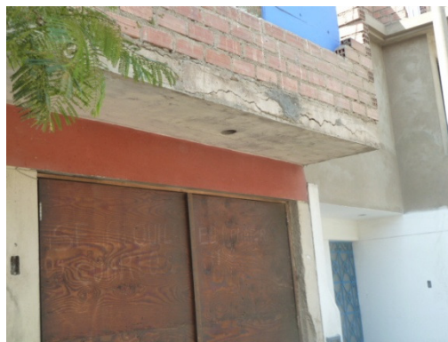
Figura 134. Fisura horizontal en la losa
