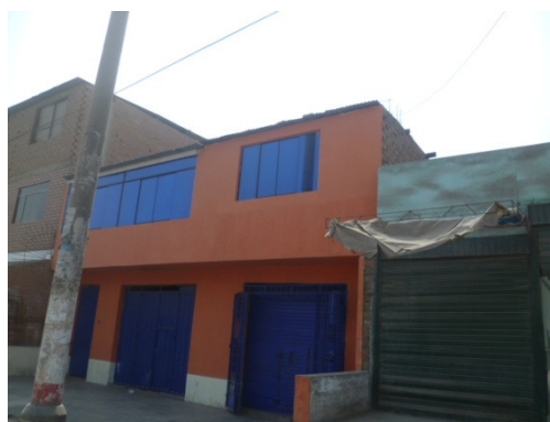
Figura 157. Viviendas sin diafragma rígido en el techo
