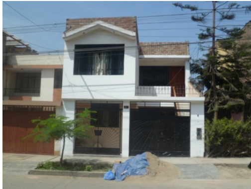
Figura 30. Vivienda informal de 2 niveles de albañilería confinada con techo de losa aligerada y muros de ladrillo pandereta sector 07.
