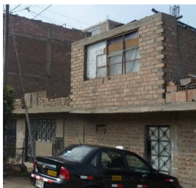
Figura 55. Construcción informal de mampostería
