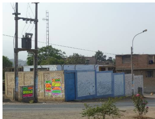
Figura 270. Sub estación eléctrica.
