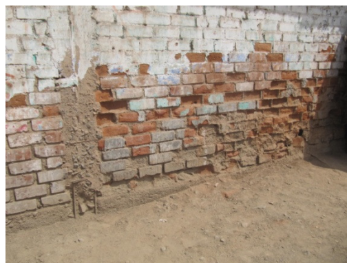
Figura 117. Presencia de salitre-sector 38.
