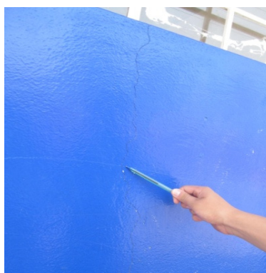
Figura 120. Fisura en edificación
