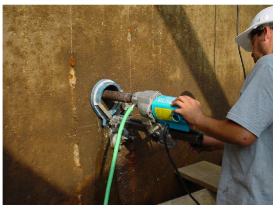
Figura 550. Extracción de testigos de concreto endurecido. Obsérvese la corrosión en el muro
