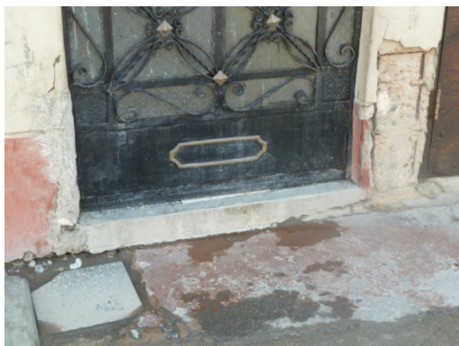
Figura 133. Desprendimiento de tarrajeo en la columna
