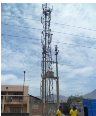
Figura 413. Torre de telecomunicaciones.
