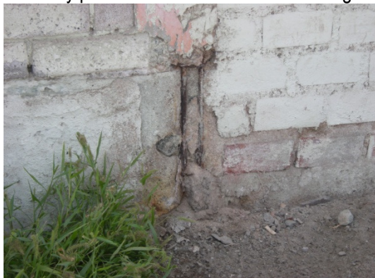
Figura 128. Presencia de sales, que producen la corrosión y deterioro del concreto y acero de construcción.
