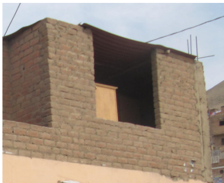
Figura 62. Ausencia de columnas de amarre-sector20.
