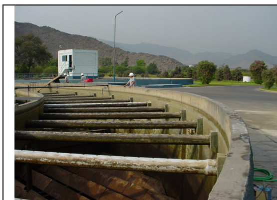
Figura 552. Vista de un decantador
