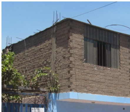
Figura 28. Ausencia de viga collar-sector 06.
