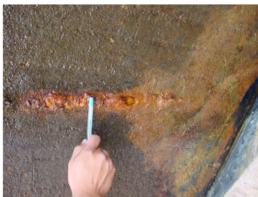
Figura 551. Corrosión del refuerzo en los muros de los decantadores.
