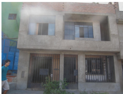
Figura 118. Vivienda de albañilería confinada de 2 niveles en sector 39.
