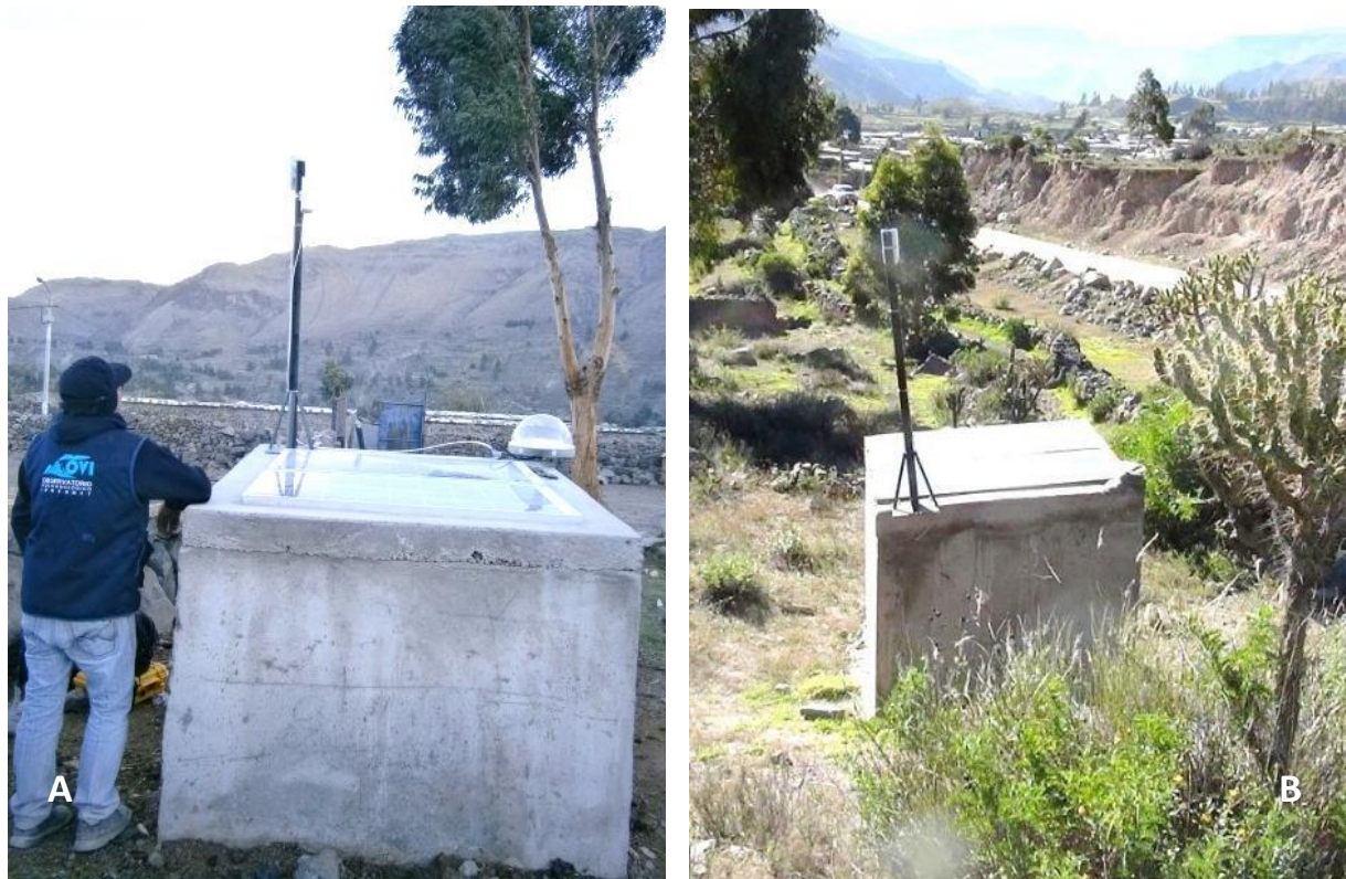
Figura 5. Estaciones GPS de monitoreo permanente con sistema de trasmisión de datos en tiempo casi real mediante WI-FI, A). Estación GPS MADM, B). Estación GPS MAD1
