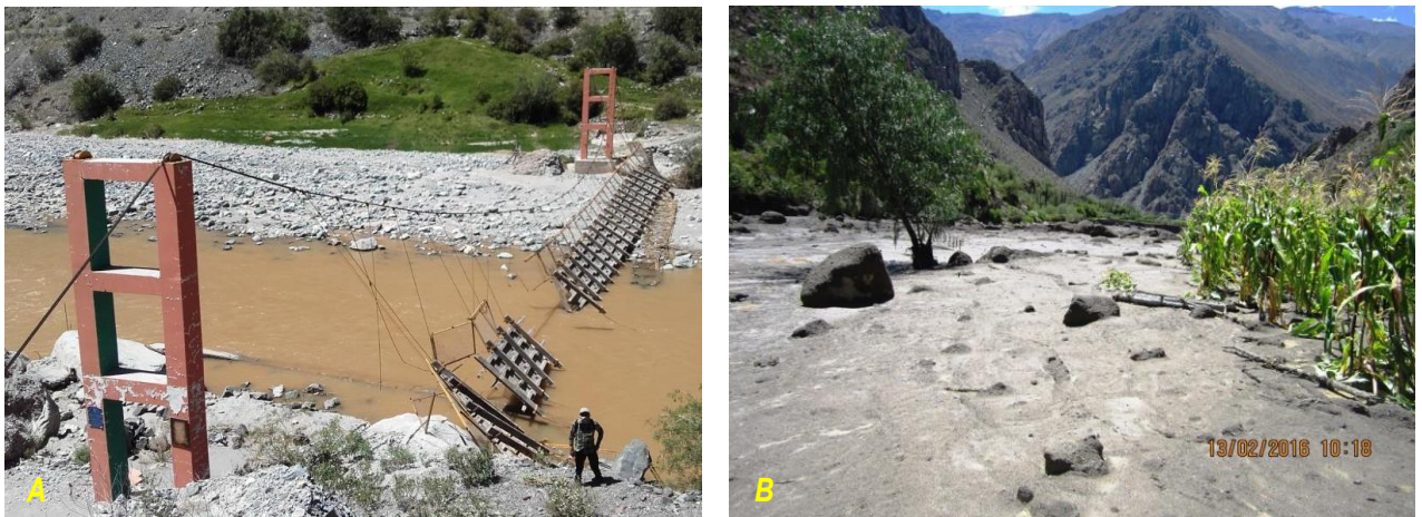
Figura 13. A: Puente peatonal de cerca de 50 m de largo destruido durante el desembalse de la laguna formada en el río Tambo el día 13 de febrero 2016; B: Terrenos de cultivo destruidos por el lahar del 12 de febrero, en el sector Huarina, cerca de la confluencia de los ríos Volcanmayo-Ubinas y Anascapa.
