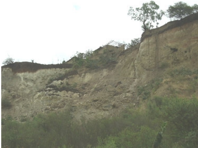
Viviendas ubicadas en la escarpa del deslizamiento activo de Choropampa, donde continúan los asentamientos de terreno.
