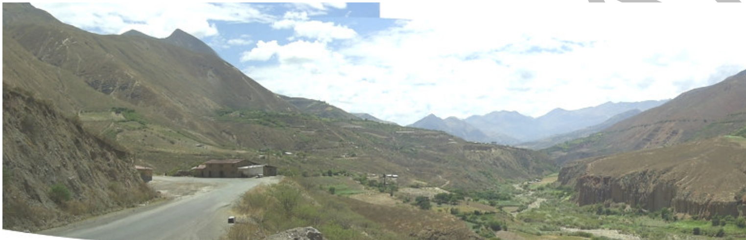
Vista panorámica del sector de Huana Huana, carretera atraviesa un deslizamiento antiguo reactivado, pérdida de plataforma de carretera.
