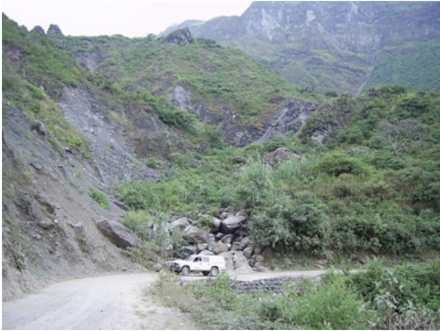
Sector el Palto, en la carretera San Pablo-San Miguel de Pallaquez, afectado por huaycos y deslizamiento en la plataforma de carretera.
