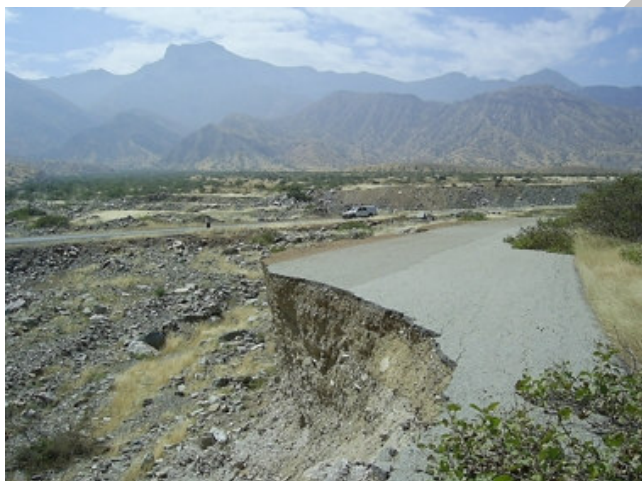
Quebrada Monte Grande, discurren huaycos de gran magnitud que cortan tramos de carretera a Cajamarca km 44+000
