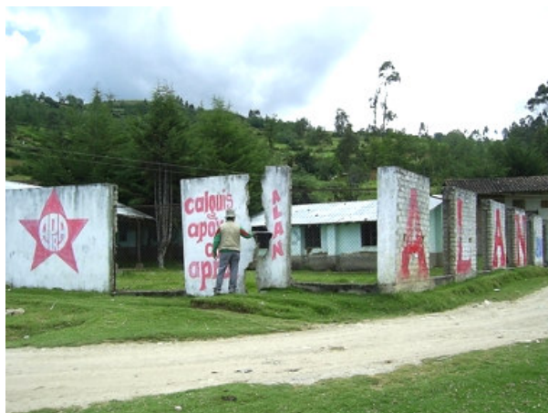
Vista del estado en que quedo la posta medica del poblado de Calquis que fue afectado por el deslizamiento-flujo anterior, San miguel de Pallaquez.
