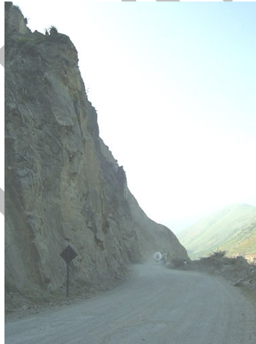
Km 115 de la carretera ha Cajamarca, se producen derrumbes desde el talud superior, perdida de asfalto.
