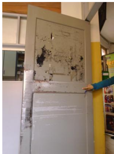
Foto 21: las puertas de acceso al Centro Quirúrgico están sumamente deterioradas y no ofrecen seguridad.
