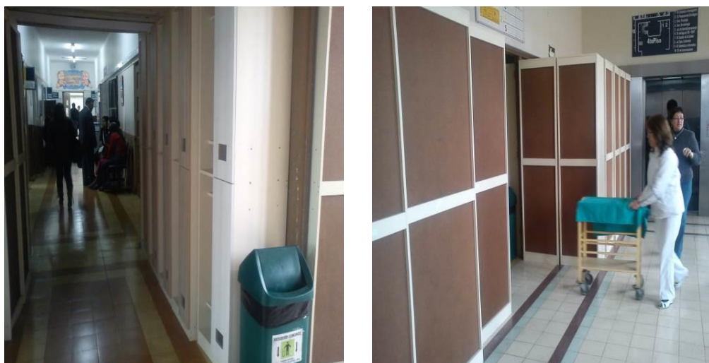
Foto 9. Ruta de evacuación de la parte administrativa y asistencial del cuarto piso ocupada por casilleros.
