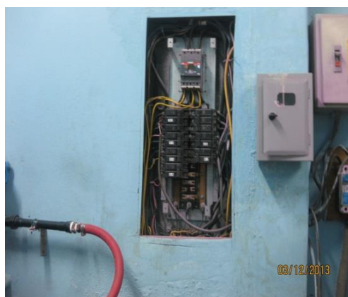
Foto 57: Tablero eléctrico en alto riesgo, fuera de norma
