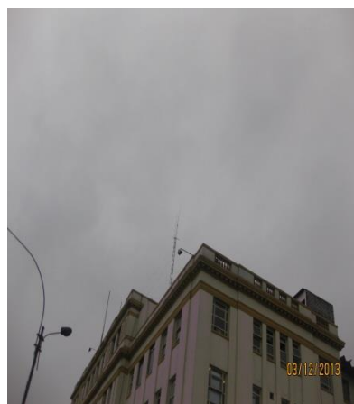
Foto 66: Antena de comunicaciones y torre falta de mantenimiento
