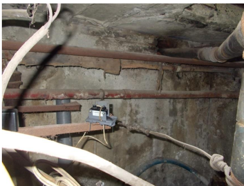
Foto 47: Vista de Tuberías de desagüe y conexiones eléctricas en forma precaria.
