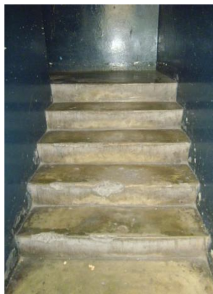
Foto 40: escaleras de evacuación, no ofrecen seguridad por deterioro, ancho y acabado deslizante.
