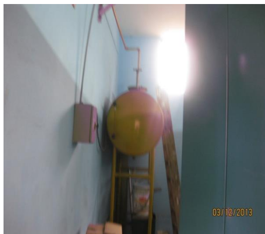
Foto 55: E. encapsulado con tanque diario de petróleo
