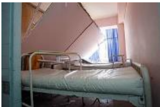
Figura 3: Tabiques no asegurados adecuadamente, corren el riesgo de deformaciones o caídas ante eventos adversos.
