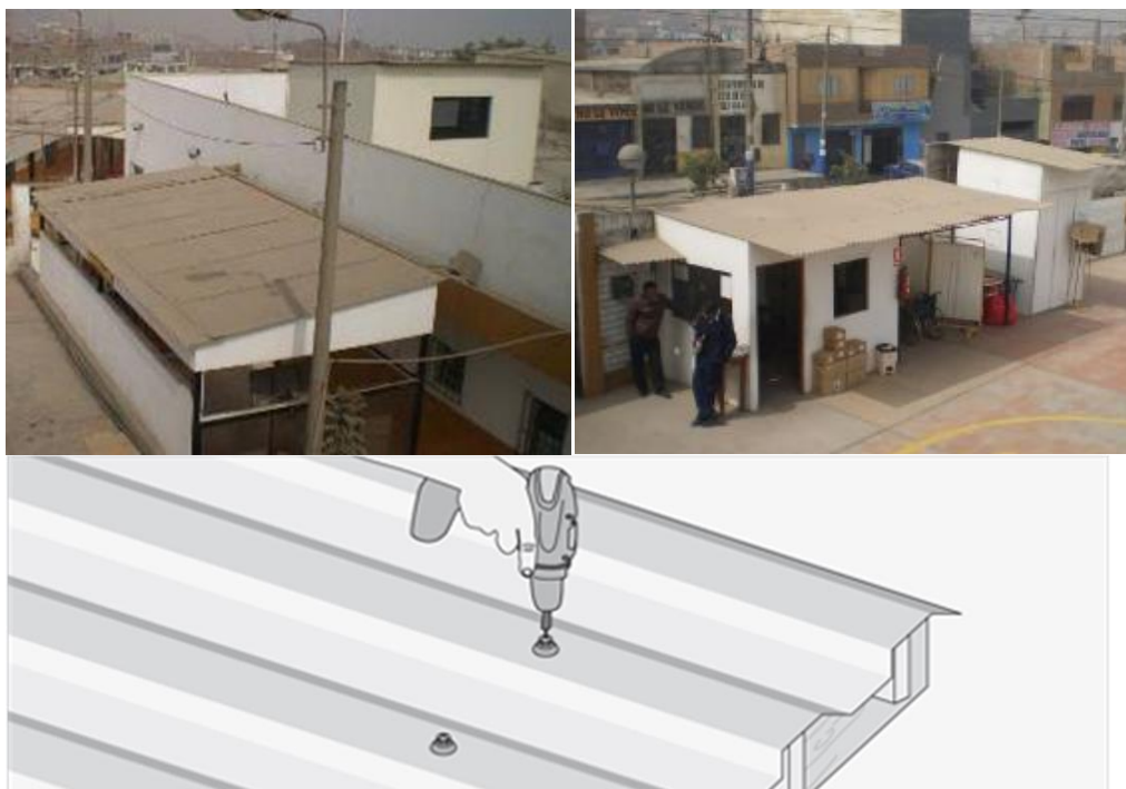
Figura 6: Techos ligeros que deben estar sujetos adecuadamente a fin evitar caídas o desprendimientos
