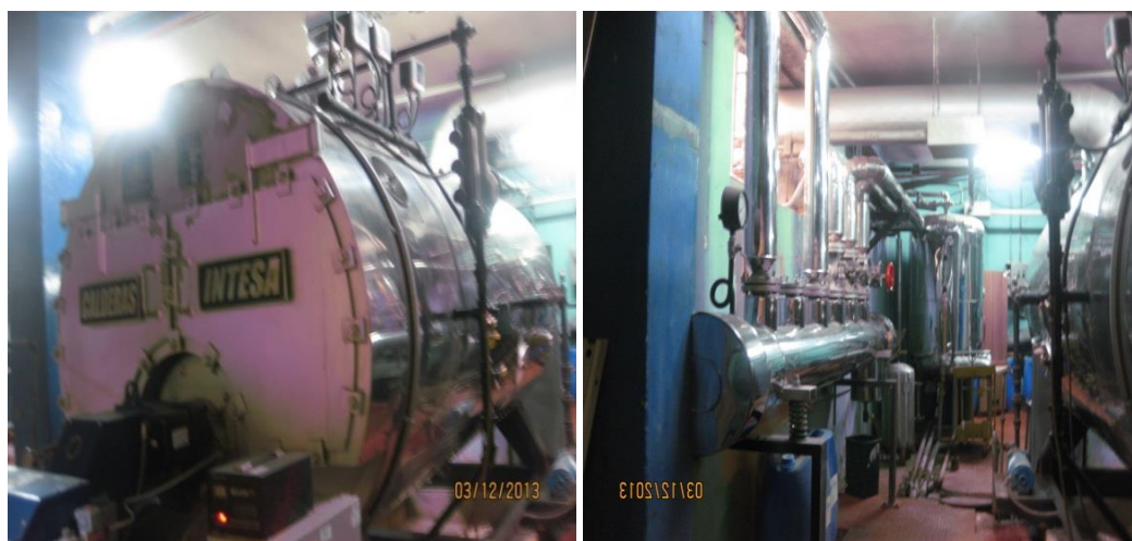
Foto 59: Caldero nuevo de 100 BHP. Foto 60: balones de O2 inseguros
