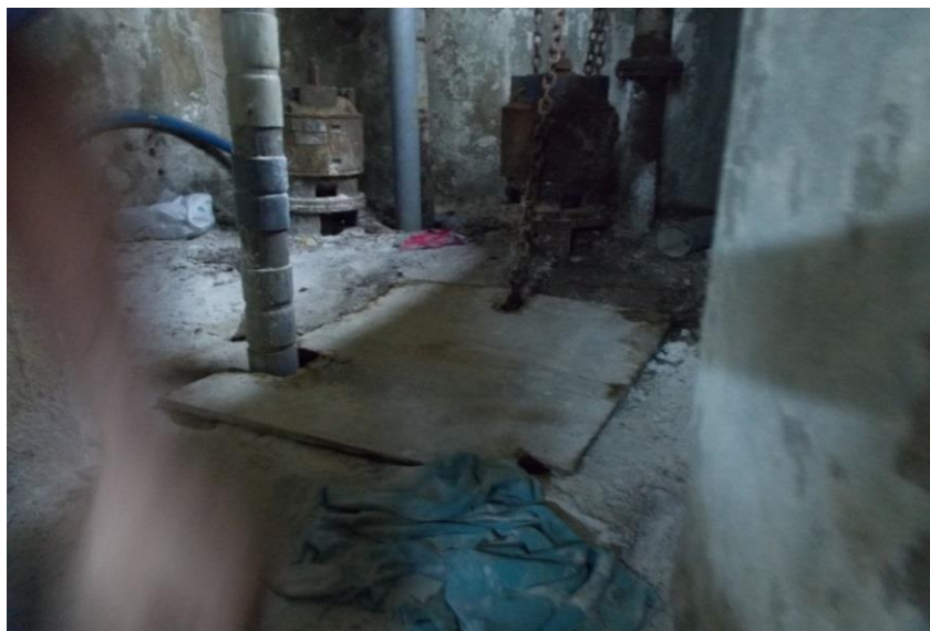
Foto 46: Cámara de bombeo de desagüe en mal estado
