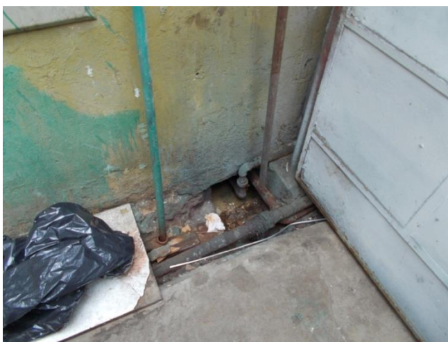
Foto 54: Tuberías de agua de fºgº que se encuentran corroídas.
