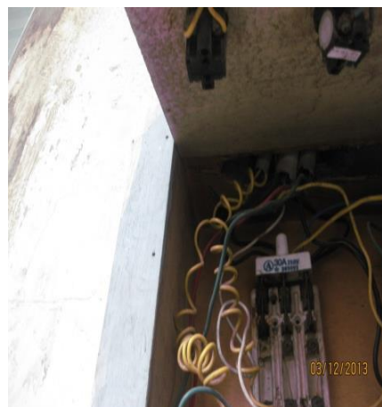
Foto 56: Tablero eléctrico en alto riesgo, tipo de llave
