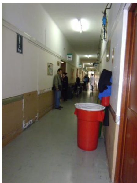
Foto 39: Corredores estrechos, y usados de depósito transitorio, que pone en riesgo en caso de evacuación
