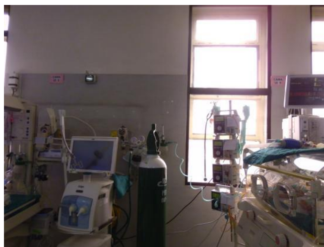
Foto 34: Equipo nuevo y operativo apoyado sobre mobiliario, no hay sujeción adicional. Ventanas con vidrios crudos de grande dimensiones, cercanos a incubadoras
