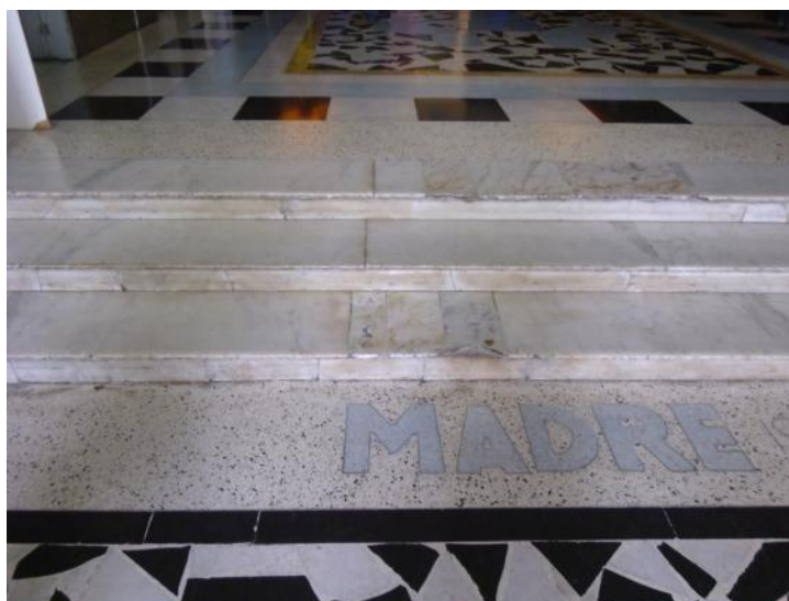
Foto 38: El vestíbulo de ingreso tiene pasos con acabado de mármol, carece de barandas para seguridad. Barrera arquitectónica para personas con discapacidad.
