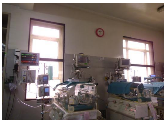
Foto 32: UCIN: equipos monitores apoyados sobre repisas sin borde de seguridad sobre incubadoras. Nótese la cercanía de las incubadoras a las ventanas con vidrio crudo.
