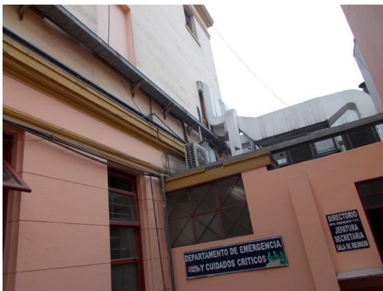
Foto 44: Tuberías de agua y desagüe de PVC instaladas en forma precaria
