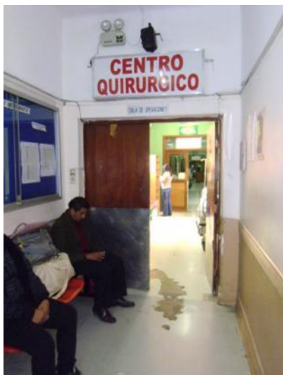
Foto 20: el piso deteriorado por el uso y antigüedad es un factor desfavorable en caso de evacuación
