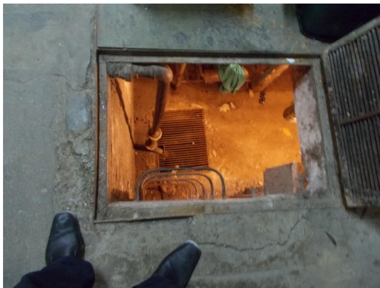
Foto 52: Cámara de bombeo expuesta a inundaciones.
