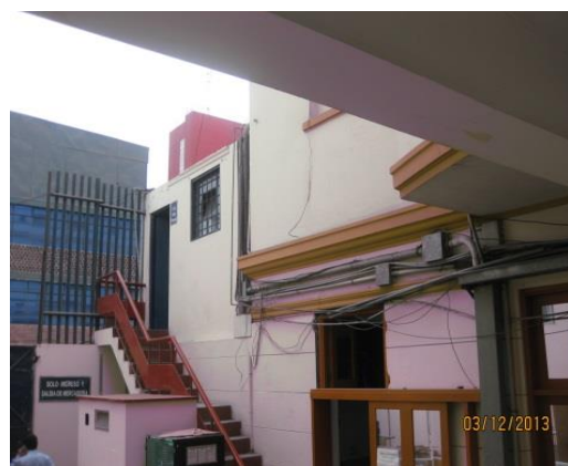
Foto 58: Redes eléctricas expuestas, son un peligro
