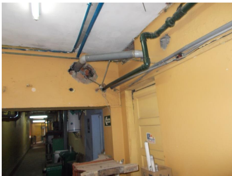
Foto 49: Tuberías de desagüe atraviesa vigas.
