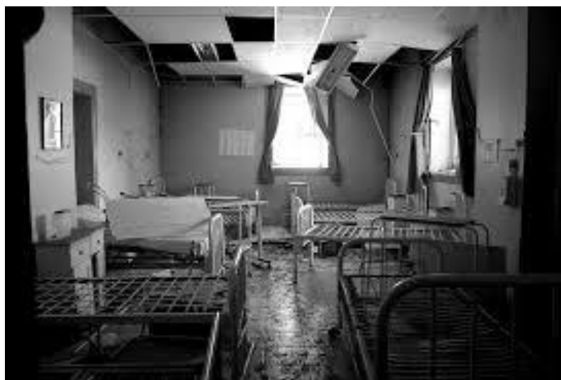
Figura 9: Luminarias no sujetadas adecuadamente en techo ante movimientos sísmicos, se caen e incrementan el peso del falso cielo raso provocando colapso del sistema
