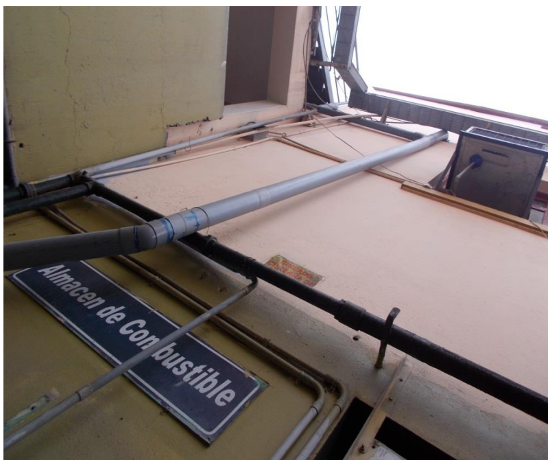
Foto 50: Tuberías de agua y desagüe de PVC instaladas en forma precaria cerca del almacén de combustible.
