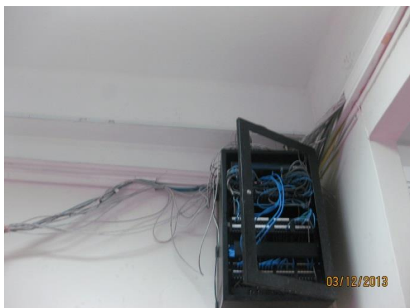
Foto 65: Rack de comunicaciones con cables desordenados y expuestos
