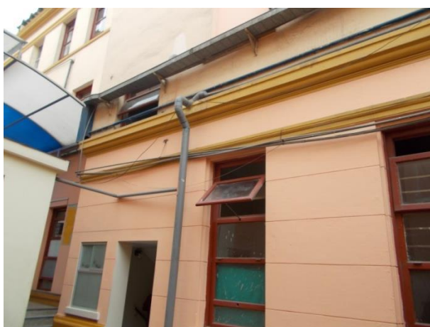
Foto 43: Tuberías de desagüe de PVC expuestas a radiación solar
