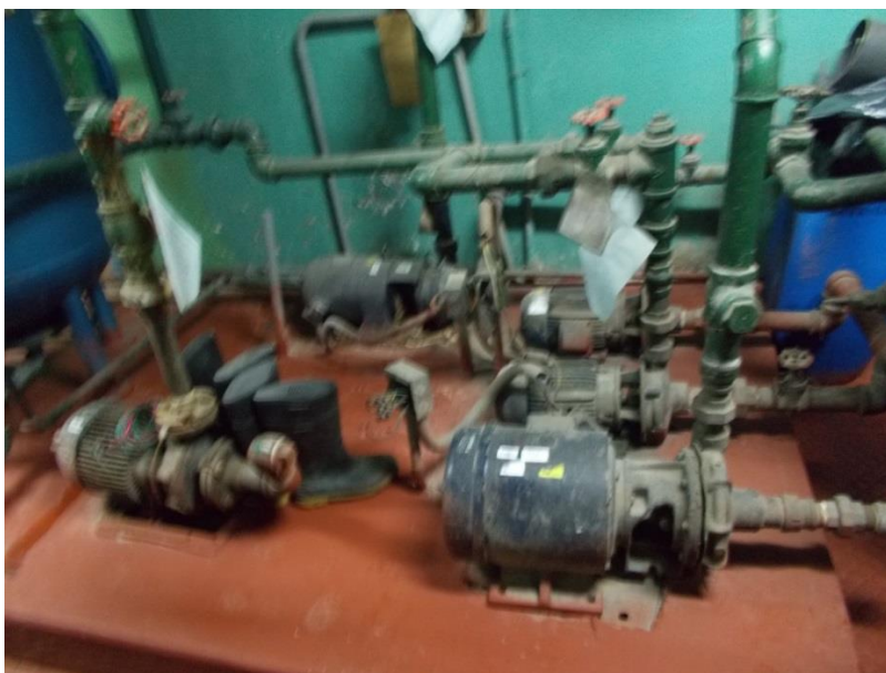
Foto 51: Árbol de descarga sin uniones flexibles.
