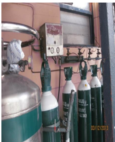
Foto 63: Manifold para sistema de emergencia
