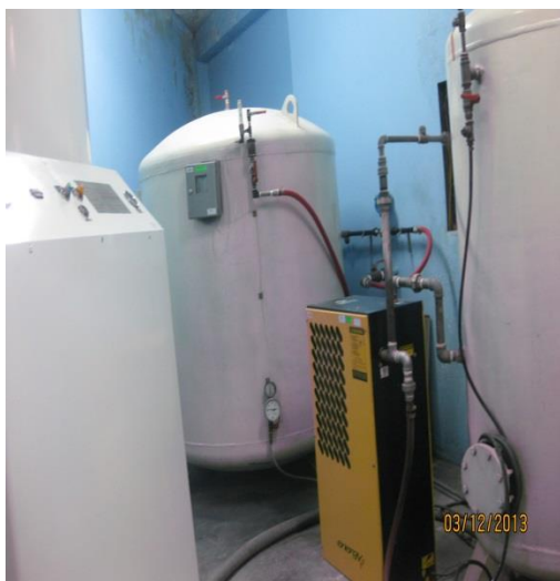
Foto 61: Tanques criogénicos de producción de 24m 3 /hora
