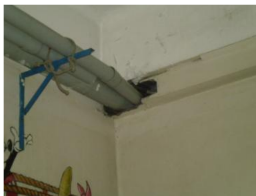
Foto 28: las tuberías atraviesan los ambientes y con elementos inadecuados de sujeción, posible desprendimiento en caso de sismo de gran intensidad, ocasionando que no funcione la UPSS de Imágenes.
