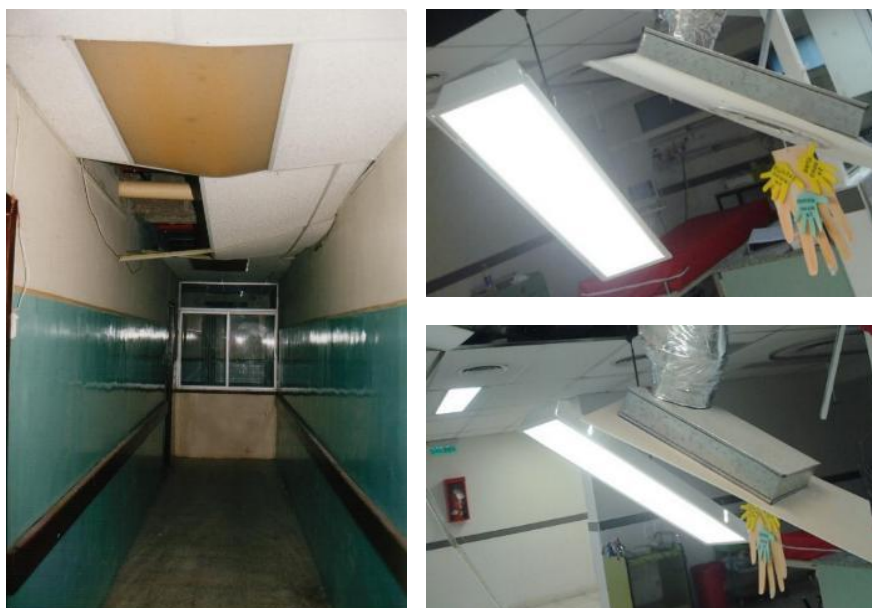
Figura 5: Falsos cielos rasos se desprenden por deficiencia en anclajes ante movimientos sísmicos
