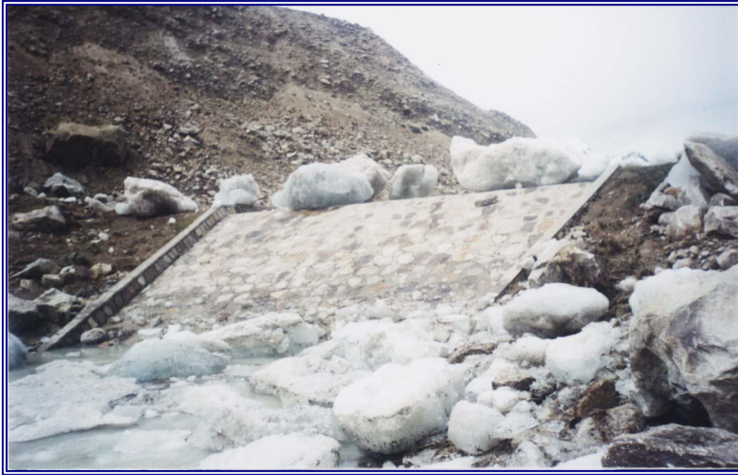
Foto 3. Vista de la cara interior del dique de contención después del derrumbe del 19 de marzo del 2003. Véase los enormes bloques de hielo que quedaron sobre la corona.
