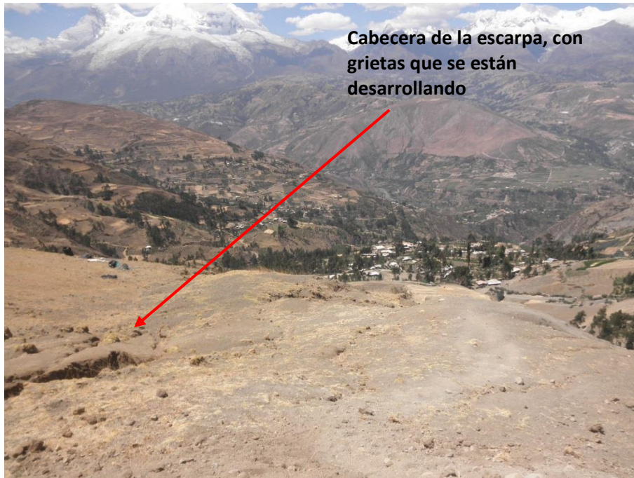
Foto 10. Reactivación de la zona de escarpa, hacia su cabecera donde se nota los diversos agrietamientos.
