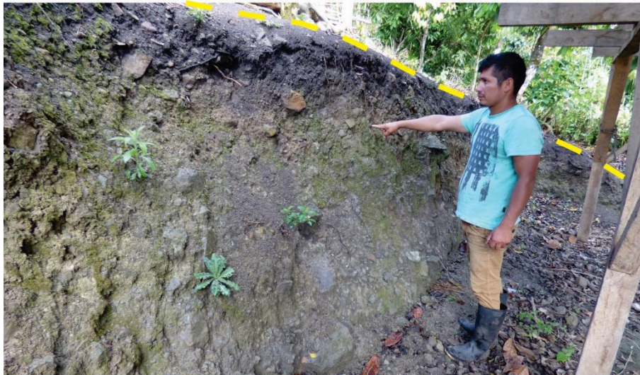
Foto 10. Se aprecia la línea de escarpe secundario.
