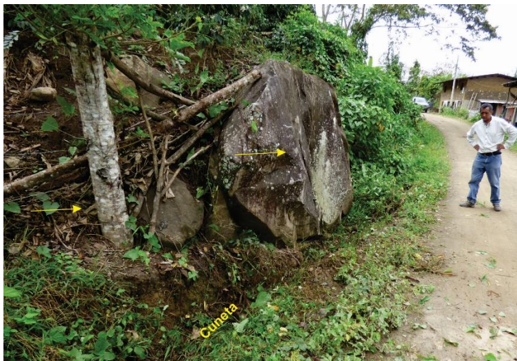
Foto 13. Se muestra el empuje del terreno, afectando la cuneta, además se aprecia el árbol ligeramente inclinado.
