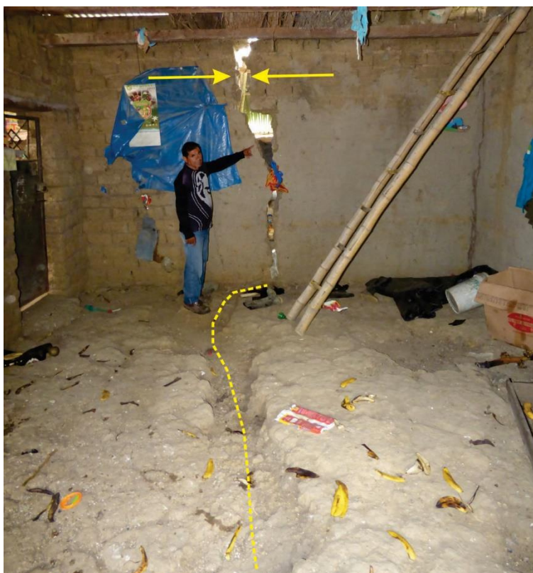
Foto 12. Grieta que esta afectando el piso y pared de vivienda.
