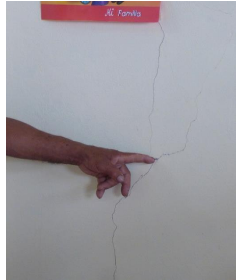
Foto 15. Pared del centro educativo, con fisuramientos en la pared.
