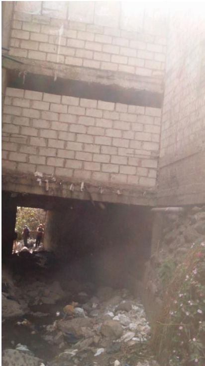
Viviendas construidas sobre el cauce del río.
