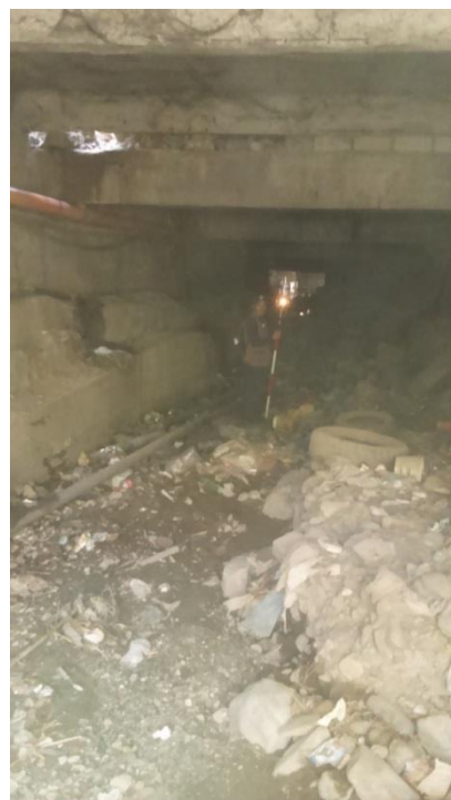
Altura del cauce del río de 3 m aproximadamente.
