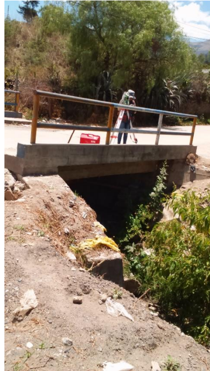
Puentes que estrechan el cauce del río Chinchichaca
