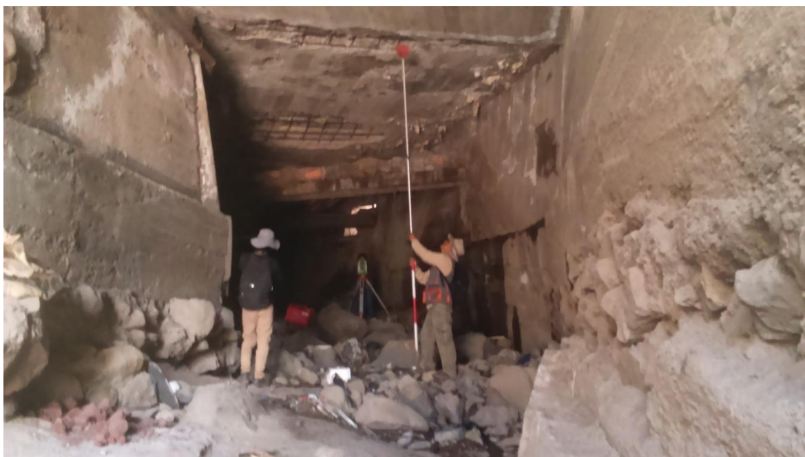
Altura del cauce del río y ancho irregular debido a las construcciones existentes, a esto se añade la acumulación de material suelto depositado.
