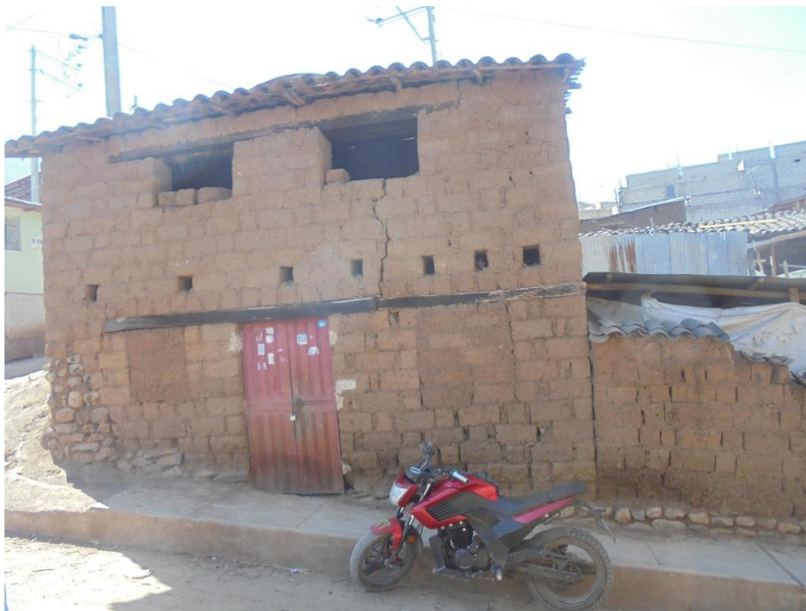
Viviendas de material de adobe con fracturamiento paralelo.
