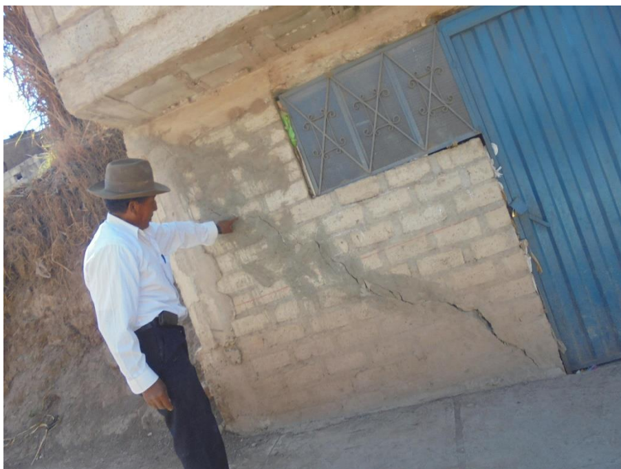
Viviendas de concreto con fracturamiento.
