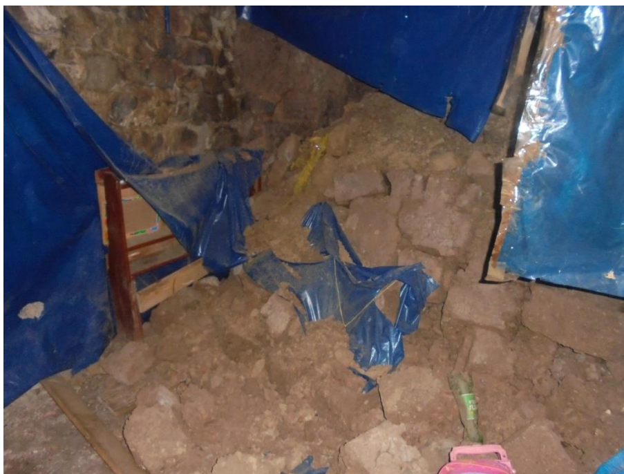
Viviendas parcialmente colapsado.
