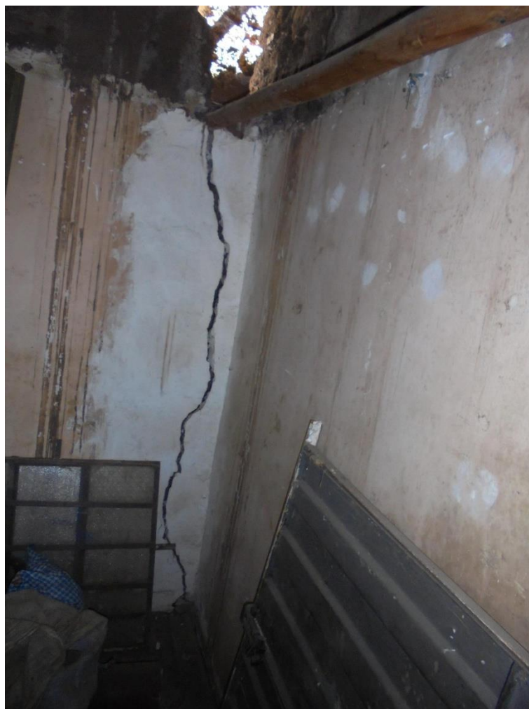
Viviendas en muy mal estado de conservación.
