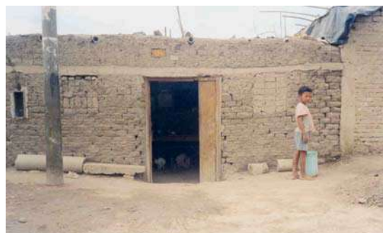
Inadecuada aplicación del Sistema Constructivo
