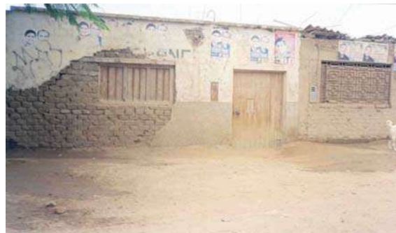
Viviendas vulnerables ausencia de impermeabilizantes en el tarrajeo
