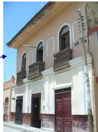
Fotografía. Abril de 2010 Casa conocida como "el rosedal", de inicios de la República, edificada con ladrillo, adobe y quincha. El inmueble se registra exteriormente mal estado de conservación.
