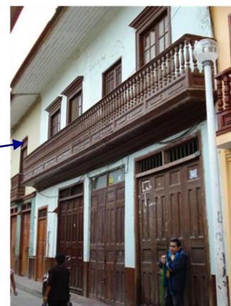
Casona Colonial ubicada en el Jr Comercio 664- 668- 672 –Centro Histórico de la ciudad de Catacaos Actualmente el inmueble se registra en mal estado de Conservación
