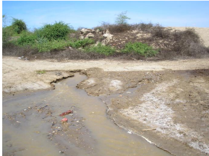
Dique Izquierdo filtraciones en zona protegida Sector Viduque
