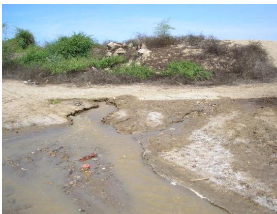
Dique Izquierdo afloramientos de agua en zona lado protegido Sector Viduque
