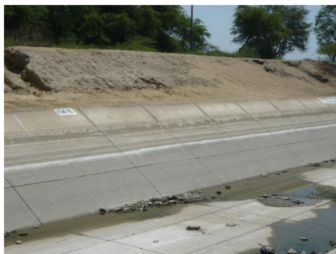
Canal Biaggio Arbulu Km 16+000, se observa erosiones en el talud del Dique Derecho
