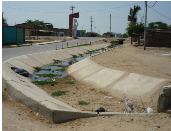
Vertido de desagüe en Dren Comas
