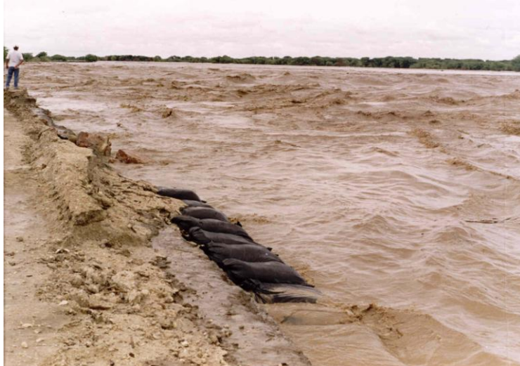
Erosión Dique Derecho Avenidas Río Piura 1998 Fuente: Proyecto Especial Chira Piura PECHP
