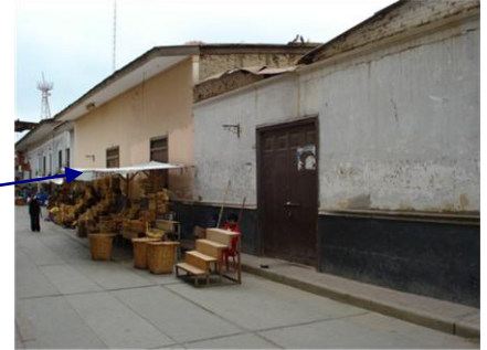
Casona Colonial ubicada en el Jr Comercio 725 – 731 – 737 - 743 – Centro Histórico de la ciudad de Catacaos Actualmente el inmueble se registra estado de Conservación Regular
