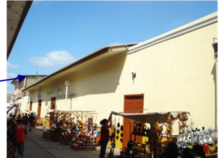
Casona Colonial ubicada en el Jr Comercio 748 754- 766 –Centro Histórico de la ciudad de Catacaos Actualmente se registra en mal estado de Conservación
