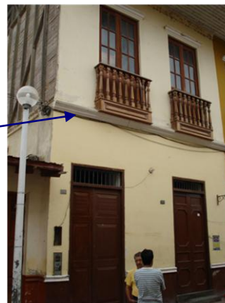
Casona Colonial ubicada en el Jr Comercio 640 – 644 Centro Histórico de la ciudad de Catacaos Actualmente el inmueble se registra en mal estado de Conservación
