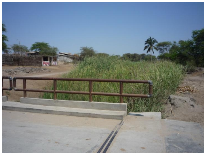
Dren Integración totalmente sucio - Sector Narihuala
