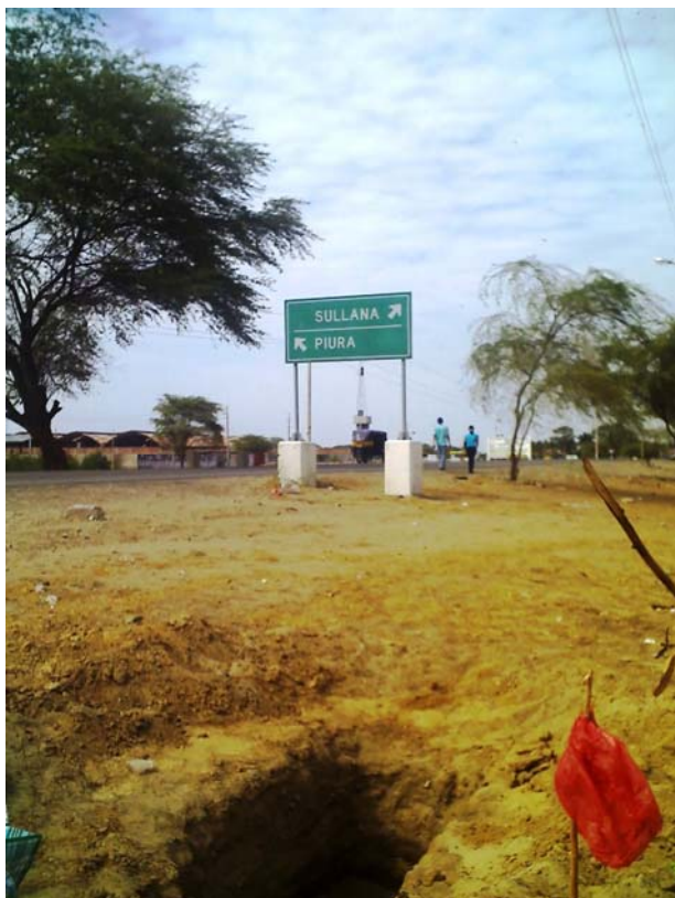
Fotografía N° 43. Calicata C-01 ubicada a la salida de la ciudad de Sullana al pie de la carretera a Tambogrande en donde se aprecia en la excavación la presencia predominante de un suelo arcilloso a arenoso, con cierta plasticidad, en estado seco y Muy Compacto.
