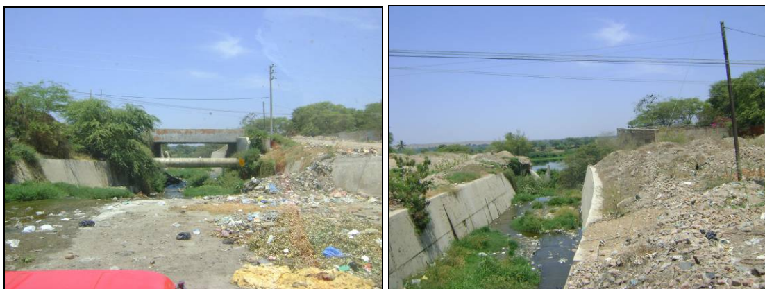
Fotografía N° 15 y N° 16. Izq. Canal Vía aguas arriba de la desembocadura en el río Chira. Se observa colmatado de basura y desmonte. Der. Canal Vía aguas arriba de la desembocadura en el río Chira. Se observa colmatado de basura y desmonte.
