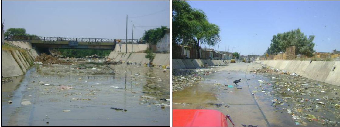
Fotografía N° 11 y N° 12. Izq. Canal Vía en el sector denominado “La Selva”. Se observa abundante basura y arbusto cubriendo el cauce del dren. Der. Canal Vía con presencia de basura y aguas putrefactas.
