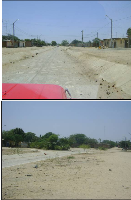
Fotografía Nº 32 y 33. Dren San Felipe. Se observa que estos drenes son tipo Canal Vía. En estiaje sirven de vía para el tránsito vehicular y en días lluviosos son drenes pluviales.
