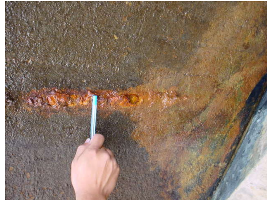
Figura 96. Corrosión del refuerzo en los muros de los decantadores.
