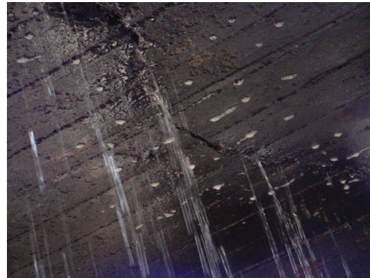
Figura 98. Fisuras en canal de salida del decantador.
