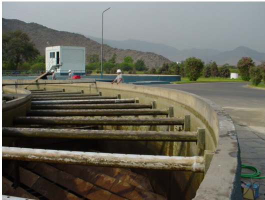
Figura 97. Vista de un decantador
