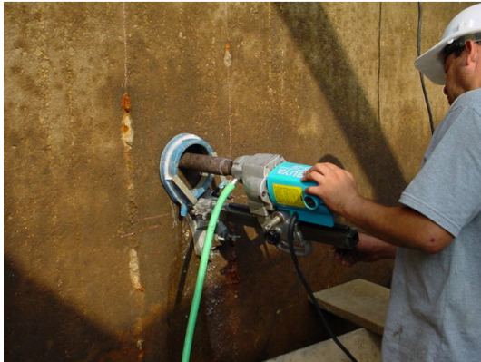
Figura 95. Extracción de testigos de concreto endurecido. Obsérvese la corrosión en el muro
