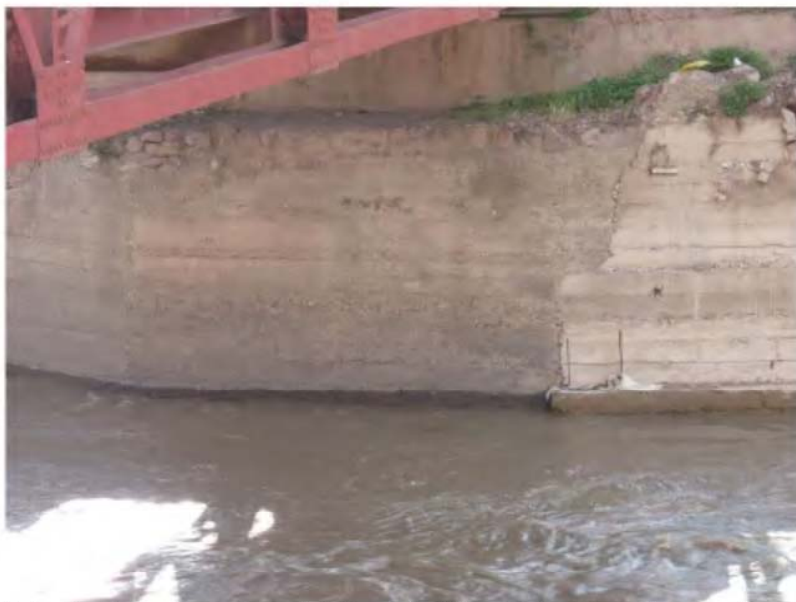
Foto 12: Vista de los cimientos del Puente Huayllabamba, los cuales, por debajo del nivel del río están erosionados.
