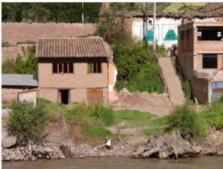
Foto 10: Vista de lo que fue una vivienda, la cual colapso producto de las crecidas del río Vilcanota.
