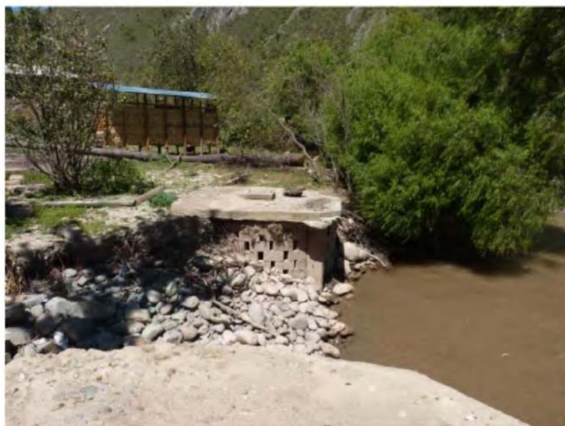
Foto 05: La crecida del río Vilcanota produjo la erosión de la zona urbana. En la foto se aprecia la exposición de un buzón de desagüe.
