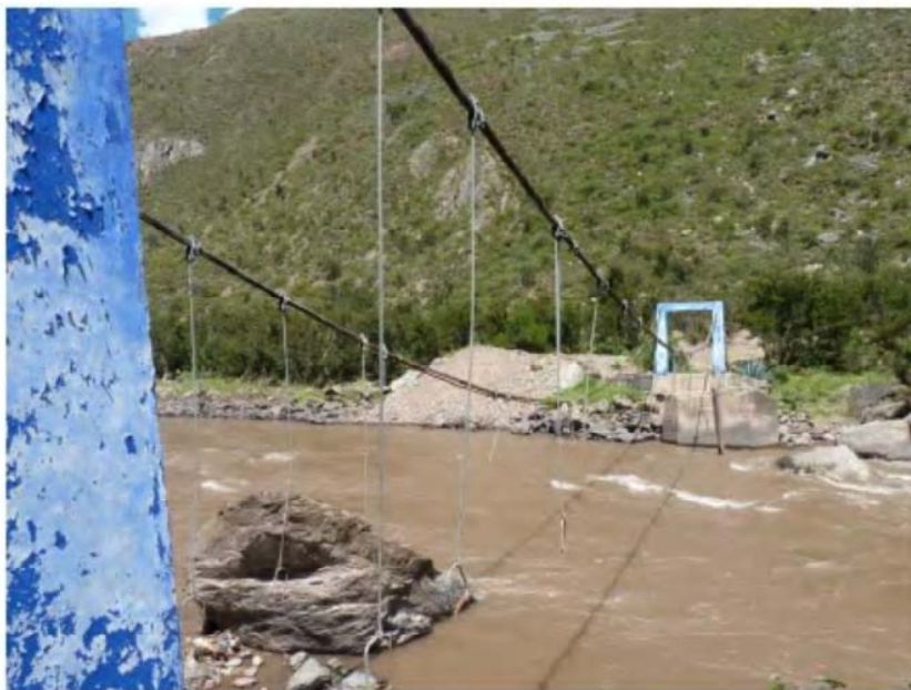
Foto 04: Estado actual del Puente San Pedro, solo quedan las bases laterales.
