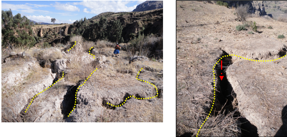
Foto 10. Grietas profundas en cuerpos de deslizamiento sector Yanacocha-Ondecca
