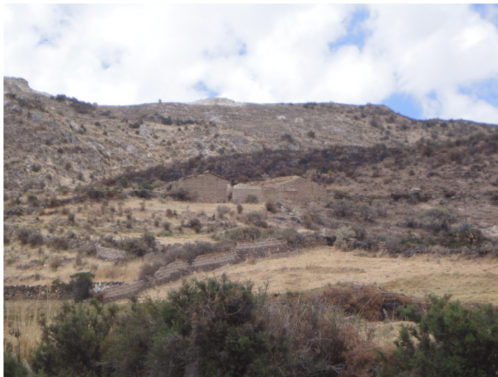
Foto13. Agrietamientos de estancias y derrumbes de pircas y cercos en el sector Tucso
