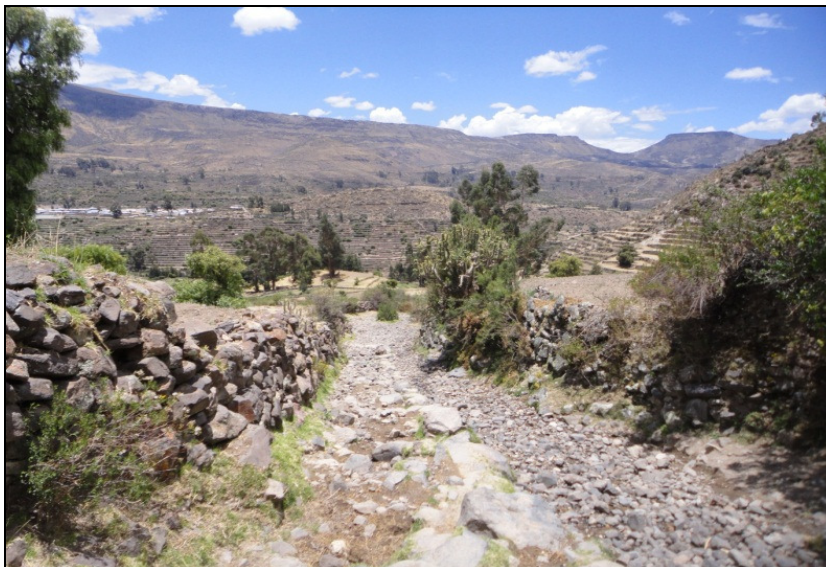
Foto 11. Flujos de lodo y detritos cubriendo camino de herradura.
