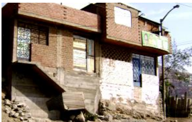
Foto N°21: Edificaciones de ladrillo en zona consolidadas sobre pircas y muros de contención que garantiza una mejor estabilidad de la construcción.
