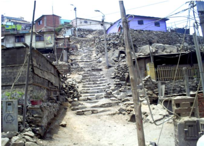
Foto N° 17: Tendido eléctrico de la empresa desde el cual se instalan conexiones clandestinas que generan situaciones de peligro.
