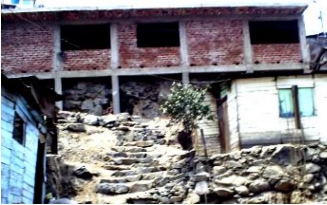
Foto N°23: Edificación de ladrillo con columnas y techo aligerado que sin embargo se apoya sobre pirca, sin muro de contención.
