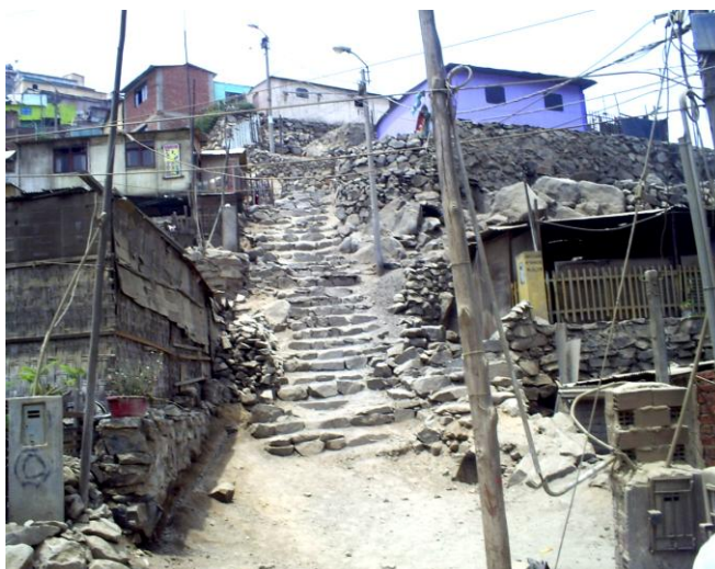
Foto N°25: Edificaciones en mal estado de construcción localizada en la zona alta de la quebrada.
