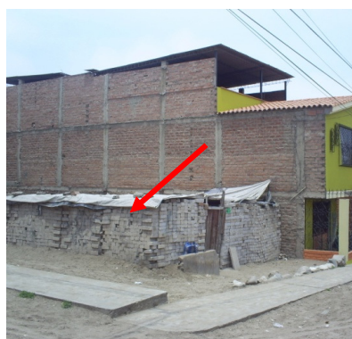
Figura 31. Vivienda con alta vulnerabilidad, construida por apilamiento de ladrillos
