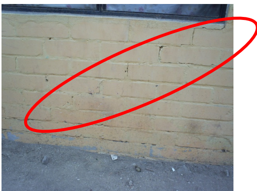
Figura 122. Fisura Diagonal en vano de albañilería
