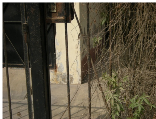
Figura 98. La vivienda anterior, detalle de daño observado
