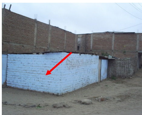
Figura 50. Vista de una vivienda con unidades de ladrillo sin confinar y en mal estado
