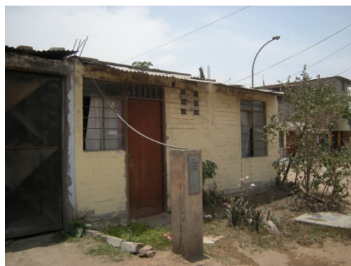
Figura 61. Modulo de vivienda con grietas. Ver foto siguiente
