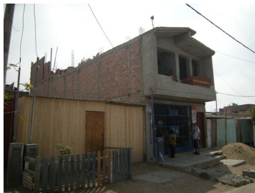
Figura 96. Mejor estado de conservación por ser reciente, pero sigue siendo material no ingenieril
