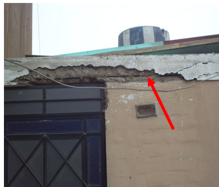
Figura 125. Daño en la viga de confinamiento y la losa de la vivienda, dejando expuesto el acero de refuerzo
