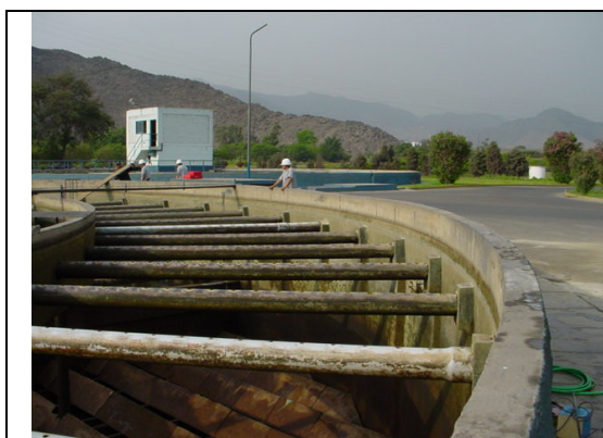
Figura 334. Vista de un decantador
