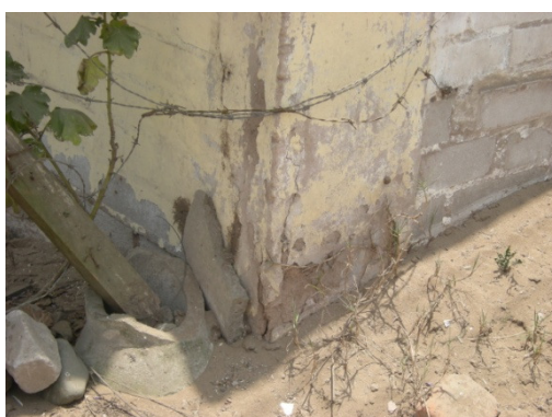
Figura 62. Desprendimiento de recubrimiento en base de columna de vivienda en Figura 61
