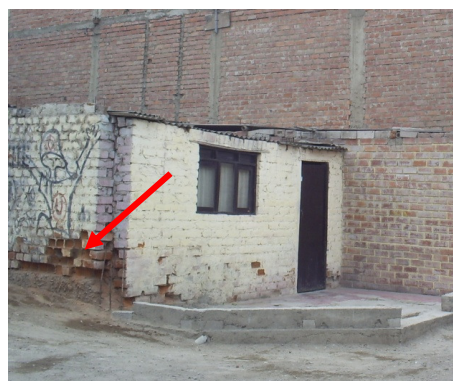
Figura 51. Vista de vivienda de albañilería sin confinar con daño por humedad
