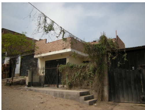
Figura 97. Lote de vivienda con grietas de deterioro de material
