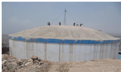
Figura 234. Reservorio de agua
