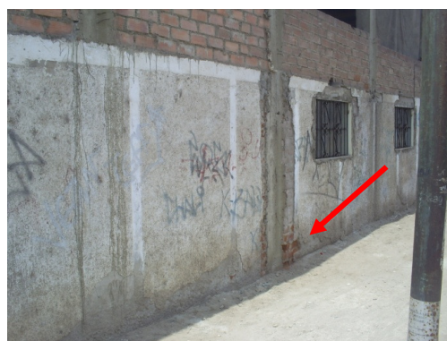
Figura 67. Vista de vivienda de albañilería en mal estado y dañado humedad
