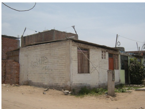
Figura 60. Modulo de vivienda con rajadura en muro de albañilería
