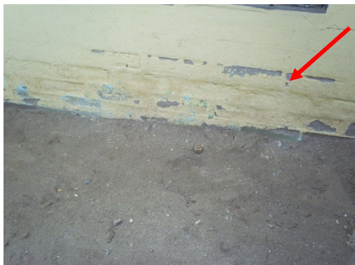
Figura 124. Presencia de humedad en cimentación de vivienda de albañilería
