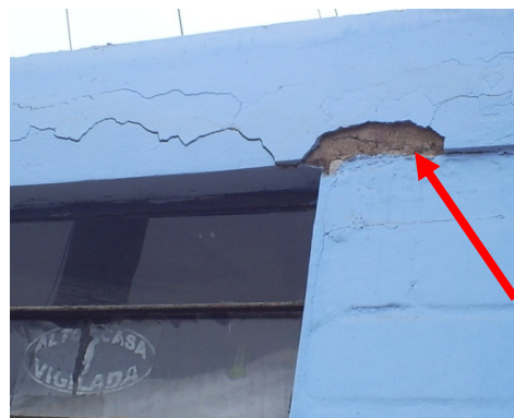
Figura 123. Grieta horizontal en losa de techo
