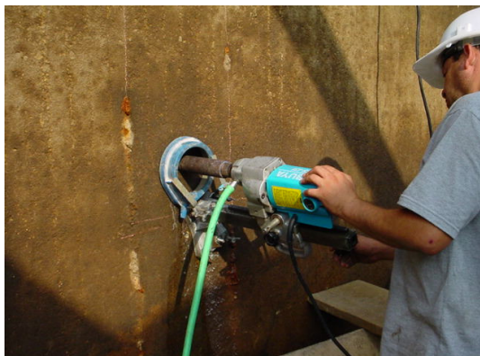
Figura 332. Extracción de testigos de concreto endurecido. Obsérvese la corrosión en el muro
