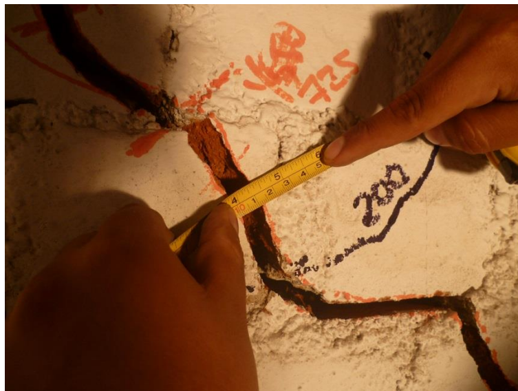
Figura 26. Agrietamiento de muro en carga
