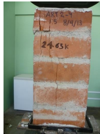
Agrietamiento vertical y aplastamiento de las unidades
