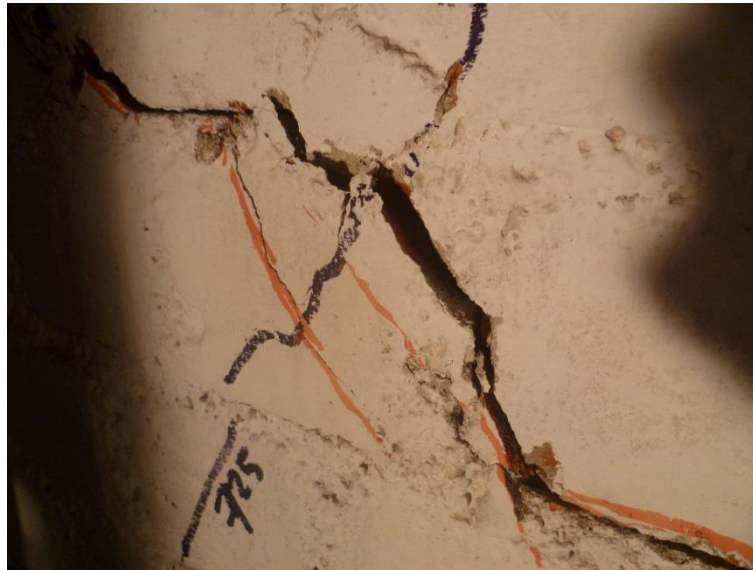
Figura 25. Agrietamiento de muro en descarga
