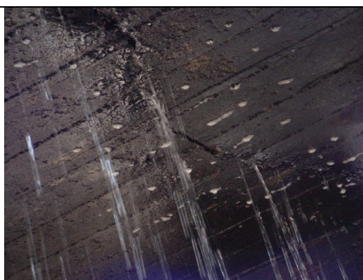
Figura 188. Fisuras en canal de salida del decantador.
