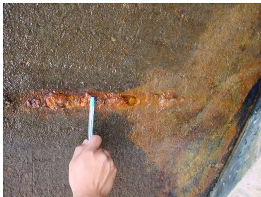
Figura 186. Corrosión del refuerzo en los muros de los decantadores.
