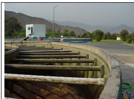
Figura 187. Vista de un decantador
