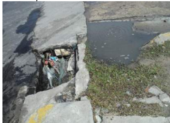
Foto 05.47: Emanación de aguas servidas originadas por mal estado del sistema de alcantarillado de la ciudad.(Fuente: E.T, PCS-Iquitos, 2014)
