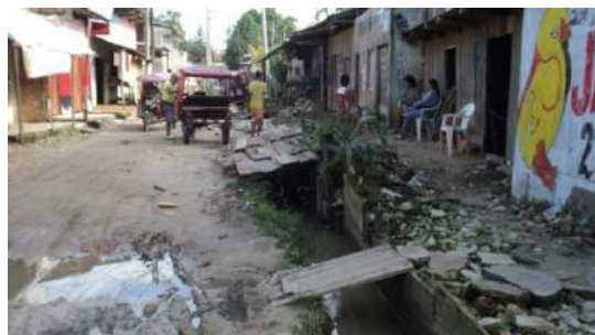
Foto 05.17: Sistema de canales a cielo abierto de aguas servidas en la zona de Punchana, constituyendo focos infecciosos peligrosos para la salud de la población. Fuente: E.T, PCS-Iquitos, 2014
