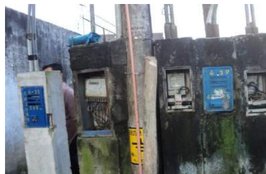
Foto 05.69: Cajas de suministro eléctrico Fuente: E.T, PCS-Iquitos, 2014
