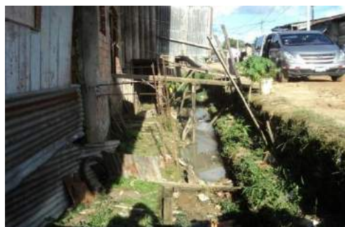
Foto 05.28: Aguas residuales que discurren por las calles de la zona urbana por falta de alcantarillado-Punchana (Fuente: E.T, PCS-Iquitos, 2014)
