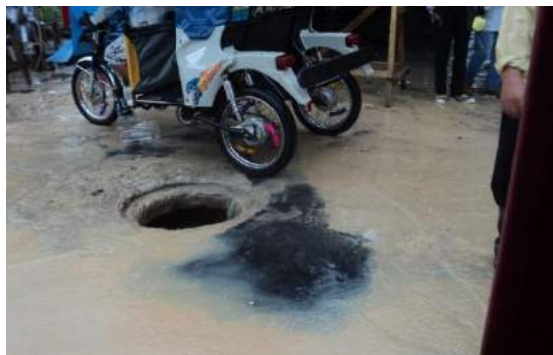
Foto 05.12: Buzón de alcantarillado sin tapa que constituye peligro de accidentes, plagas o epizootias-Av 5 de Diciembre. Fuente: E.T, PCS-Iquitos, 2014)
