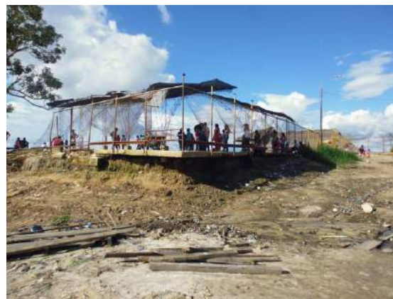
Proceso de erosión fluvial en material limo arenoso en la base de una losa deportiva, Punchana
