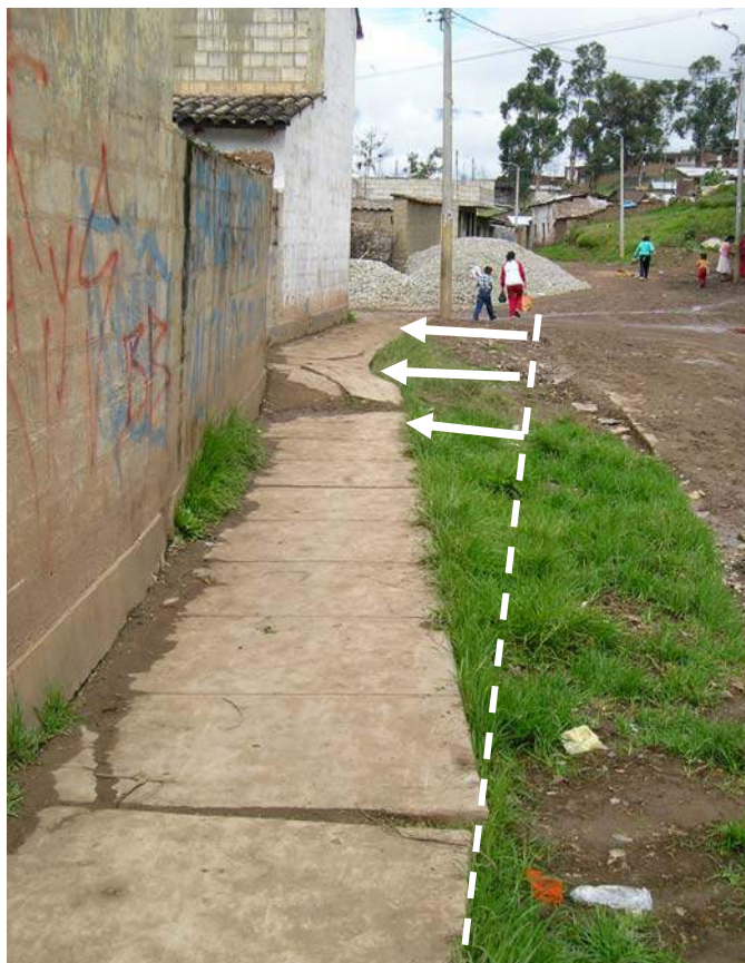
Foto – 46: La foto muestra el alineamiento actual de las aceras que fueron construidas en línea recta
