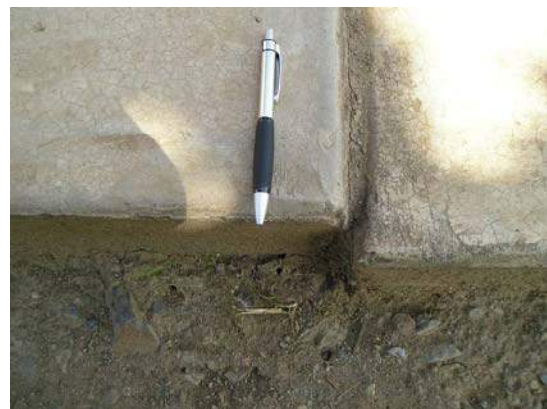
Foto – 42: Desplazamientos en las juntas de las aceras no se pudo determinar si son recientes
