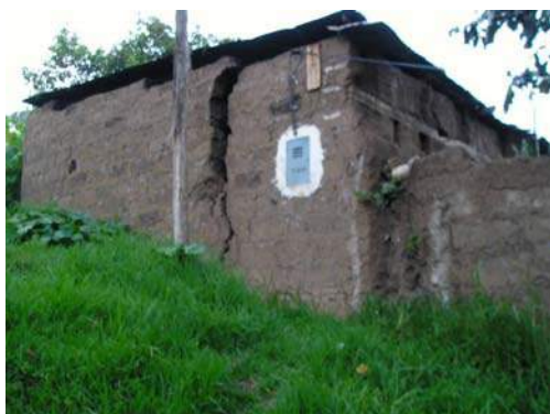
Foto – 37: Vivienda rajada por asentamientos del suelo en el sector de Limapata
