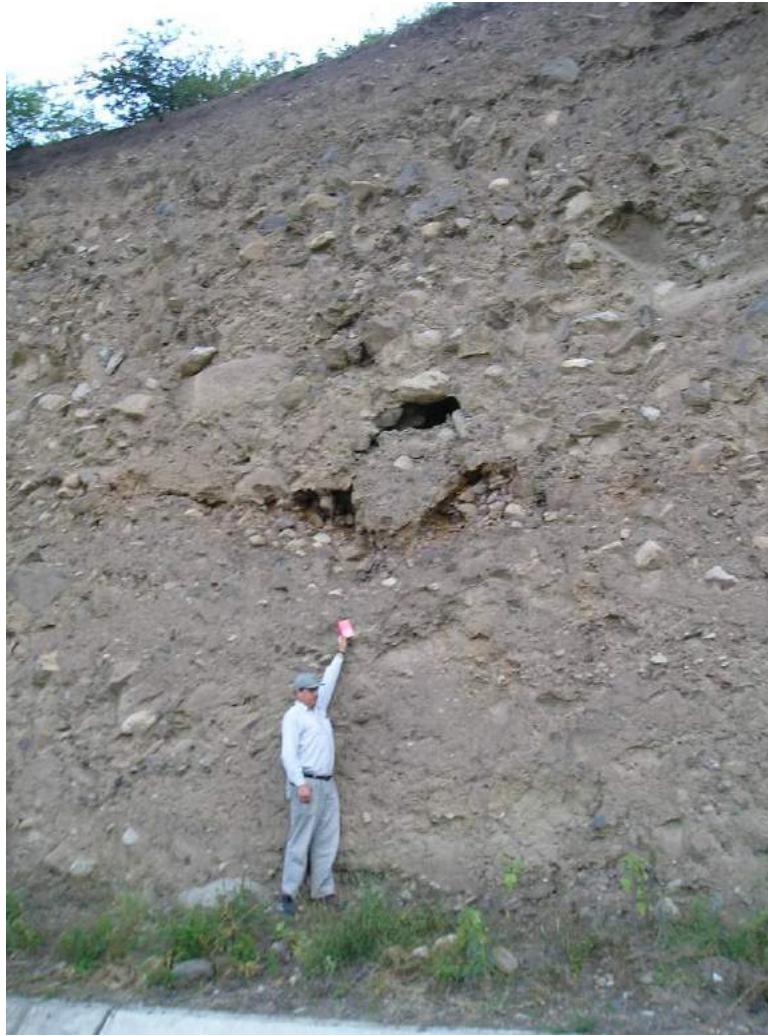
Foto – 21: Vista fotográfica del deposito coluvial en la corte de talud de carretera.
