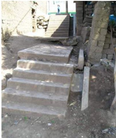
Foto – 39: Las escaleras que se muestran fueron construidas recientemente sobre material de relleno, los daños no son atribuibles al fenómeno de reptación estudiado.
