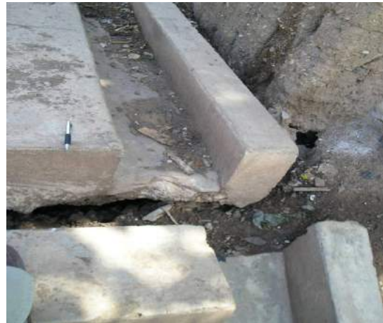
Foto – 44: Grietas de construcciones recientes hechas sobre relleno, no atribuibles al proceso de reptación FONAVI
