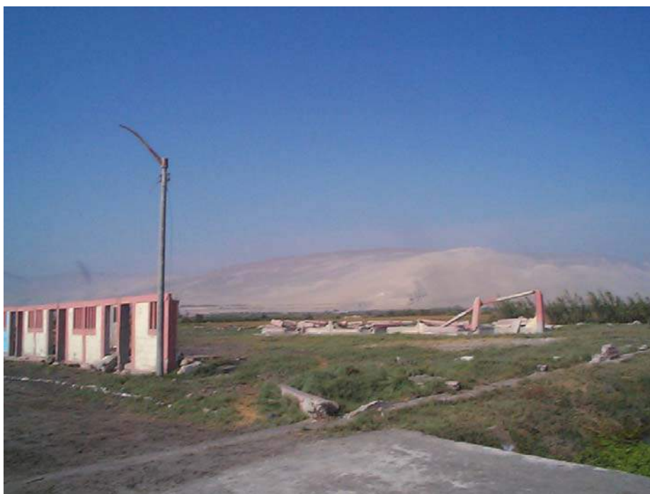
Foto 4.24: Daños ocasionados por el terremoto y Tsunami del 2001. Sector, El Chorro.
