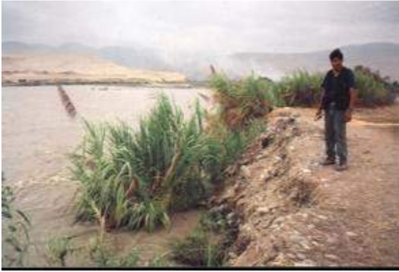
Dique de contención en margen izquierda del río Camaná que requiere mantenimiento
