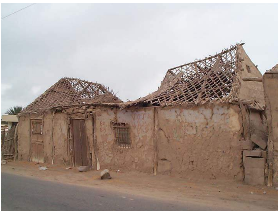
Foto 4.28: Vivienda típica tradicional en estado precario. Sector, San Jacinto.
