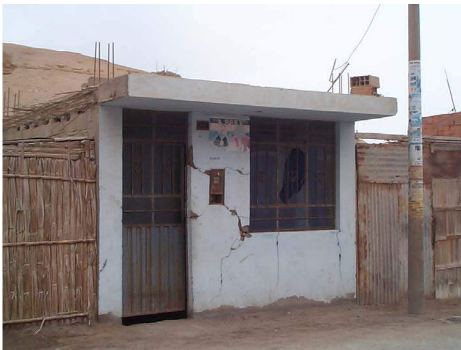
Foto 4.14: Vivienda dañada por sismo y asentamiento diferenciado de suelo. Sector, Juan Pablo Vizcardo y Guzmán.
