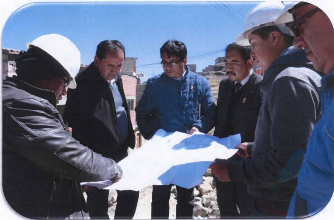
ALCALDE PROVINCIAL Y FUNCIONARIOS EN EL AA.HH. TAHUANTINSUYO, OBRA DE PAVIMENTACION DE CALLES Y SOSTENIMEINETO DE TALUDES.
