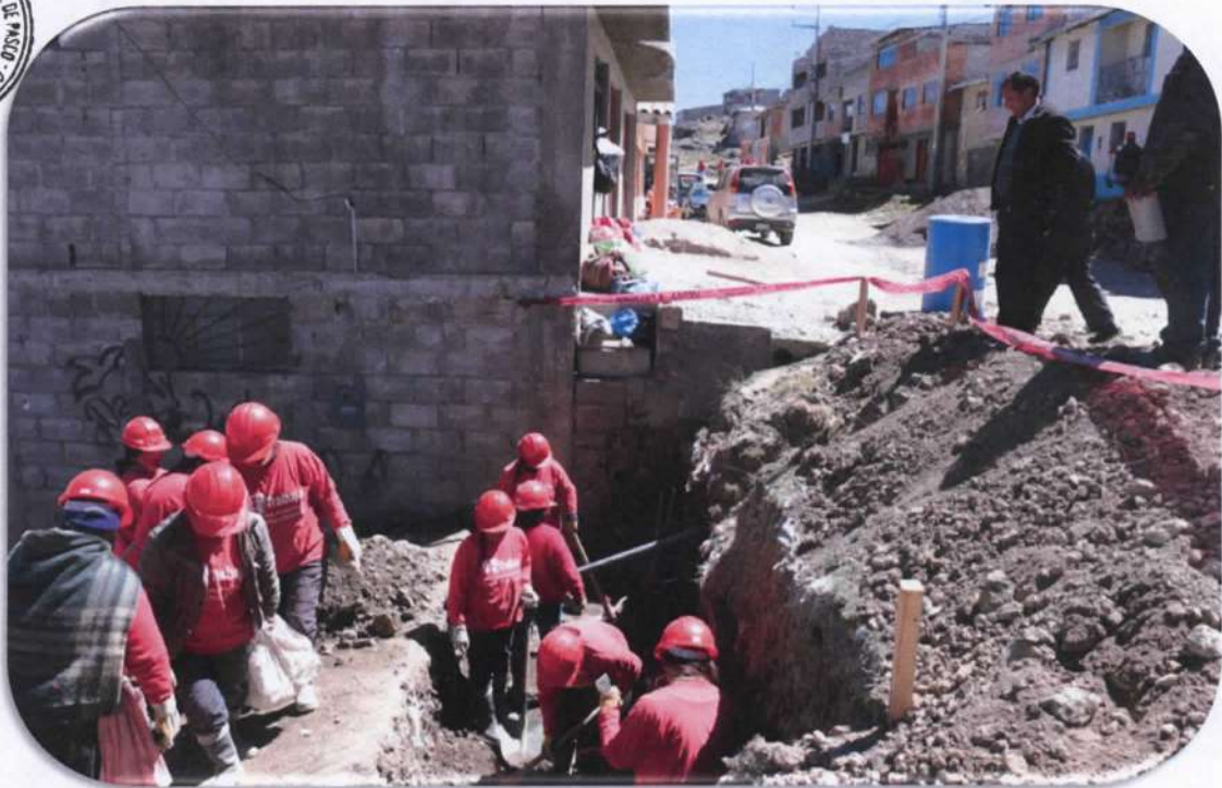
CONTINUAN OBRAS DE MEJORAMIENTO DE CALLES CON GRADERIA Y JARDINES DEL PASAJE PACHACUTEC Y ATAHUALPA AA.HH. TAHUANTINSUYO.
