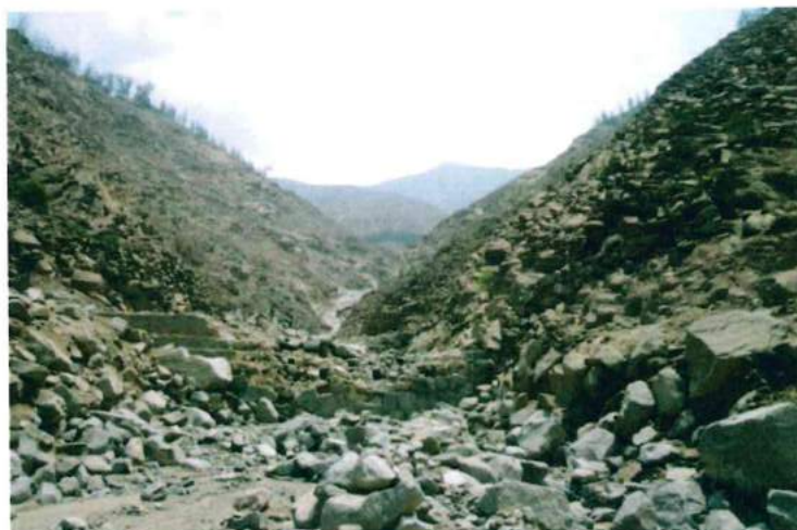
Foto 55. Muro disipador de energía que fue afectado por el paso del flujo de detritos.
