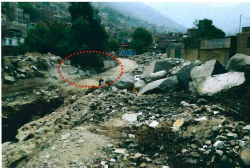
Foto 20. Margen derecha de la quebrada Pedregal, el cauce de la quebrada, usado como calle, parte del muro ha colapsado.
