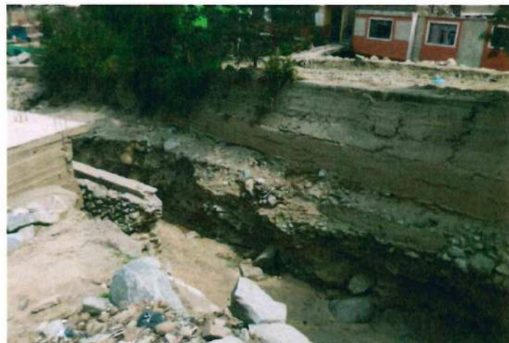
Foto 19. Margen izquierda de la quebrada Pedregal, Sector donde ha colapsado la defensa ribereña.
