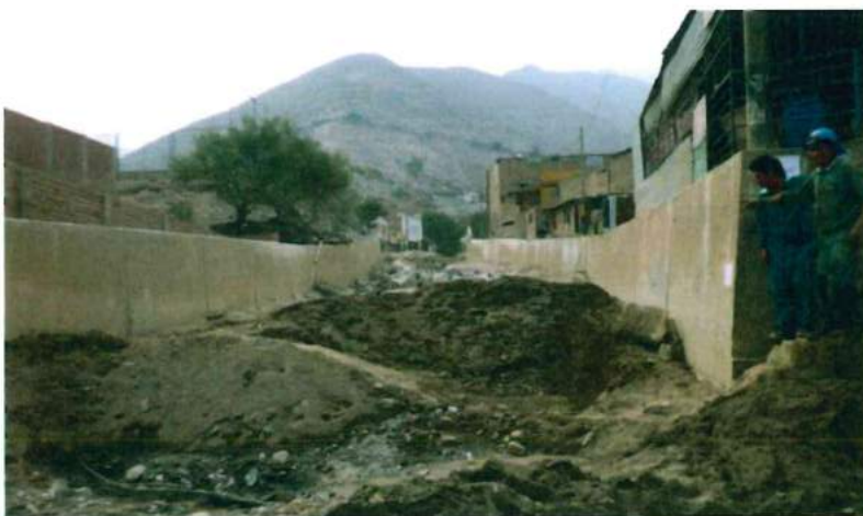
Foto 23. Muros de concreto, ubicados en la desembocadura de la quebrada, se aprecia también el material suelto en su cauce; zona que también requiere ser descolmata.
