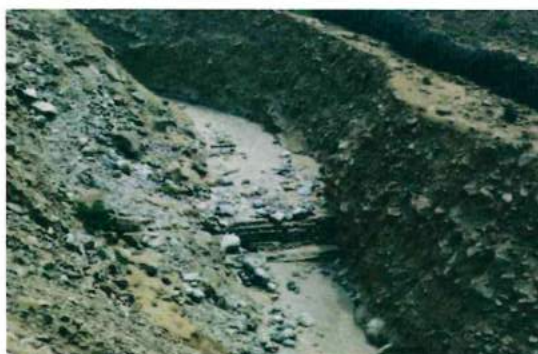
Foto 16. Muro disipador de energía que ha retenido material suelto y se encuentra colmatado.
