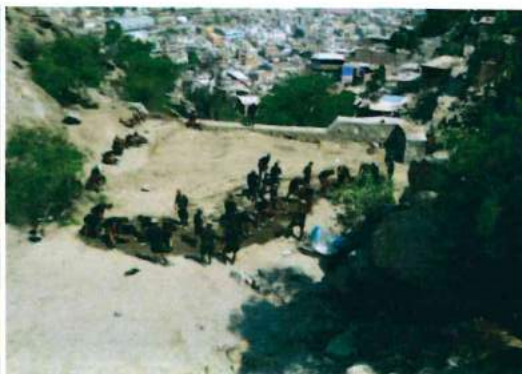
Foto 29. Presa formada por los muros disipadores de energía, completamente colmatada.
