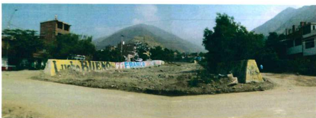
Foto 6. Quebrada Quirio canalizada, con un ancho de 10 m. Los muros tienen alturas hasta de 2 m.
