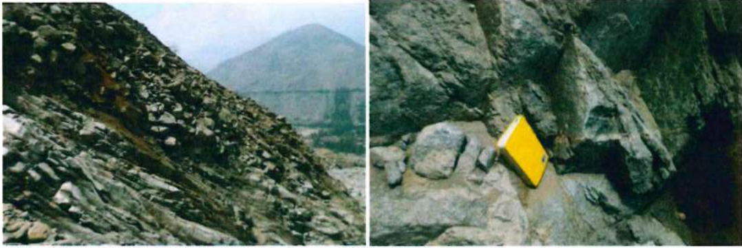
Foto 47 y Foto 48. Fracturamiento en rocas intrusivas.
