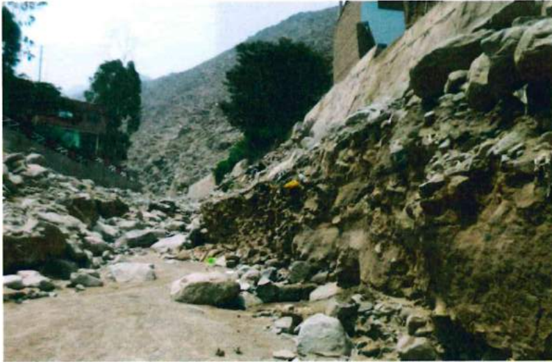
Foto 21. Muros de la defensa ribereña que han quedado colgados por la erosión lineal y socavamiento en la quebrada Pedregal.
