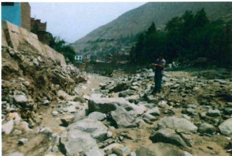
Foto 22. Gran acumulación de material suelto en el cauce de la quebrada que requiere ser limpiado.
