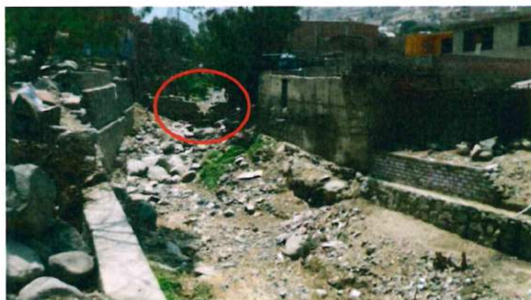
Foto 8. Se muestra la reducción del cauce de la quebrada, como también la destrucción parcial del muro disipador de energía construido de mampostería de piedra.
