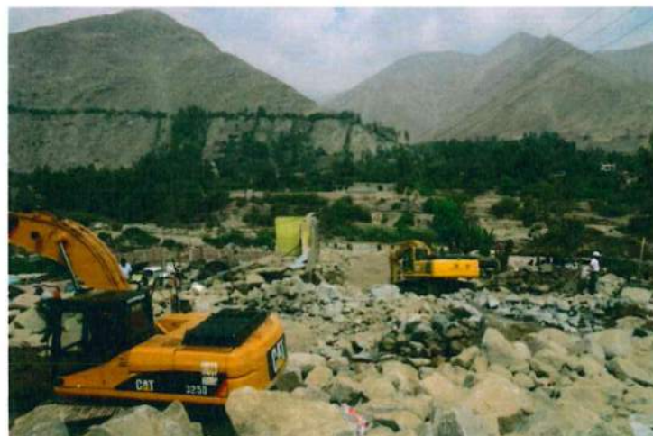
Foto 51. Bloques canalizados por el cauce principal de la quebrada.
