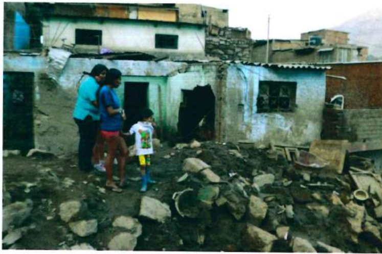
Foto 38. Paredes de viviendas destruidas parcialmente por el agua y el impacto de bloques arrastrados por el flujo.
