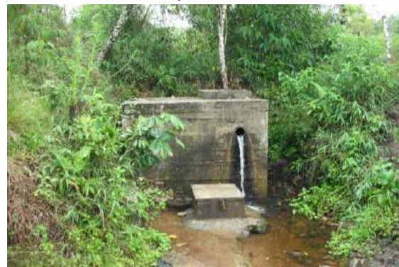
Foto N° 61: Cámara de reunión del sistema de Captación “La Colina”
