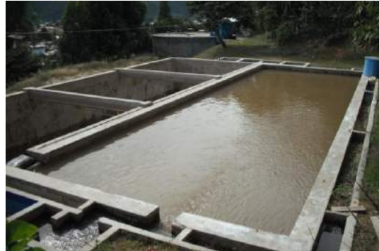
Foto N°62: Sedimentador y filtro lento del sistema del reservorio de 690 m 3 .
