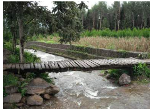
Foto N° 87 Sistema de Gaviones en los márgenes de la Quebrada San Alberto
