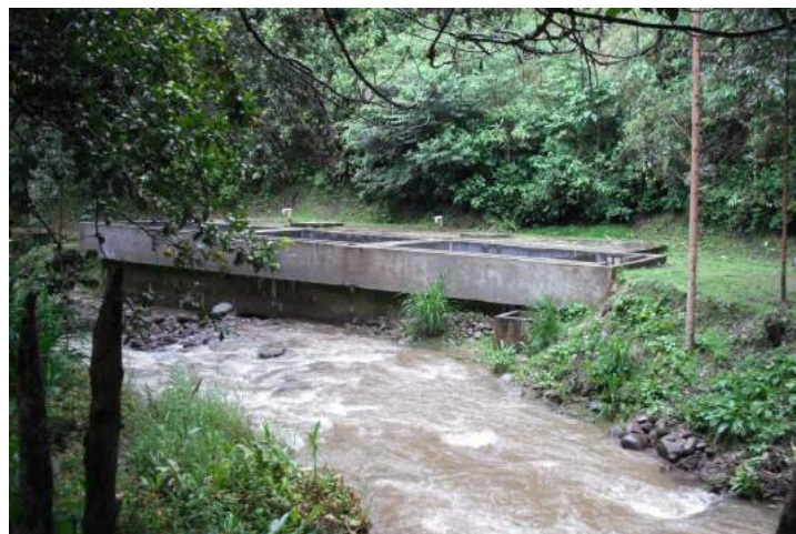
Foto N° 58: Desarenador del sistema captación de las aguas Quebrada San Alberto
