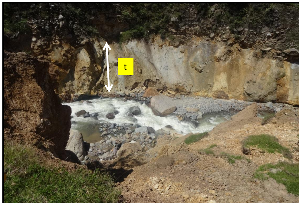
Foto 05: En la terraza "t" se observa socavación debido a la acción erosiva del río Huachos.
