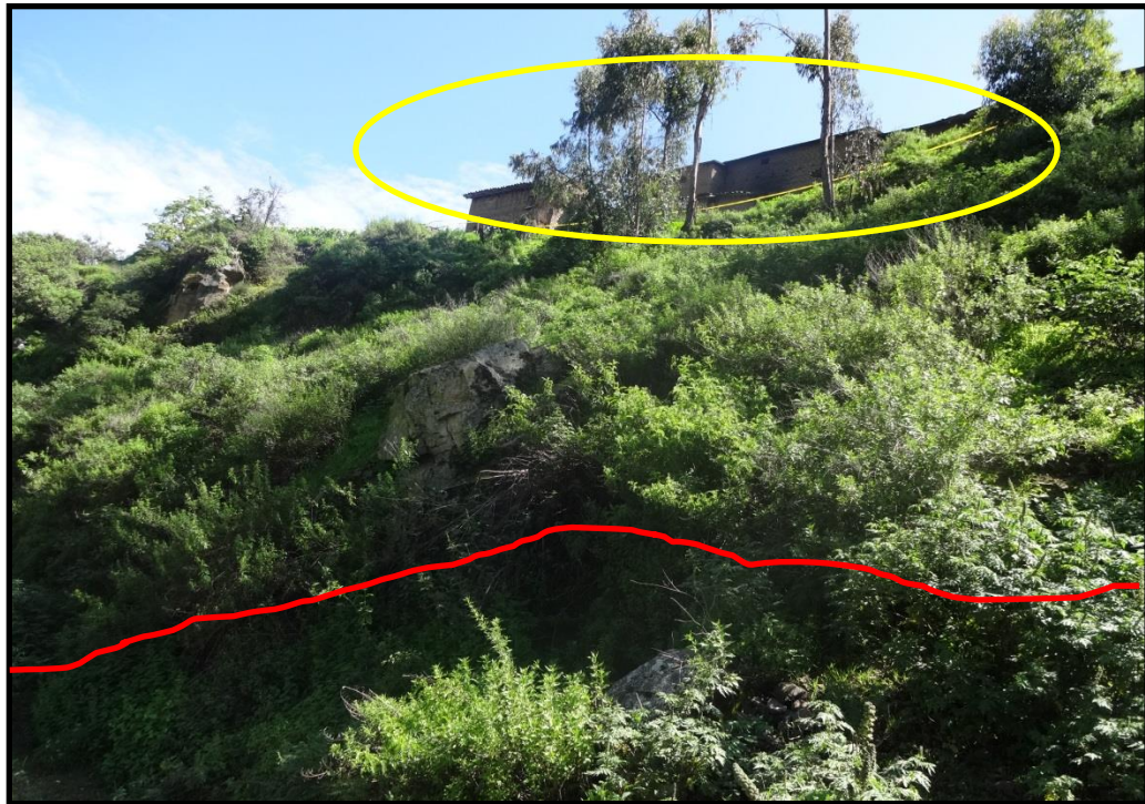
Foto 12: Parte del área urbana que podría ser afectada por el deslizamiento, círculo amarillo, al encontrarse la escarpa principal actual a 17m en la parte inferior (línea color rojo).
