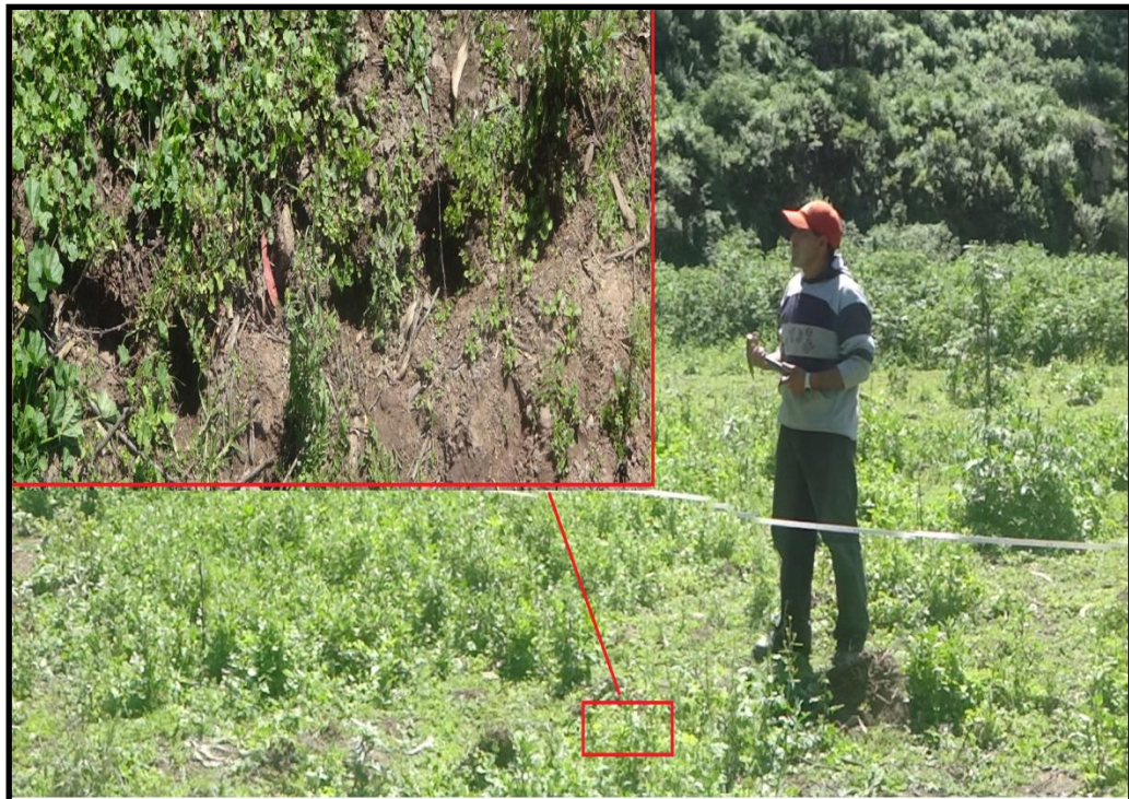
Foto 11: Grietas en el ex estadio del distrito de Huachos, zoom en la parte superior.
