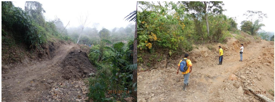
Foto 11. Vista tomada con dirección SO, donde se observa el levantamiento de la plataforma de carretera que es afectado por el movimiento del cuerpo deslizado (basculamiento).
