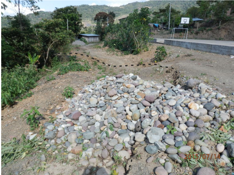
Foto 13. Vista tomada con dirección SO, donde se observa grietas de tracción con salto de 0.2m abertura de 0.1m
