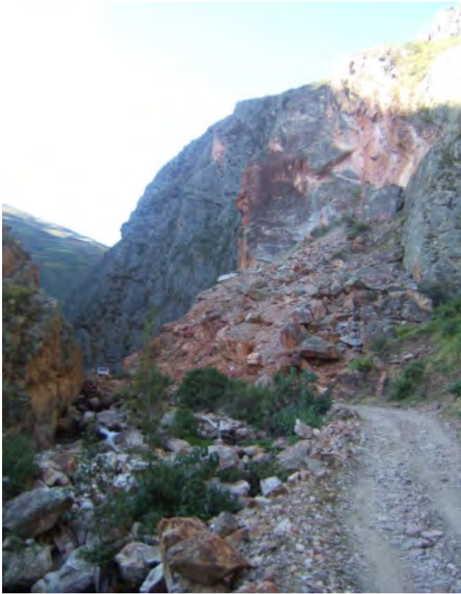
Foto 32 Deslizamiento traslacional en cuña, carretera Aija-Huarmey.
