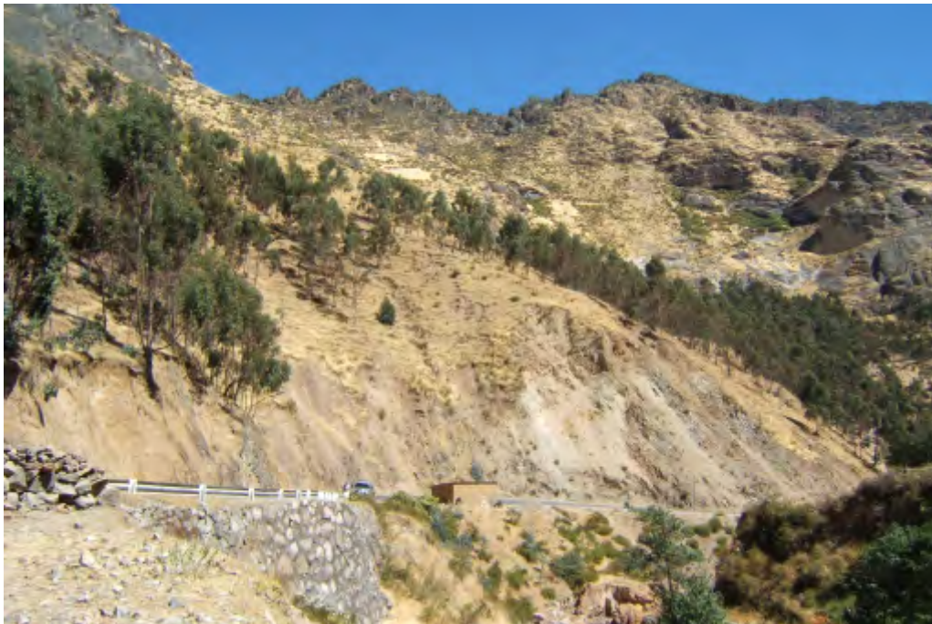
Foto 76 A Grandes derrumbes en al carretera Pativilca - Conococha (Mayorarca) que en cada temporada de lluvias (diciembre - marzo) sufren reactivaciones e interrumpen temporalmente la vía.
