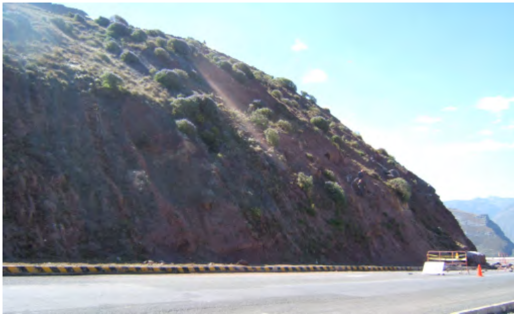
Foto 75A Carretera Conococha -Antamina, se aprecia caídas de rocas y derrumbes que podrían comprometer la capa asfáltica.
