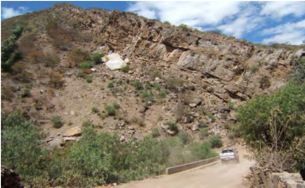
Foto 43 Taludes de carretera en rocas sedimentarias susceptibles a caída de rocas, derrumbes y vuelcos. Tramo entre Piscobamba y San Luis.
