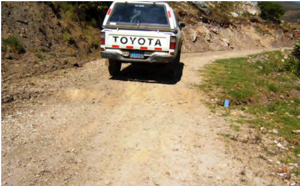
Foto21 Asentamiento en la plataforma de carretera que evidencia un deslizamiento de tierras en proceso de evolución.
