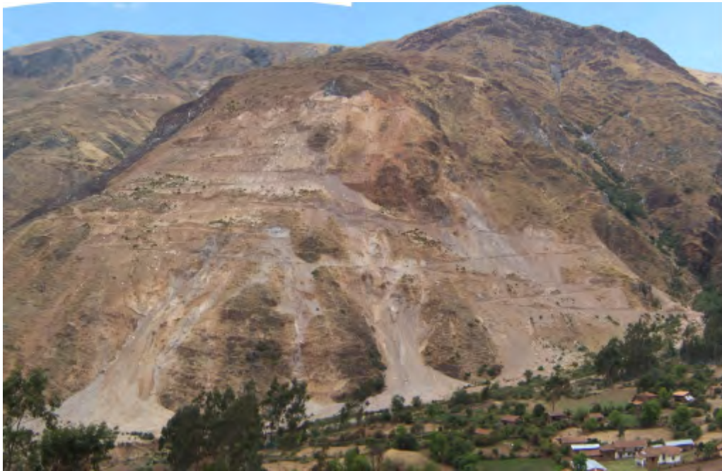
Foto 26 Derrumbes en un sector de la carretera Piscobamba-Chancasa-Sanachsgan recientemente construida, sobre una ladera de muy fuerte pendiente.
