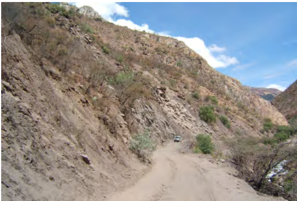
Foto 27 Sector de la carretera Yanama-San Luis afectada por derrumbes y caída de rocas que interrumpen el tránsito en el periodo de lluvias.
