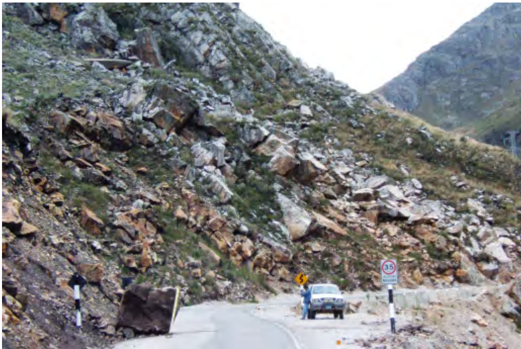
Foto24 Taludes de corte de un tramo de la carretera Huanzalá-Huallanca susceptibles a la ocurrencia de caída de rocas. Se aprecian un gran bloque caído sobre la vía, acumulación de canchales y el substrato sedimentario muy fracturado.
