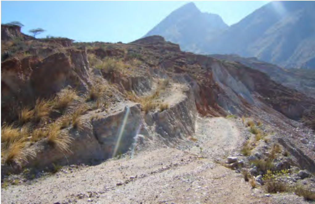
Foto 85 A Antigua carretera Yuracmarca - Sihuas abandonadas por haber sido destruida por el deslizamiento de Tres Cruces - La Pampa.
