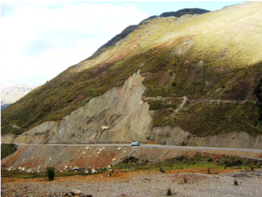
Foto 25 Colapso o derrumbe en la bajada del túnel Cahuish hacia Chavín. Es un área inestable que muestra una zona de arranque antigua encima, y reactivación reciente por el corte de la carretera. Se observa un muro de gaviones de 60 m de largo y 2 m de altura, y filtraciones de agua en el cuerpo.
