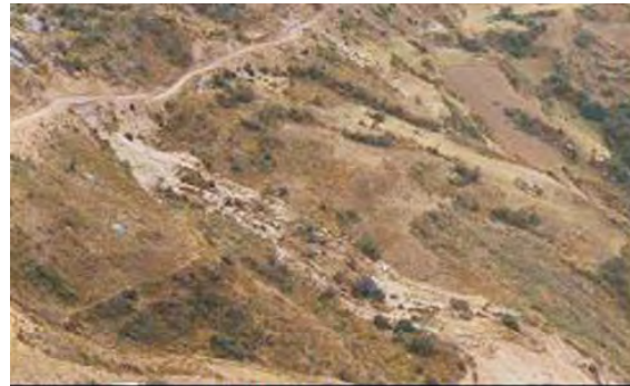
Control de talud inferior de carretera afectado por deslizamiento y asentamiento de plataforma (carretera a Quiches); muro de contención en cabecera de deslizamiento. Esto debería combinarse con otras técnicas para el control y estabilidad de laderas.
