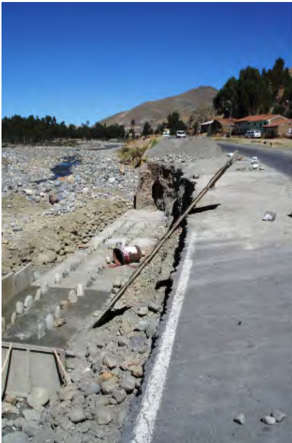
Foto 58 Dos vistas de procesos de erosión fluvial y socavamiento del talud en la margen izquierda del río Santa, sector de San Martín, Recuay, que afecta un tramo de la carretera a Huaraz. Nótese la construcción de una obra de mitigación en la vista inferior.
