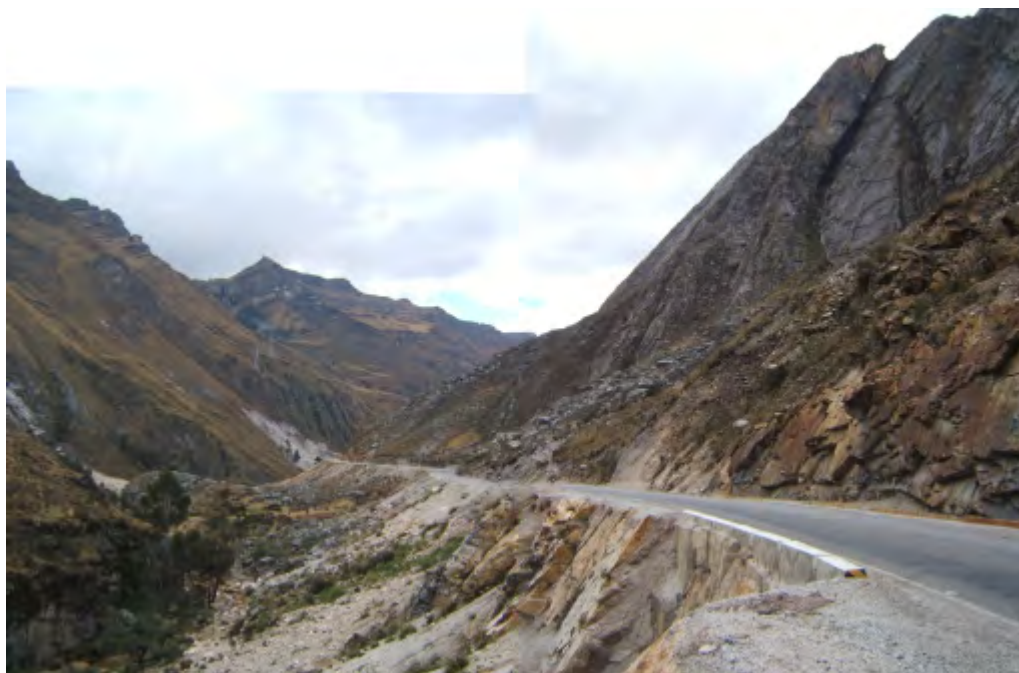
Foto 72B Valle del río Vizcarra, vista aguas abajo. Taludes y laderas susceptibles a deslizamientos, caída de rocas y derrumbes que afectan vía hacia Huallanca y La Unión.
