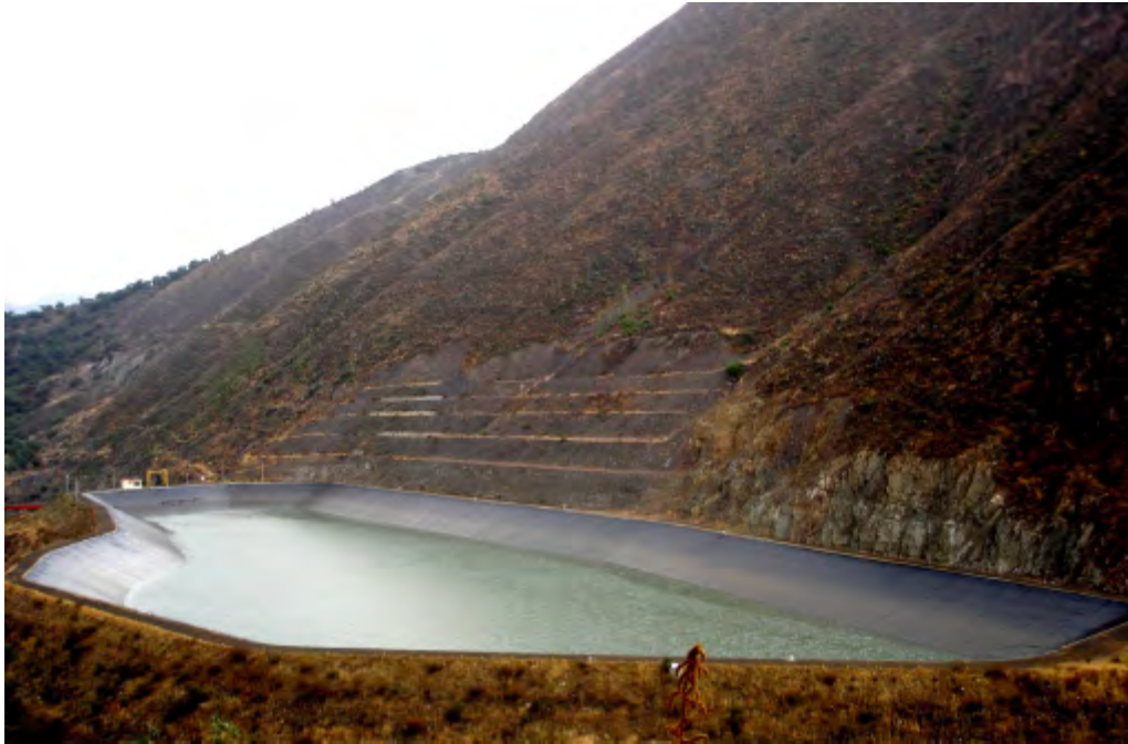
Foto86 Sector de la Represa de Duke Energy, afectada por un deslizamiento activo. Se distinguen las obras de estabilización.
