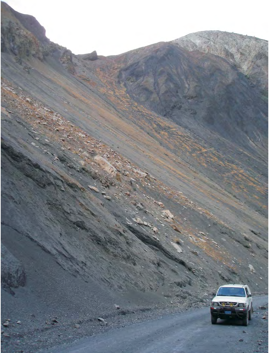
Foto 88 Tramo de la carretera Huallanca-Chuquicara afectado por caída de rocas y flujos de detritos.
