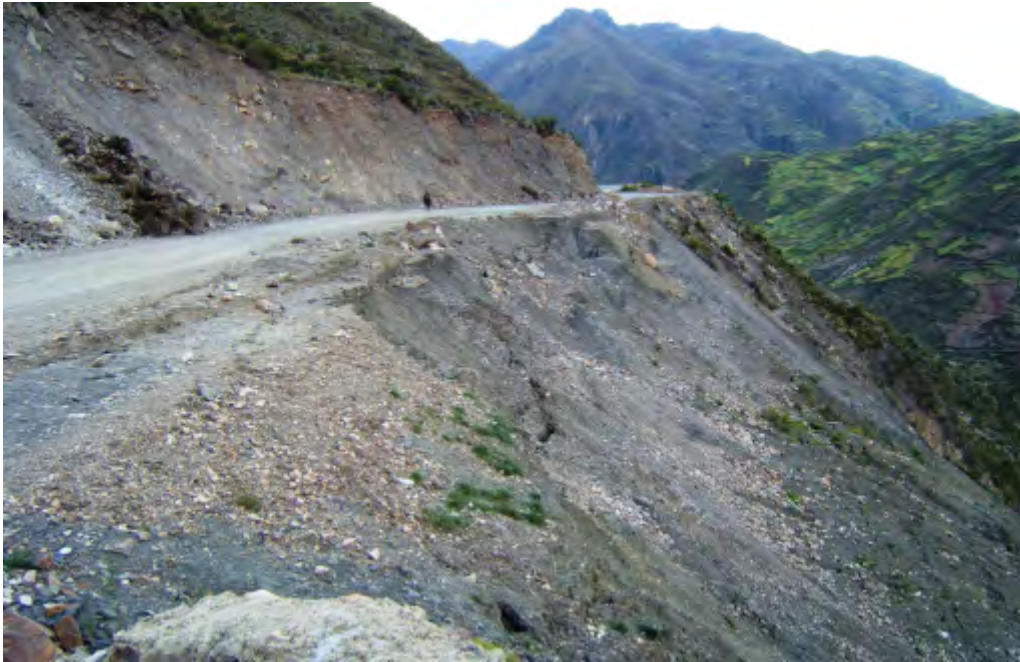
Foto 92 A Vista de la escarpa del deslizamiento en el Mirador Banderas (túnel de Cahuish-Chavin); se aprecia grietas de distensión y es reactivado en la temporada de lluvias (diciembre marzo).
