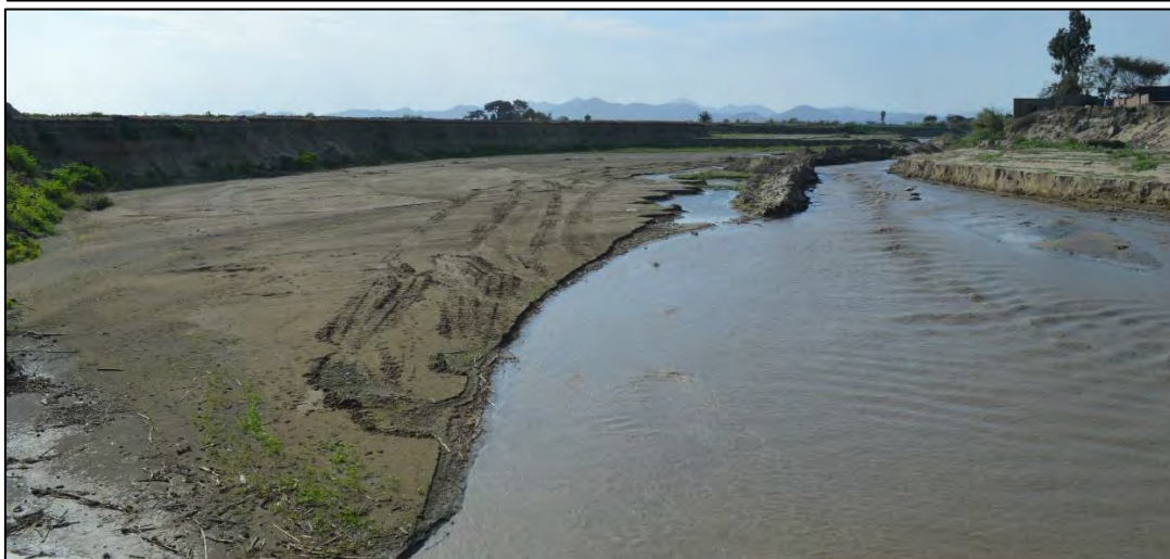
Fotos 12, 13 y 14: Inundación en el poblado La Cuadra, ubicado en la parte media de la cuenca Lacramarca. Se observa también el ensanchamiento de cauce (que originalmente era de 5m y tras la erosión fluvial se ensanchó a aprox. 100m)
