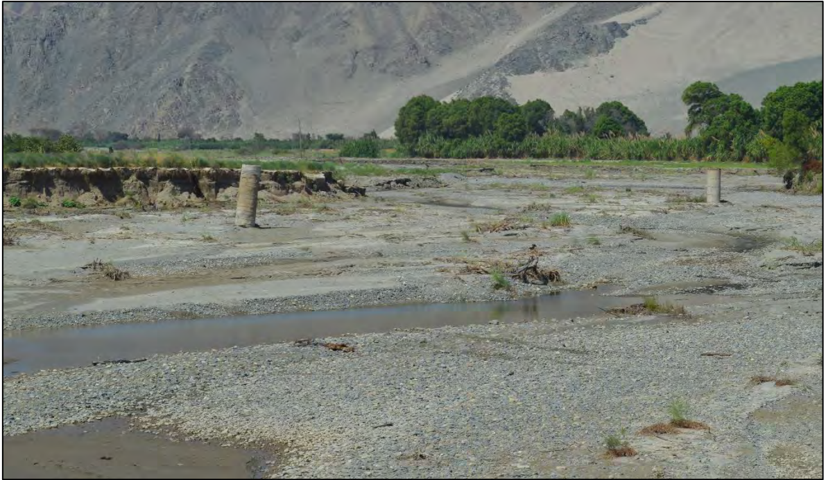
Foto 3: Pozos de captación de agua expuestos, tras el intenso socavamiento de cauce en la parte baja del valle de Huarney.
