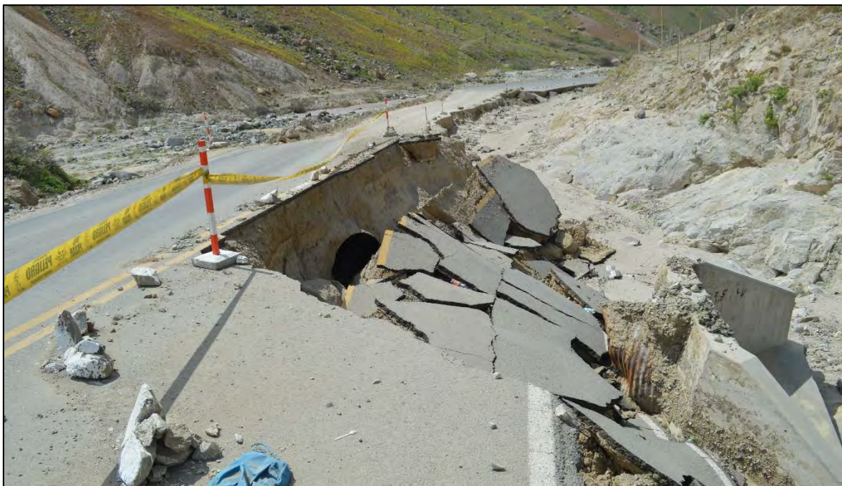
Fotos 5 y 6: Destrucción total de la carretera Casma – Huaraz, en el tramo Buena Vista Alta – Cachipampa, debido a la inundación de detritos y la ausencia de drenajes longitudinales.
