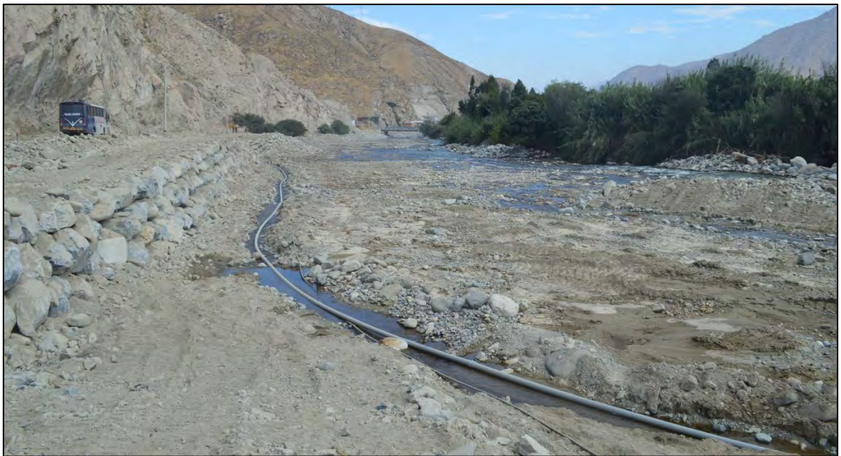
Fotos 15 y 16: Destrucción de un tramo de la carretera Barranca – Huaraz, cerca de Chasquitambo.
