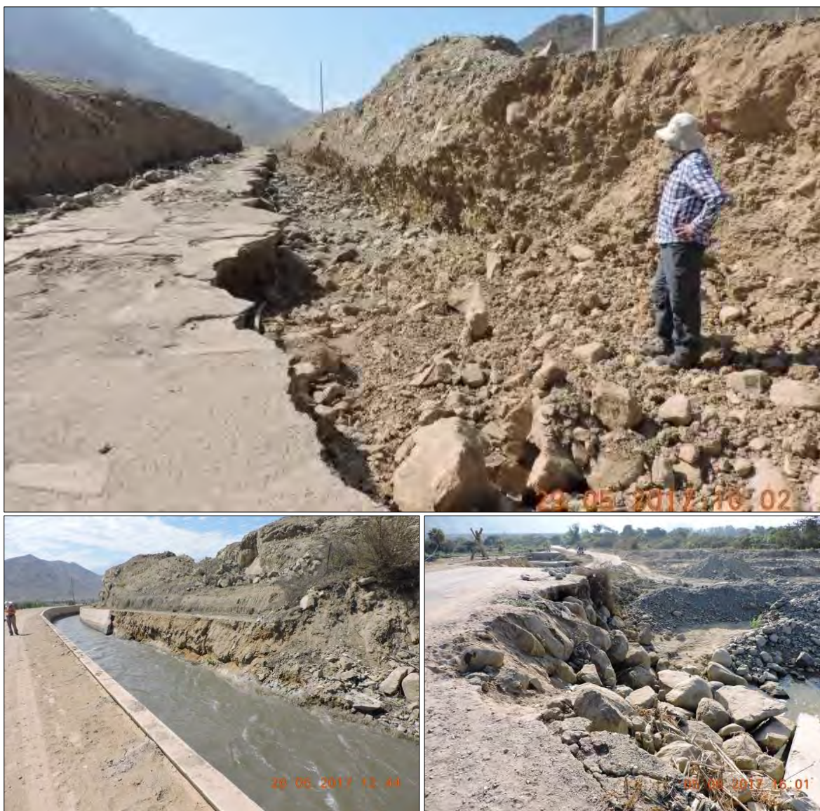
Fotos 28, 29 y 30: Daños ocasionados por flujos de detritos y lodo. A. Vista de la destrucción total de un tramo de la pista que conecta las ciudades de Casma y Huaraz. Vista tomada hacia el noreste. B. Vista de la destrucción de un tramo del canal de irrigación del proyecto Chincas. Vista tomada hacia el noroeste. C. Destrucción total del tramo que atraviesa el río Nepeña y parte del puente que atraviesa el mismo río. Vista tomada hacia el Norte.
