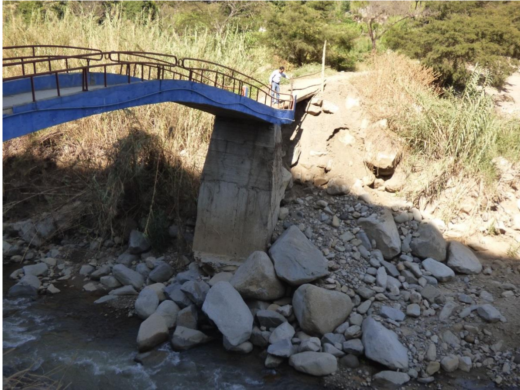
Foto 31. Puente peatonal afectado por la erosión fluvial en el distrito Cascas, provincia Gran Chimú, La Libertad.
