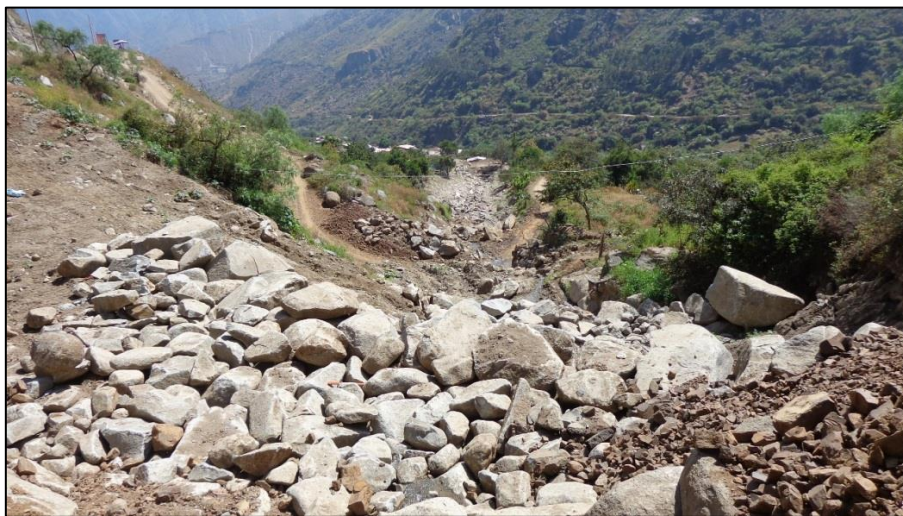
Foto 11. Flujo de detritos con clastos de tamaño variable, desplazados por una quebrada secundaria provocando el bloqueo de carretera y daños en tuberías de filtración de agua. Localidad Paday, distrito Salpo. Vista al NO.
