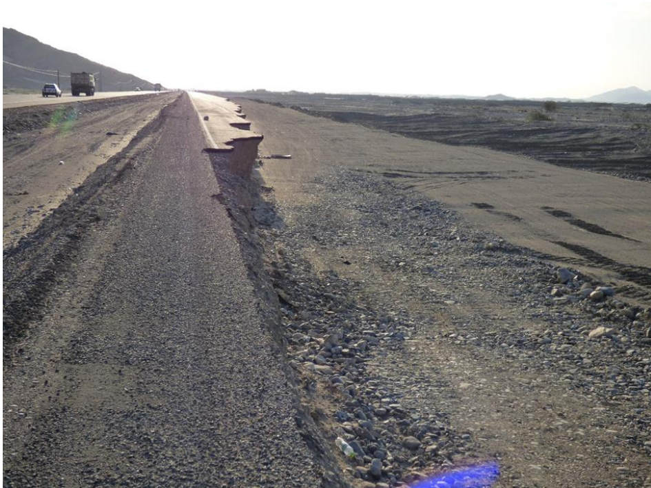
Foto 21. Erosión fluvial de la carpeta asfáltica en el Km 661, carretera Panamericana Norte. Distrito de San Pedro de Lloc, provincia Pacasmayo, La Libertad.
