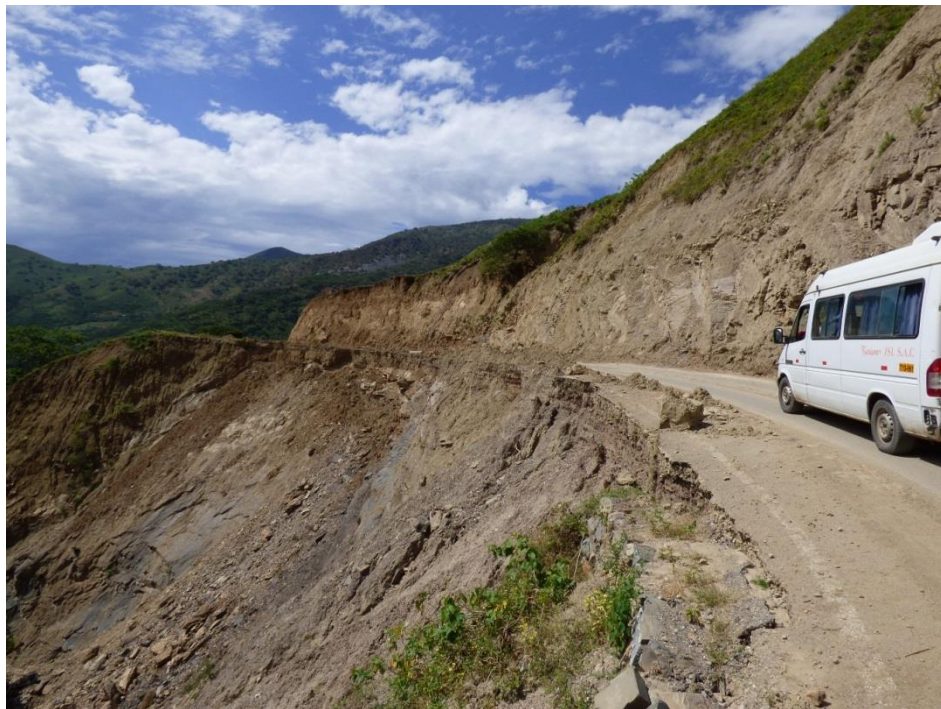
Foto 17. Derrumbe en el talud inferior de la carretera Chilete – Contumazá; Sector Santa Rosa del Rupe, distrito Chilete, provincia Contumazá, Cajamarca.
