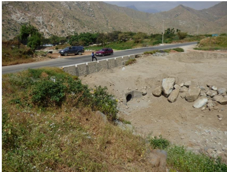
Foto 14. Alcantarilla de dimensiones inadecuadas que fue cubierto por flujos provenientes de la quebrada Las Viejas. Distrito Yonán, provincia Contumazá, Cajamarca.
