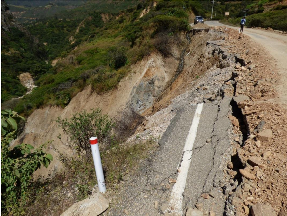
Foto 16. Derrumbe en el talud lateral de la carretera Chilete – Contumazá. Sector Nansha, distrito y provincia Contumazá, Cajamarca.
