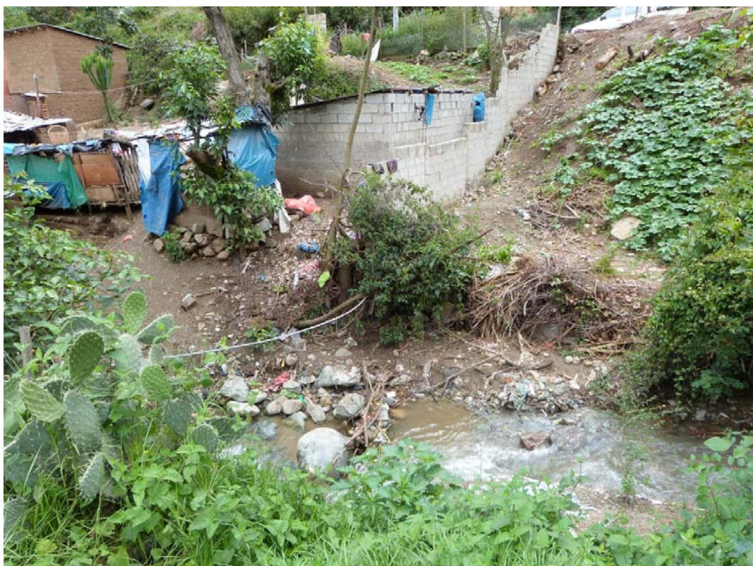
Foto N° 4: Invasión de los espacios públicos hidráulicos por construcción de viviendas Qda. Marcahuasi
