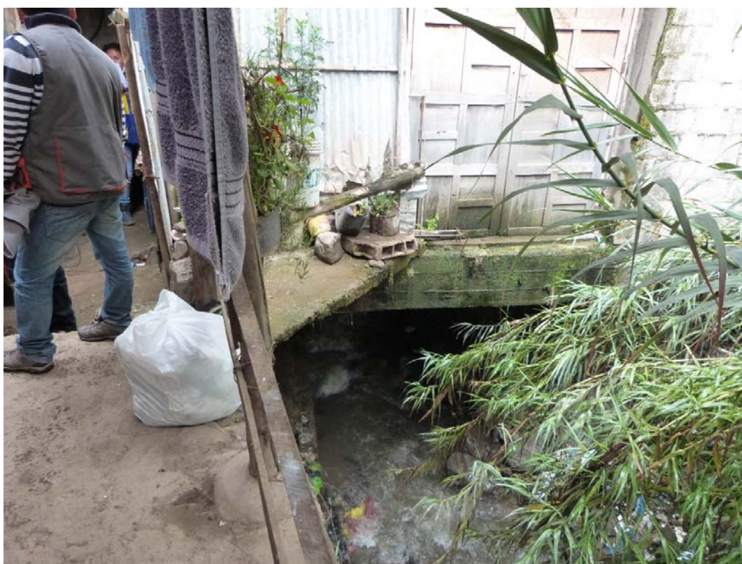
Foto N° 14: Viviendas construidas sobre el cauce, quebrada Saahuanay
