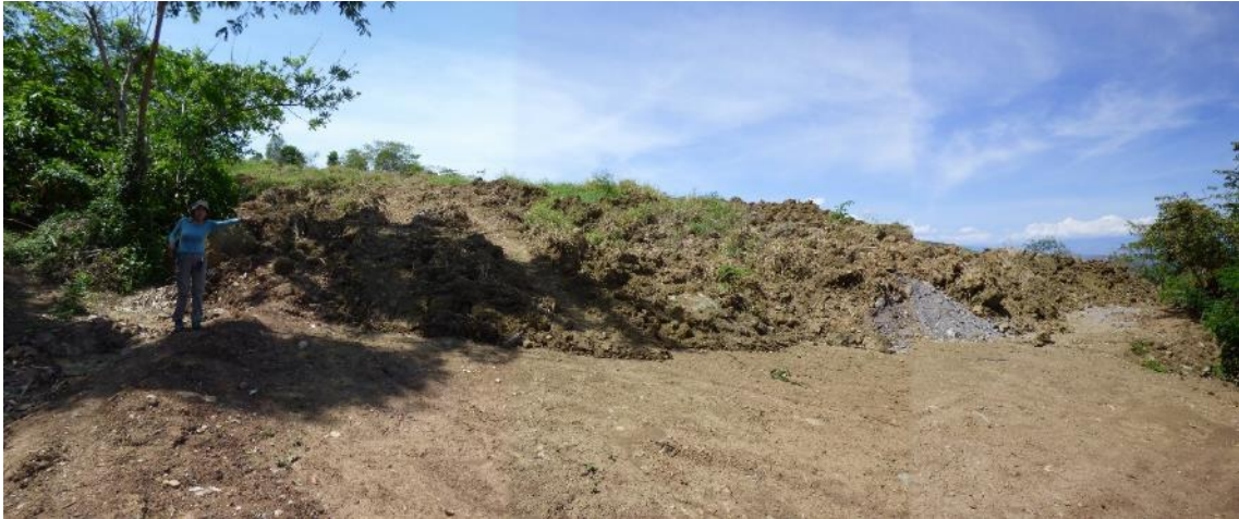
Foto 13. Calle colindante del sector de Copallin, cubierta por el material removido.
