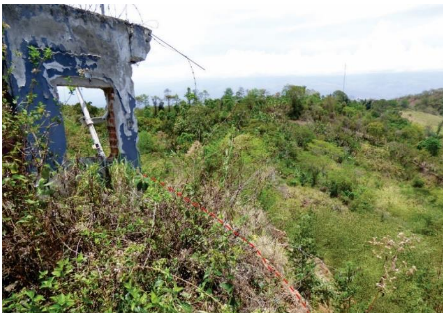
Foto 10. Caseta telefónica y poste de tendido eléctrico destruidos. Con línea roja se señala la escarpa principal del deslizamiento.
