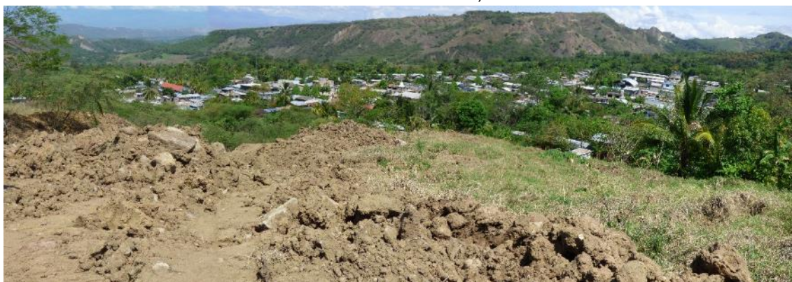
Foto 12. Se muestra el poblado de Copallin y la zona removida por el deslizamiento.
