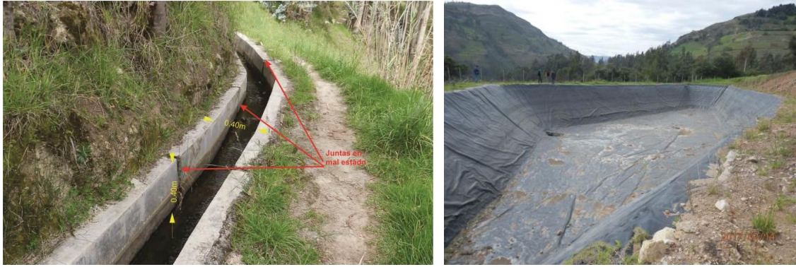
Foto 5. Vista de canal de regadío ubicada por encima de escarpa principal, se observa las juntas en mal estado (izq.).
