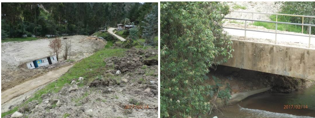
Foto 8. Vista tomada al pie de la ladera, se observa vivienda afectada por el movimiento, también agrietamiento en el estribo de puente Lluscapampa.
