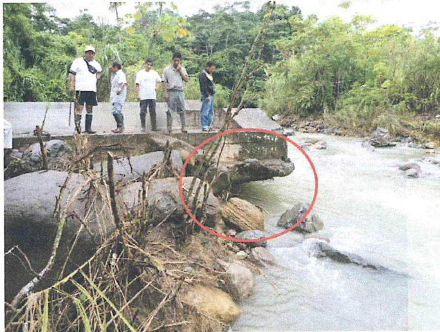
Foto 11: Erosión fluvial en el margen derecho del río Pacota, muestra de ello es el socavamiento causado en los cimientos de la bocatoma de la localidad Las Palmeras. Fuente: Municipalidad de Nuevo progre, febrero 2015.
