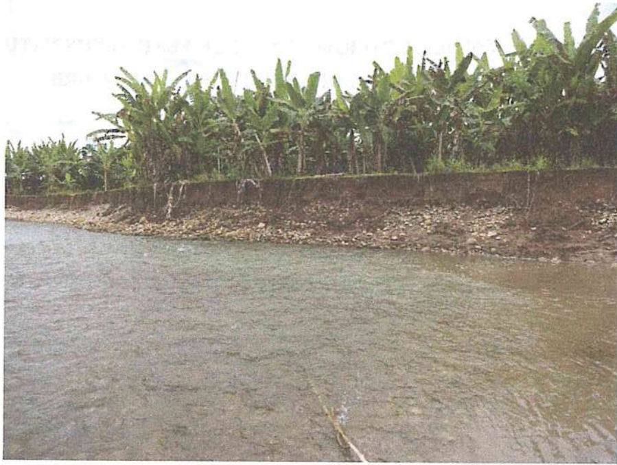
Foto 09: Procesos de erosión fluvial identificados en ambos márgenes del río Pacota que podrían afectar zonas de producción agrícola (platanales, entre otros), ubicadas a 230 m al sur de la zona urbana.
