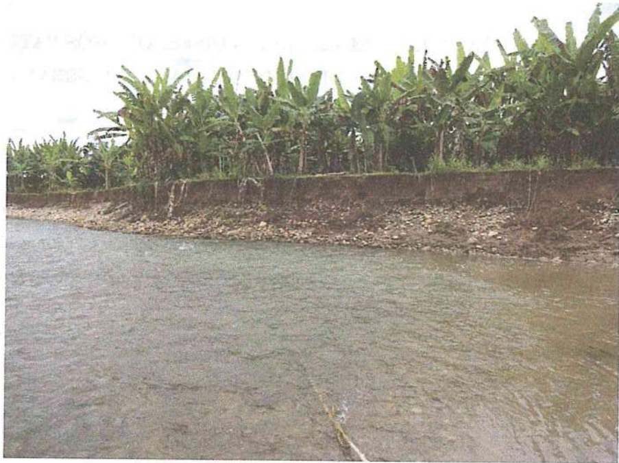
Foto 09: Procesos de erosión fluvial identificados en ambos márgenes del río Pacota que podrían afectar zonas de producción agrícola (platanales, entre otros), ubicadas a 230 m al sur de la zona urbana.
