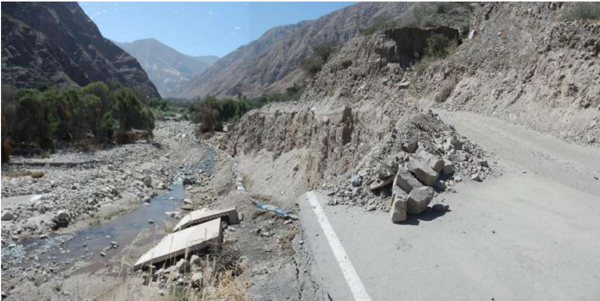
Foto 8. Derrumbe y colapso de plataforma en carretera Ingenio-Otocha (Palmar Alto) (6B-192)
