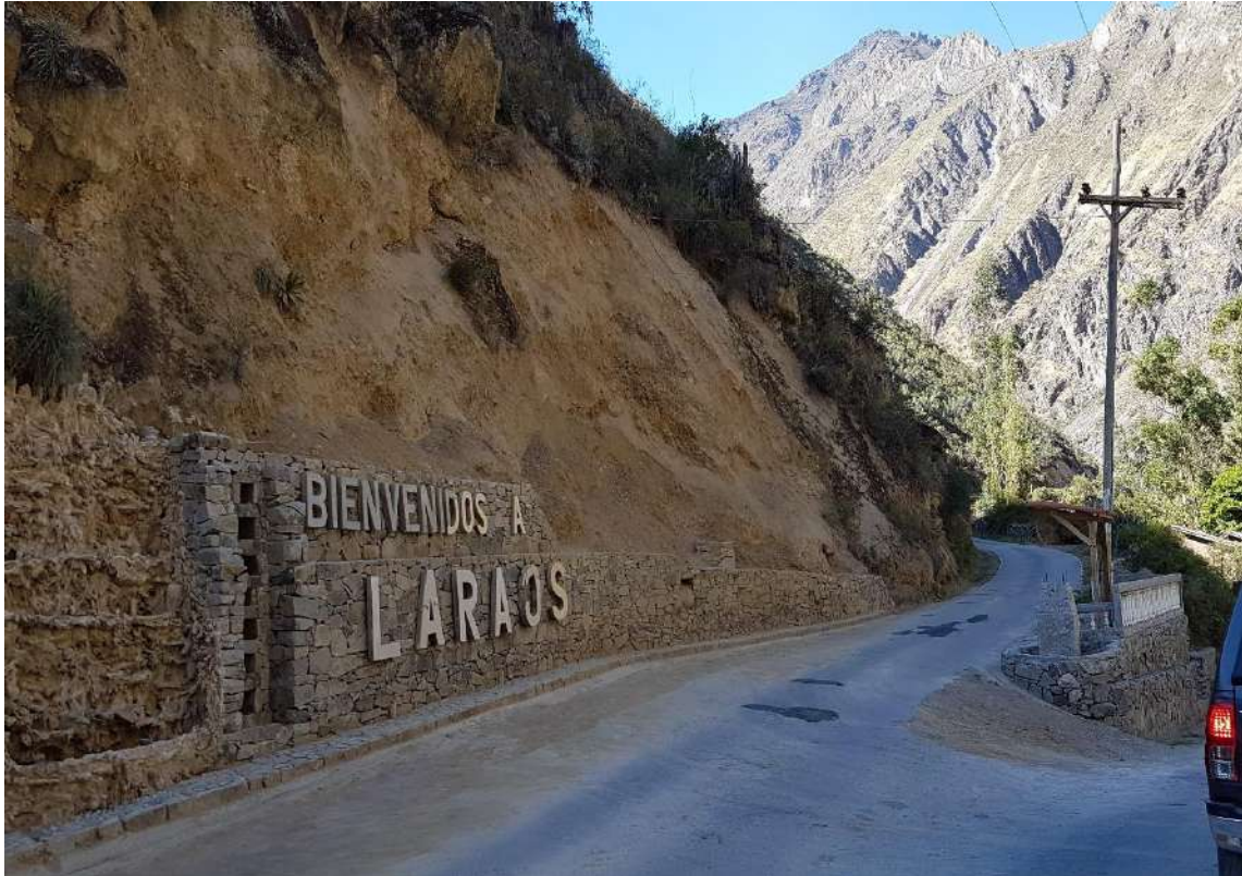
Foto 17. Derrumbe en muro de entrada a Poblado de Laraos. Afectación en gaviones y hundimiento en plataforma (6B-157).
