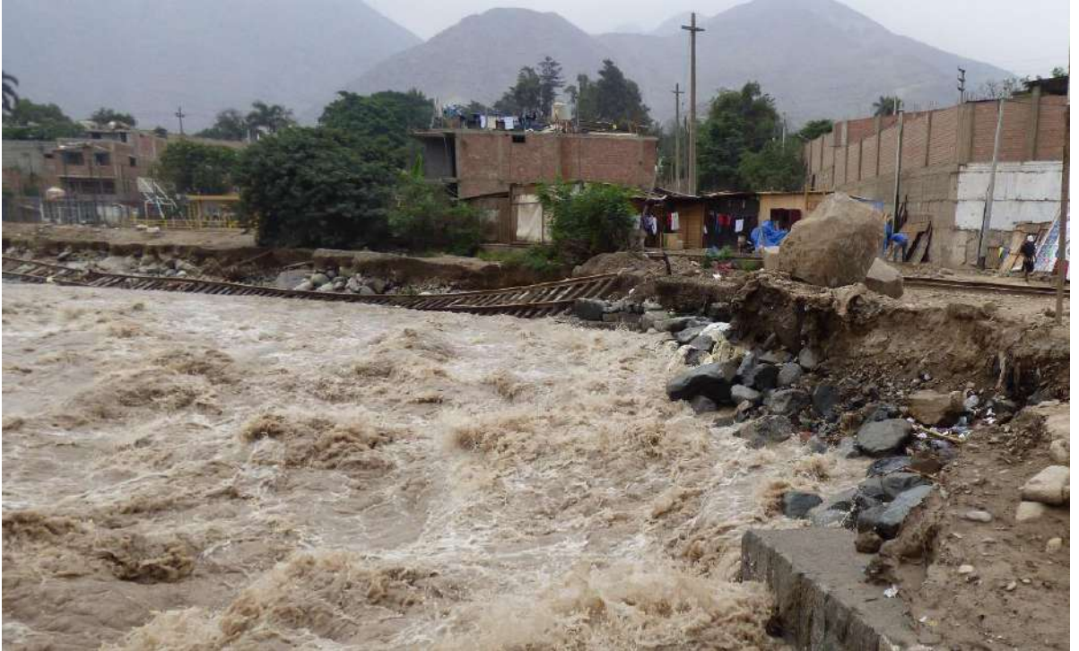
Foto 32. Vía del Ferrocarril Central- altura de Puente Caracol -Sector Los Cañaverales afectado por erosión fluvial (6C-114).
