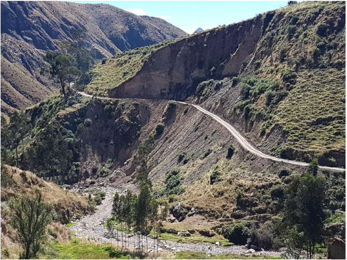
Foto10. Derrumbes en la carretera Chocos-Azángaro (6B-094).
