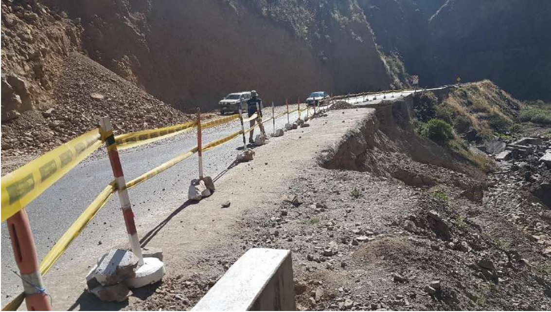
Foto 7. Derrumbe y agrietamiento en la plataforma de la carretera Central en km.82 (6B-008)
