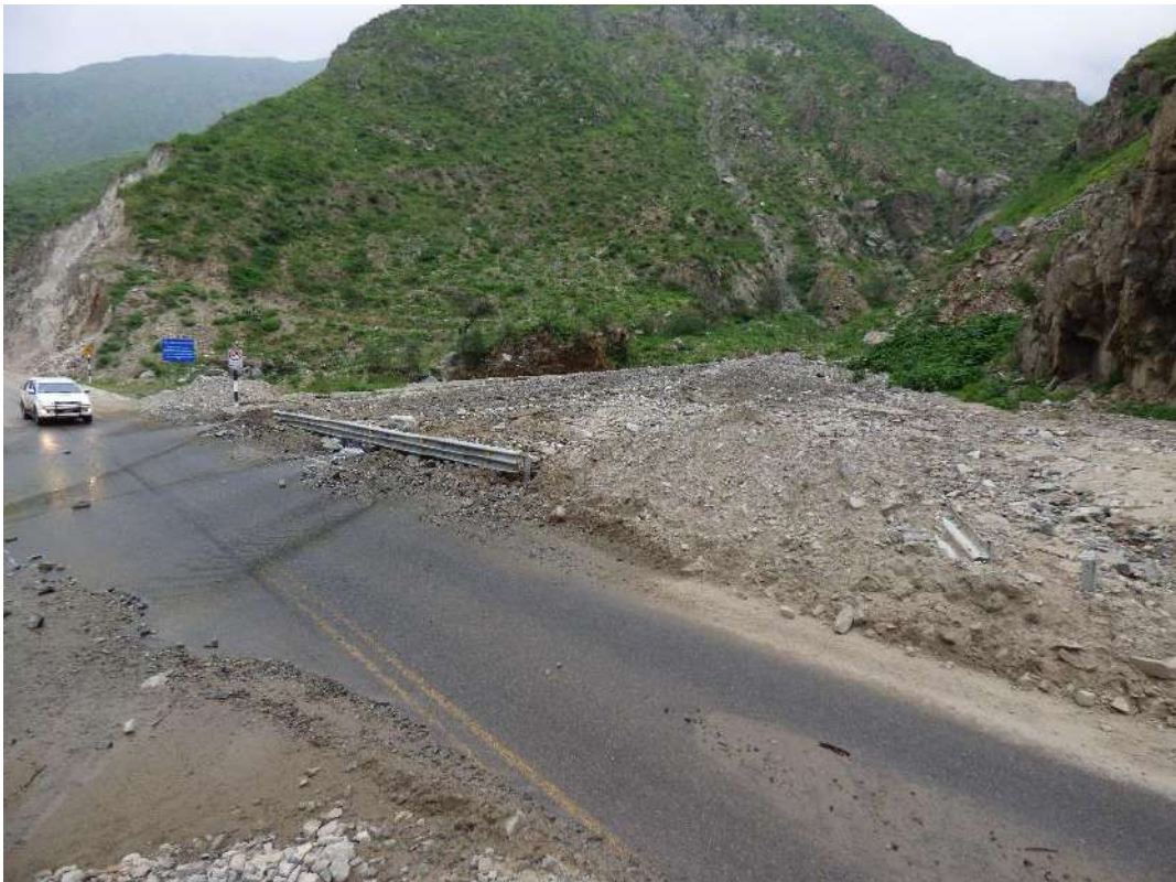
Foto 42. Quebrada Condorpampa / carretera Lima – Canta, afectado por flujo de detritos dañando la infraestructura vial (6C-191).
