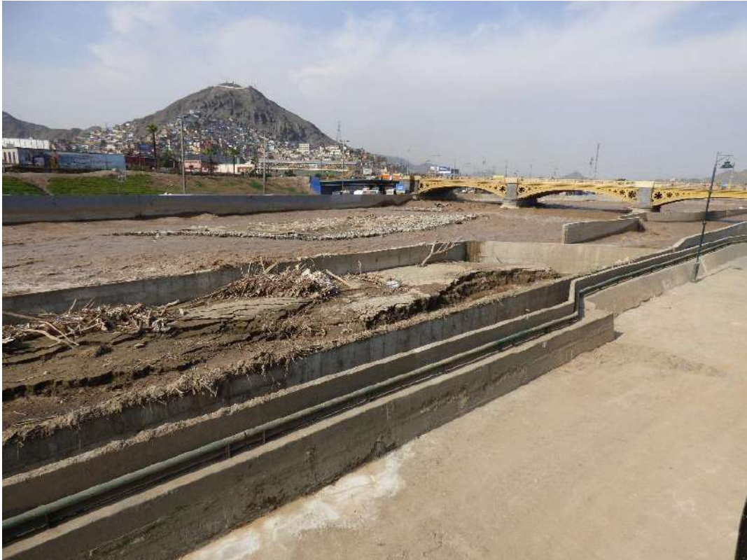
Foto 43. Parque La Muralla, afectado por inundación fluvial, infraestructura cubierto por lodo (6C-138).
