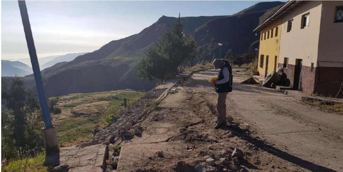
Foto 27. Asentamiento en el sector Langa, (6B-015), al ingreso del poblado, la carretera, la vereda y el poste de alumbrado eléctrico se ven afectados evidenciándose la remoción del terreno y grietas, producto de los cauces de los cursos de agua de las precipitaciones.
