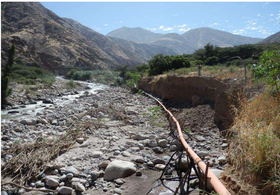
Foto 14. Erosión fluvial y derrumbe de canal de regadío en Sector Palmar Alto (6B-190).
