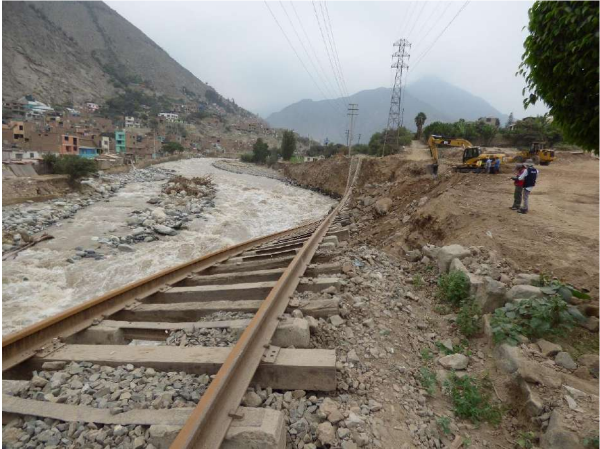
Foto 33. Sector La Perla en Chosica (6C-052). Erosión fluvial que afectó a vía férrea en un tramo de 80 m.
