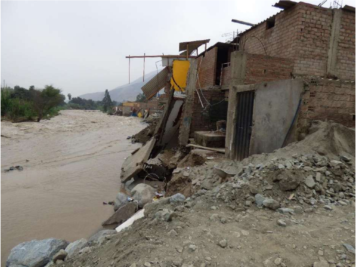
Foto 31. Sector Santa María (6C-033), casas afectadas por la erosión fluvial.
