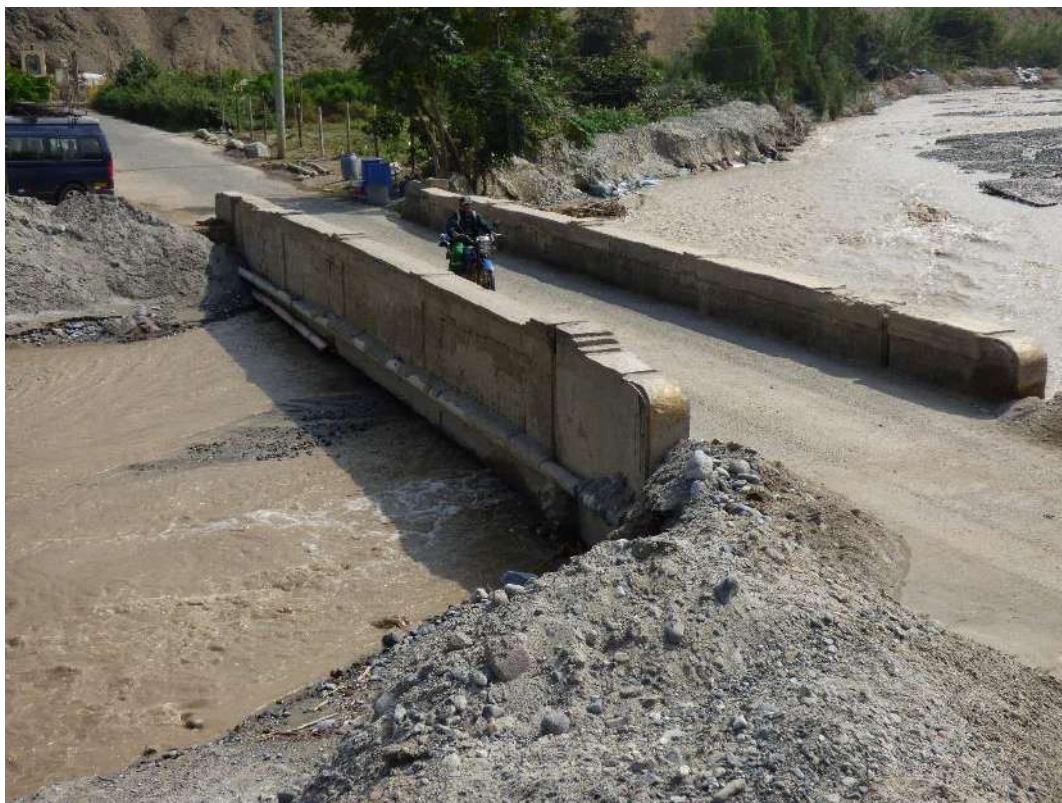
Foto 45. Puente La Esquina 8 (Asia), se observa cauce colmatado y defensas ribereñas en mal estado, quedando la estructura del puente expuesto y en mal estado.
