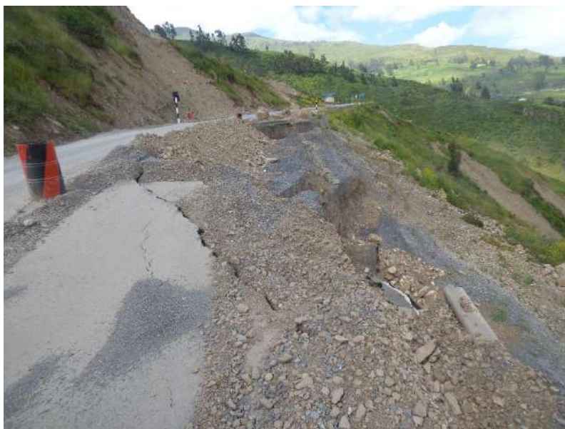
Foto 49. Vistas de la reactivación de un deslizamiento que afecta un tramo importante de la carretera Canta – La Viuda - Huayllay (6A-104, 6A-105,6A-106,6A-107).
