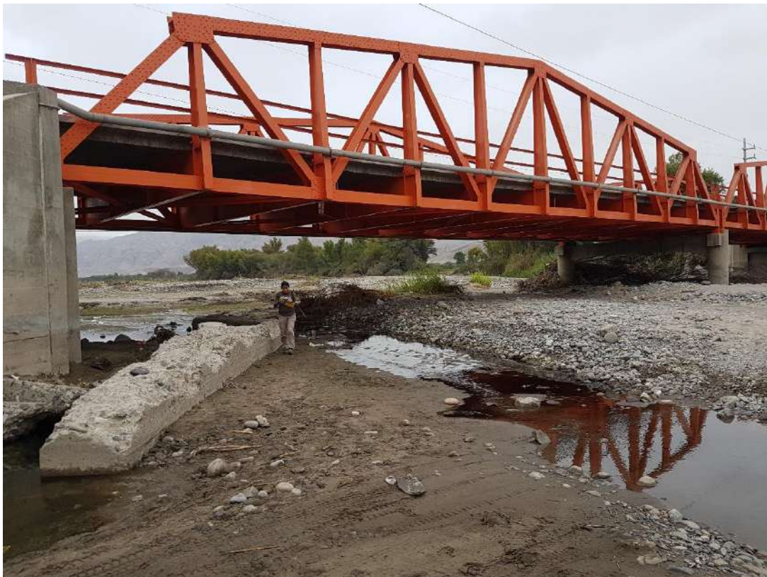
Foto 6. Colmatación de estribos en margen derecho del rio Grande (6B-204)
