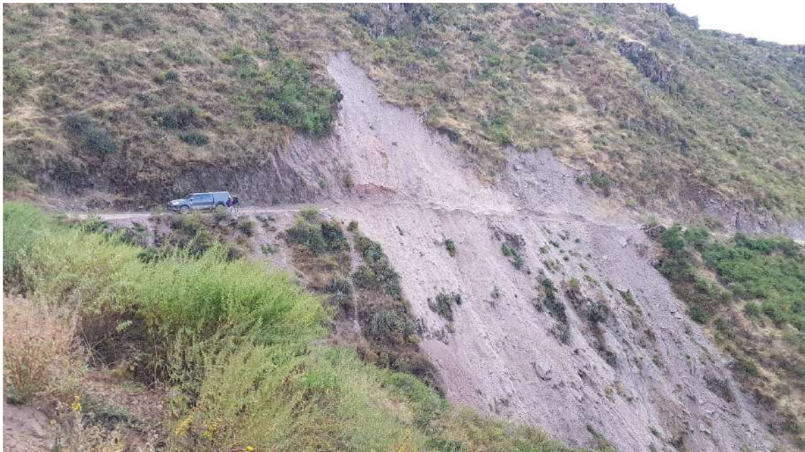
Foto 12. Derrumbes flujos en carretera Santo Domingo de los Olleros-Huallanchi (GB-016).
