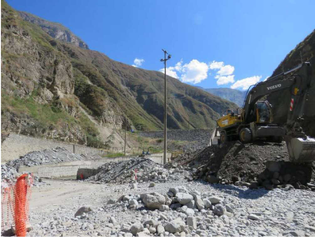
Foto 47. Bocatoma de la central hidroeléctrica Huinco (6A-037), afectada por dos huaycos que cubrieron los canales de desfogue, colmatando la estructura hasta en 1.5 m de bloques, arena y limos.
