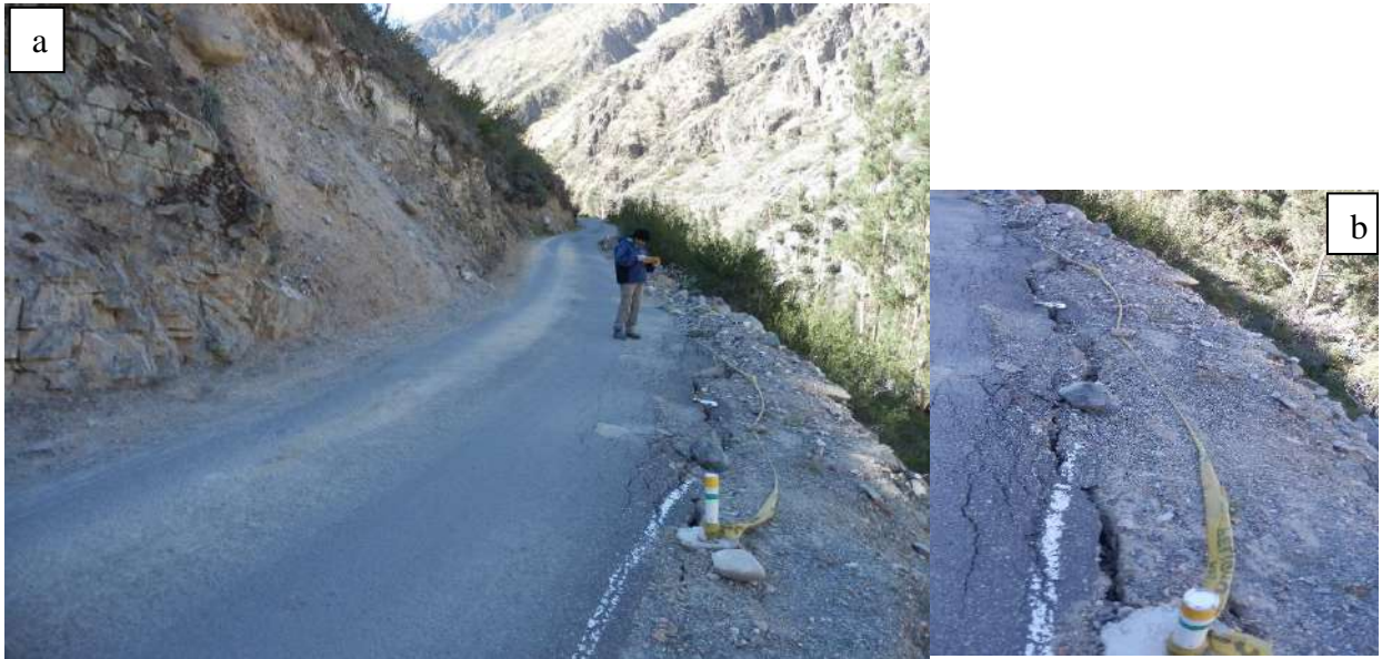
Foto 3. (a). Derrumbes y asentamientos en la carretera a Laraos, (b) Agrietamientos y fisuras en terraplén (6B156)
