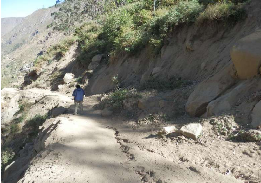
Foto 5. Derrumbe y colapso de un sector de terraplén de carretera de conexión a Tupe (6B-113)
