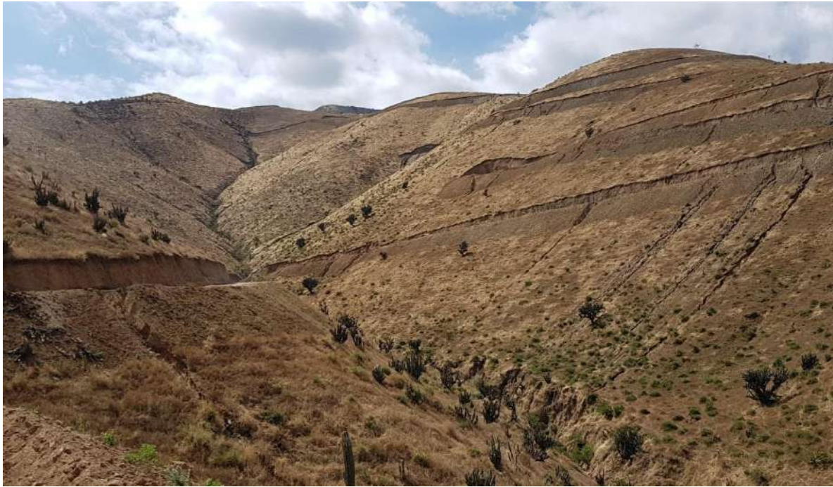
Foto 11. Erosión de laderas laminares en talud de corte de carretera Santo Domingo de los Olleros- Santa Rosa-Pampapacta (GB-019).
