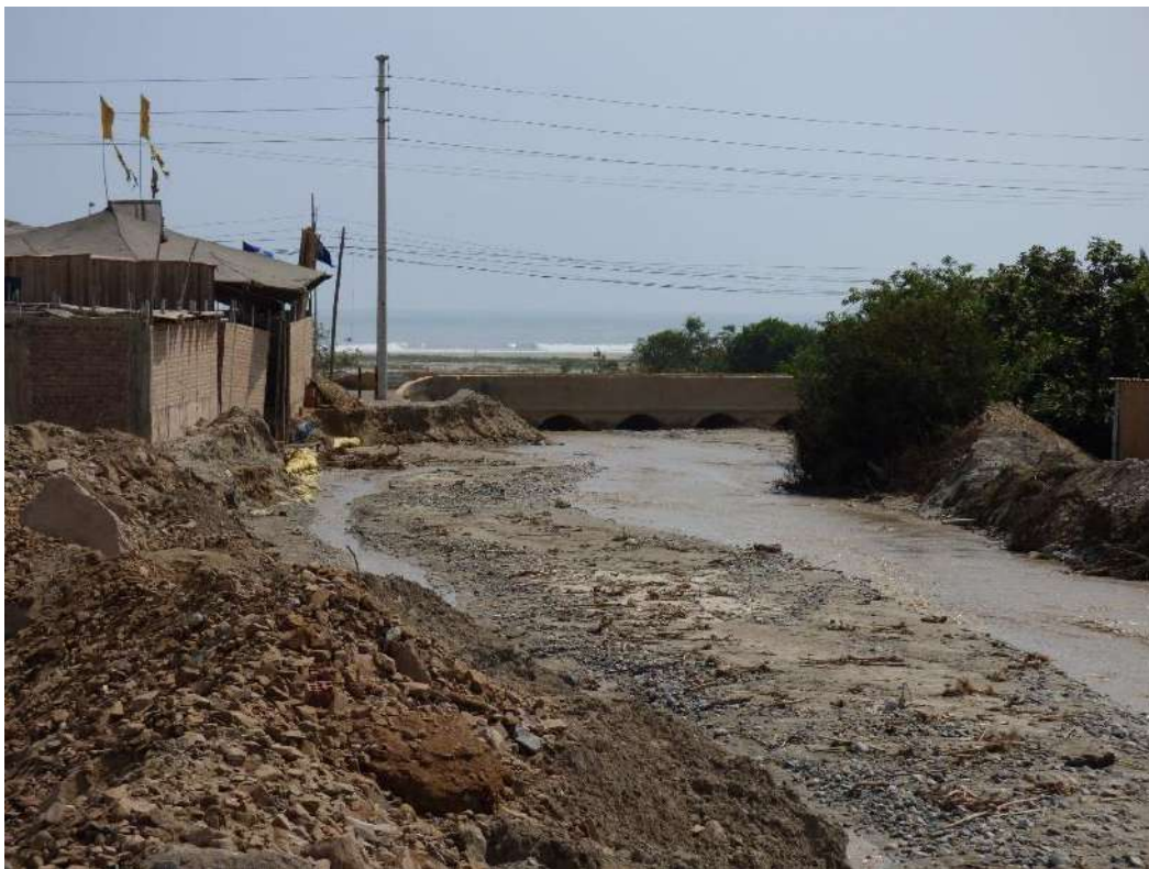
Foto 40. Poblado Rosario de Asia, se observa vivienda afectado sus cimientos por erosión fluvial, también se observa cauce colmatado cubriendo la mitad de la alcantarilla (6C-229).
