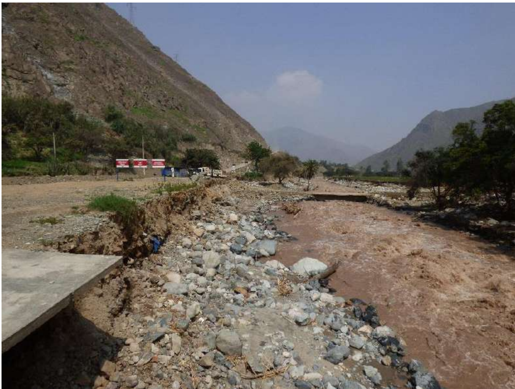
Foto 44. Puente de acceso al poblado Magdalena (Yangas), afectado por erosión fluvial y flujo de detritos, quedando la estructura del puente en mal estado (6C-168).
