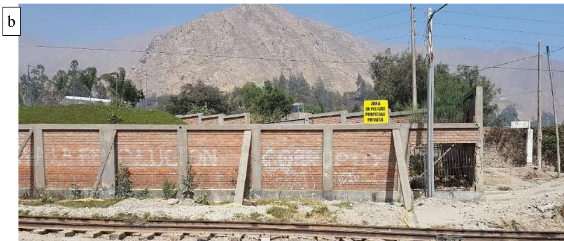
Foto 24. Flujos de lodo en el sector Piedra Grande (6B-001). (a) Los flujos causaron destrozos en muros de contención, alcantarillados colapsados (Complejo recreacional).
