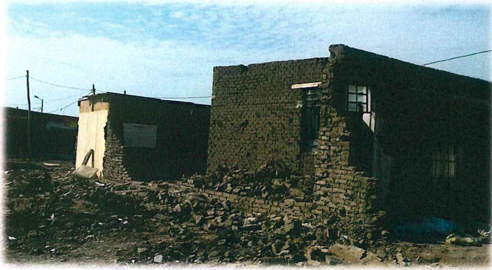
Foto N° 13, 14 y 15: Viviendas colapsadas y afectadas por lluvias intensas
