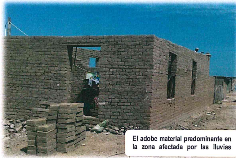
Foto N° 7, 8 y 9: Viviendas con Vulnerabilidad Alta
