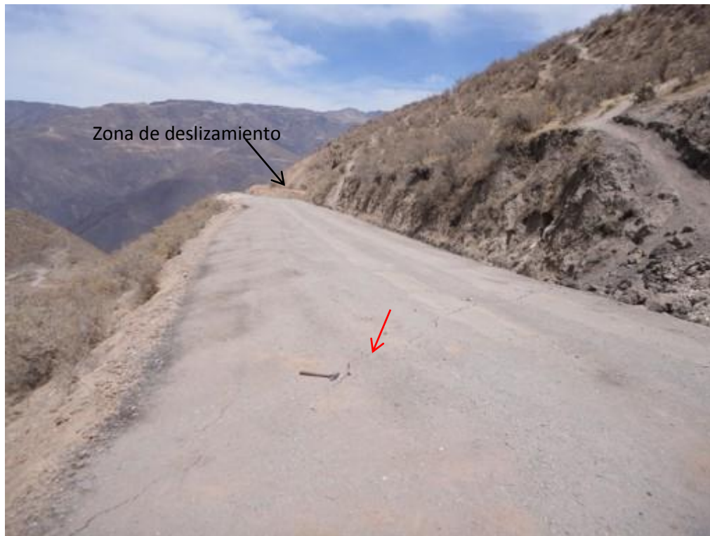
Foto 15: Vista donde se señala con flecha roja las grietas que cortan la plataforma de carretera, localizada a 70 m del flanco izquierdo del deslizamiento.
