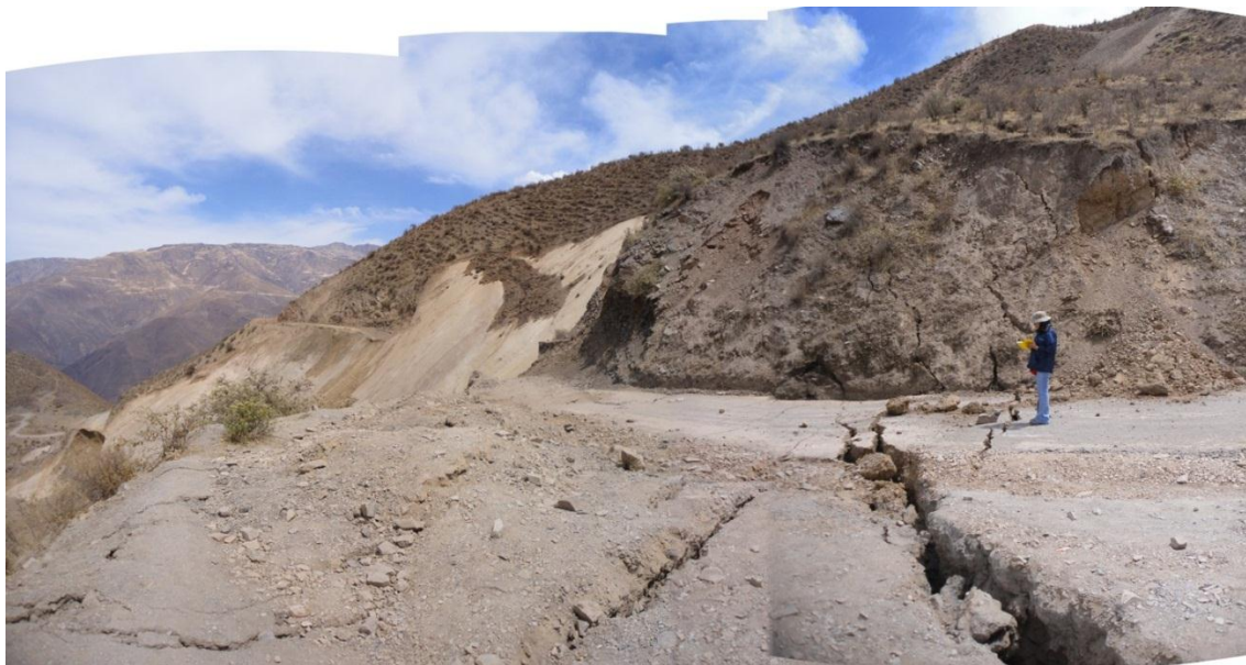
Foto 10: Flanco izquierdo del deslizamiento, donde se puede observar los agrietamientos abiertos en la plataforma de carretera, zona inestable.
