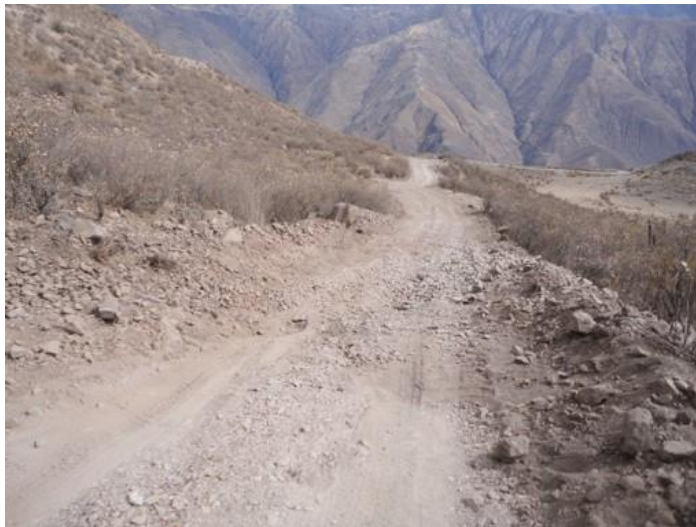
Foto 19: Vista de zona donde se presenta irregularidades y hundimiento en la variante de carretera.
