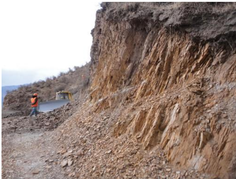
Foto 7: Lutitas negras muy fisibles, localizadas encima del deslizamiento, donde se está construyendo la variante de carretera.
