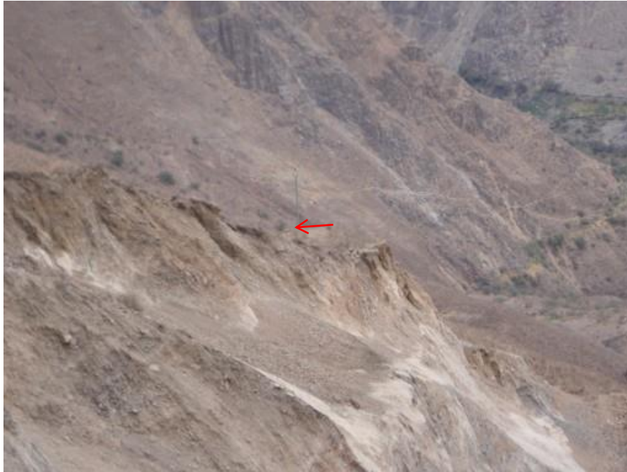
Foto 16: En la vista se muestra (flecha roja) la ubicación de poste de trasmisión eléctrica, ubicado muy cerca de la zona de deslizamiento.
