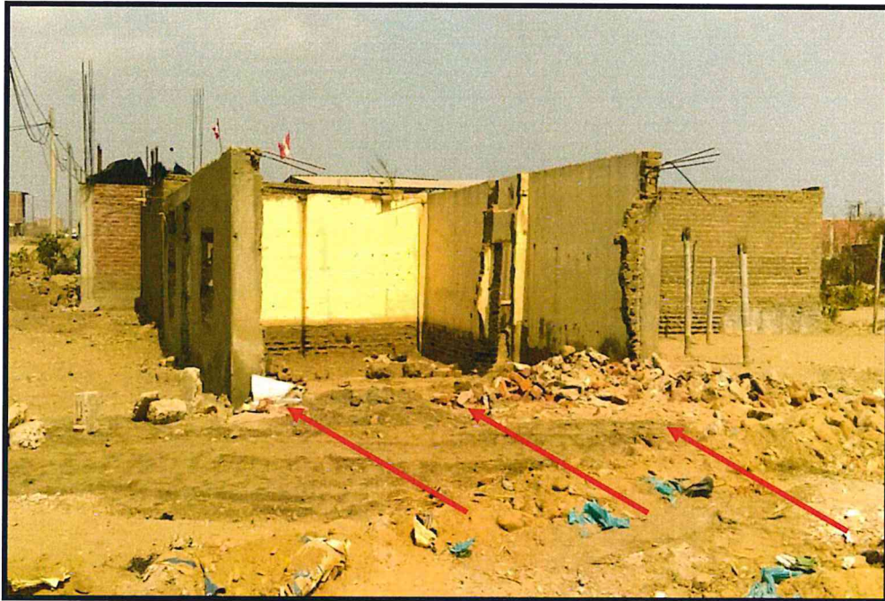
Fotografía N° 1: Viviendas destruidas dada la ocurrencia de la inundación pluvial de la activación de la Quebrada León
