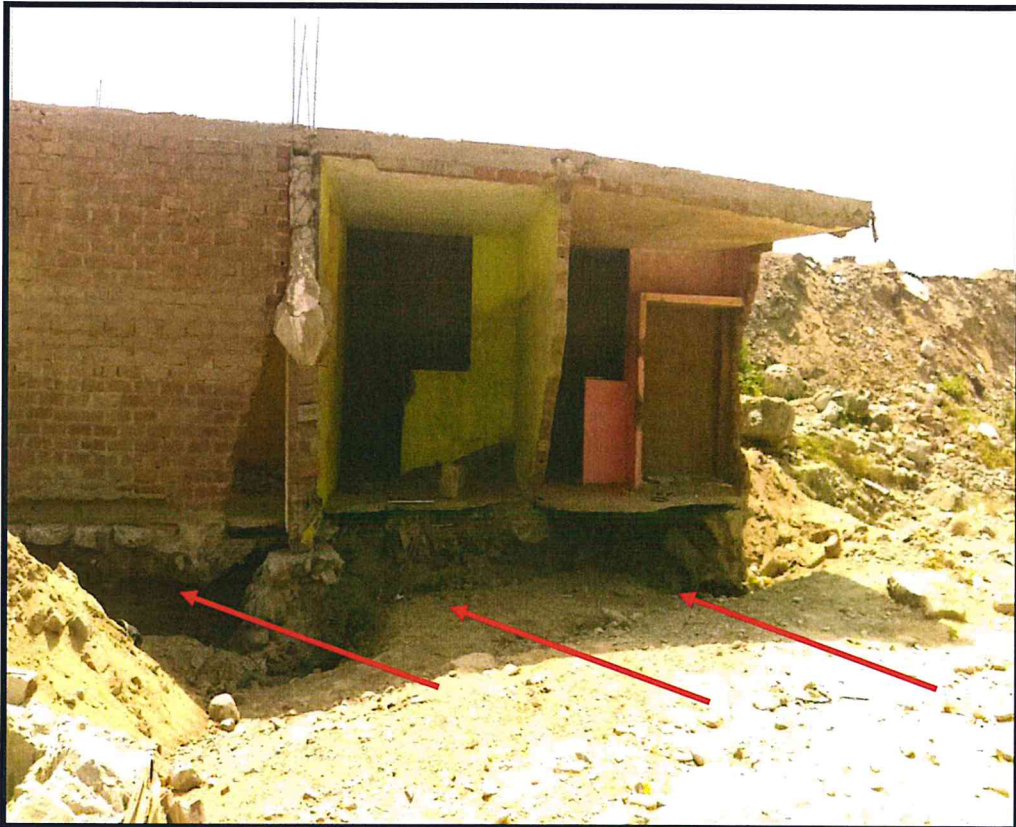
Fotografía N° 4.- Vivienda construida en el cauce de la Quebrada León. Asentamiento Humano Sol Naciente II
