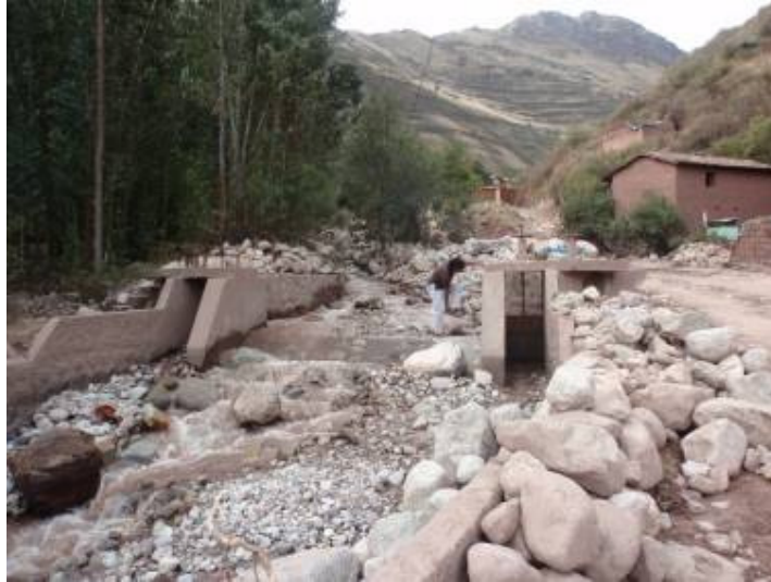
Foto 40: Bocatoma colmatado con el flujo aluviónico reciente.
