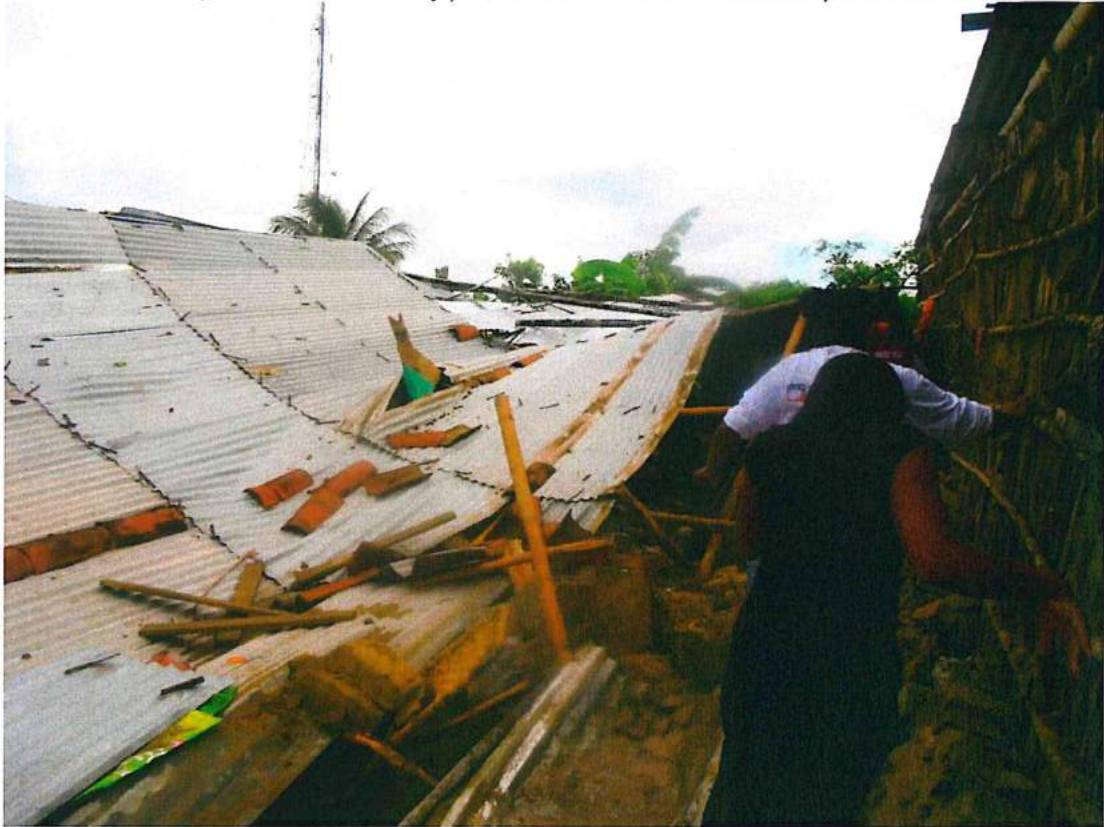
Foto N° 1, 2: Daños en techos y paredes de viviendas ocasionados por el FEN 2017
