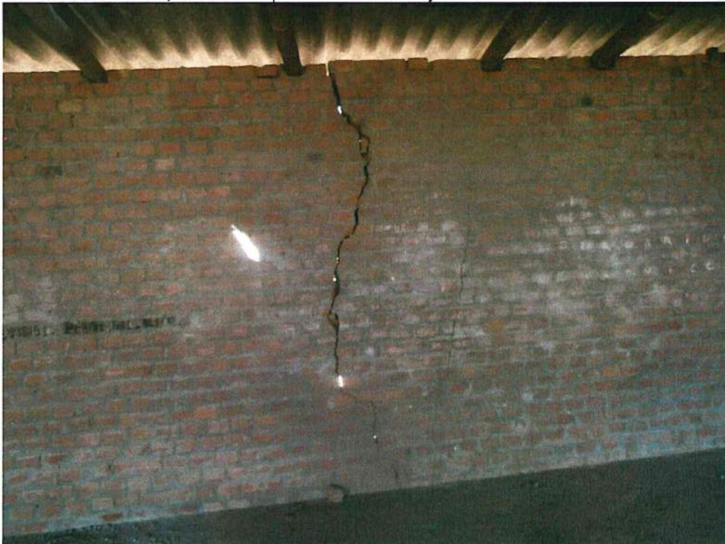
Foto N° 5, 6: Daños en paredes de concreto y ladrillo durante el FEN 2017
