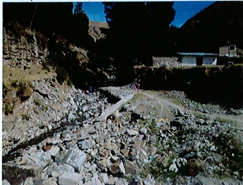
Foto 24: Cauce de la quebrada Marcohuayjo, con presencia de material gravo arenoso con bloques.
