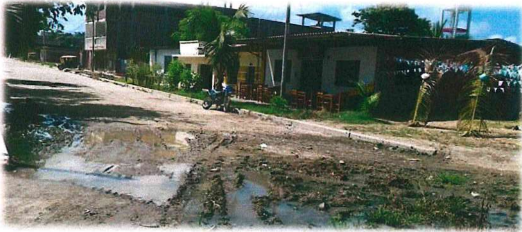
Foto N° 07, 08, 09: Vías afectadas por colapso de red de alcantarillado (Desagüe)
