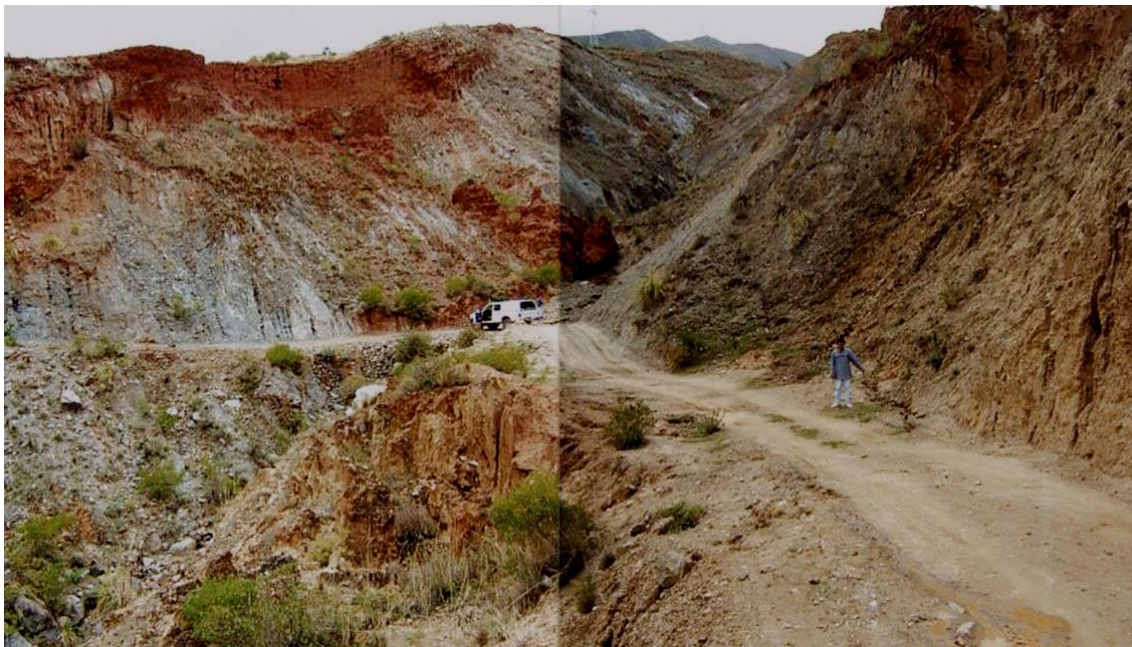
Foto N° 7 Deslizamiento que afecta tramo de la trocha hacia Rondos y Nauyán. Nótese el cabalgamiento y agrietamiento en la carretera y los asentamientos en ambas márgenes (cárcava izquierda quebrada Tingoragra-Rondos).
