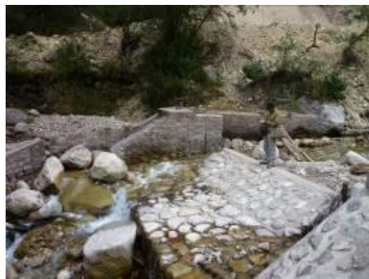
Bocatoma en el sector de Corralpampa
