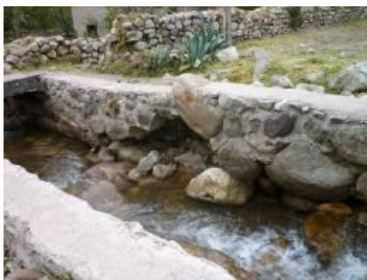
Erosión por falta de mantenimiento.
