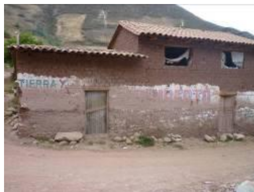
Huellas de la altura al que llegó el aluvión en vivienda adyacente del Chicón
