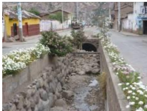
El encauzamiento es cubierto a partir del cruce con el Jr. Sagrario
