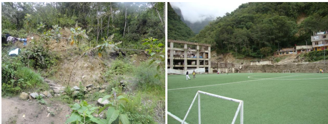
Foto 24 y 25; vista del deslizamiento originado por la acción antrópica en la zona de las Orquídeas, véase la infraestructura del centro recreacional y las viviendas las, cuales se construyeron ganándole terreno a la ladera.
