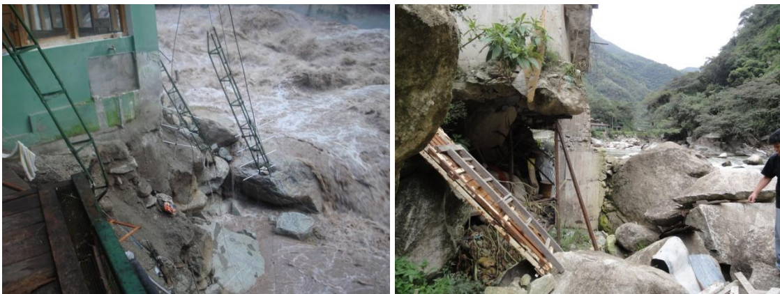
Foto 37 y 38; Vista de la socavación del talud donde se ubica el Puesto de control del SERNANP y posteriores de viviendas de la Av. Imperio de los Incas.
