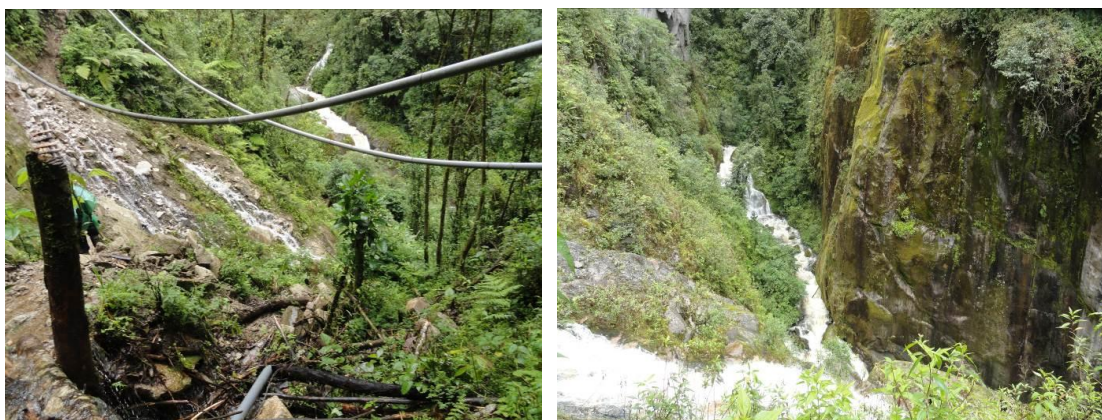
Foto 66 y 67 Deslizamiento con caída de bloques.
