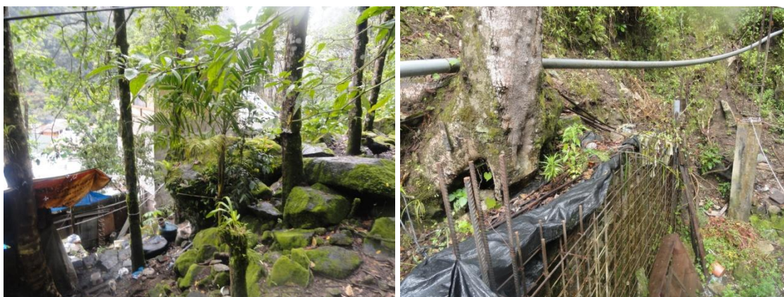
Foto 26 y 27; Izquierda, ladera del cerro Media Naranja con bolonería de roca propensa a caer hacia las viviendas ubicadas abajo, Derecha Vista de la socavación antrópica para ganar áreas de construcción.
