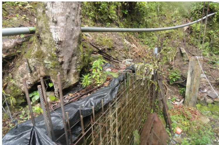
Foto 106. Socavación y construcción de viviendas en vertiente
