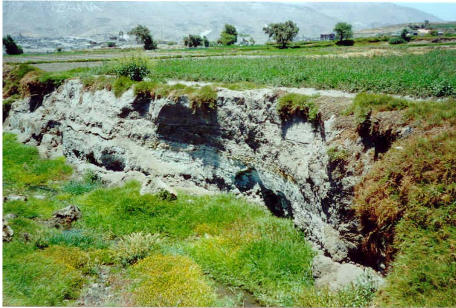
Foto 11.- Vista del sector de la torrentera Chillpinilla nótese el material paludial y el afloramiento de las aguas subterráneas
