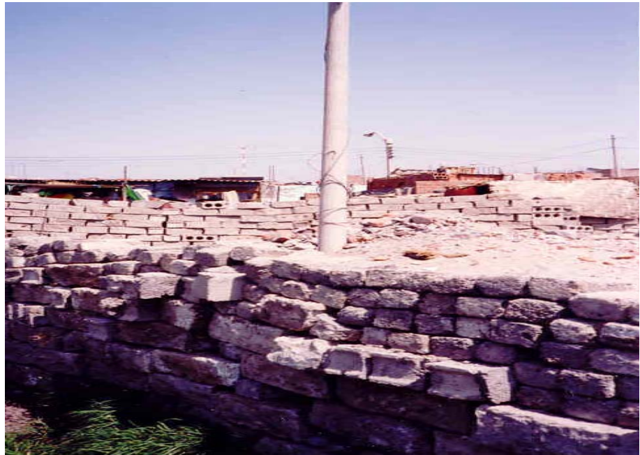
Foto 1.- Daños en viviendas Urb. Los Cristales
