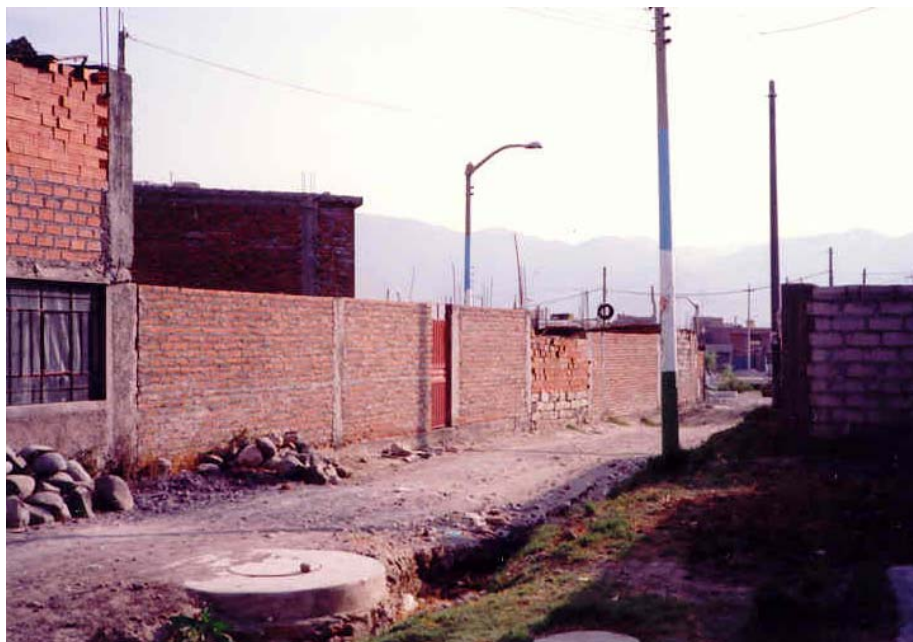
Foto 4.- Drenaje existente, sector Campo Ferial, véase poste de alumbrado publico dentro de una propiedad como consecuencia de la invasión de la zona
