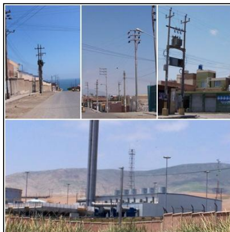
FOTO N° 57: Transmisión de Energía Eléctrica. Fuente: Trabajo de Campo.
